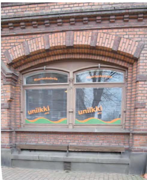
Vasemmalla: pääkonttorin myymälän ovi ja pääovi. Oikealla: ikkunapuitteet ovat paikoitellut haristuneet. Kuvassa keskellä rakennuksen tillikoristeita. Alhaalla vasemmalla: myymälän vuonna 1921 uusittu ikkuna.
