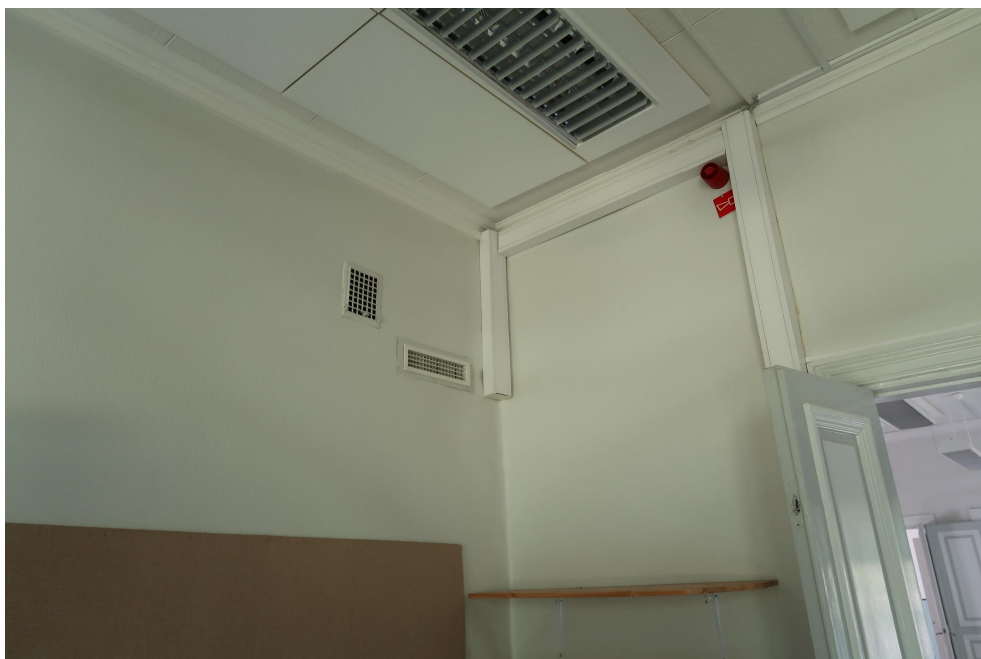
Kuva 45. Paikoin sähköjen pinta-asennuksia on peitetty suuremmilla peitelistoilla. Koneellisen ilmanvaihdon pääte-elimet on sijoitettu sattumanvaraisesti seinälle, tulo ja poisto rinnakkain.
