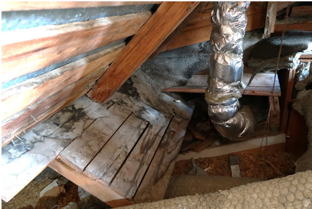
Kuva 17. Tornin vieressä uuden vesikaton alle jäänyt vanhemman vesikaton jiiri, jossa on vielä vanhaa kattohuopaa jäljellä.
