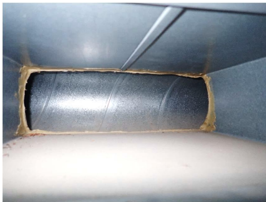
Kuva 109 a...c. Yleiskuvia yleisesti käytetystä tuloilmapäätteestä. Tuloilmasäleikön 200x100 ilmavirran säätö tapahtuu manuaalisesti säleikön takana olevan säädettävän säätöosan avulla. Päätelaitteet on kanavoitu suorakaidekanavalla pyöreään kierresau- makanavaan.
