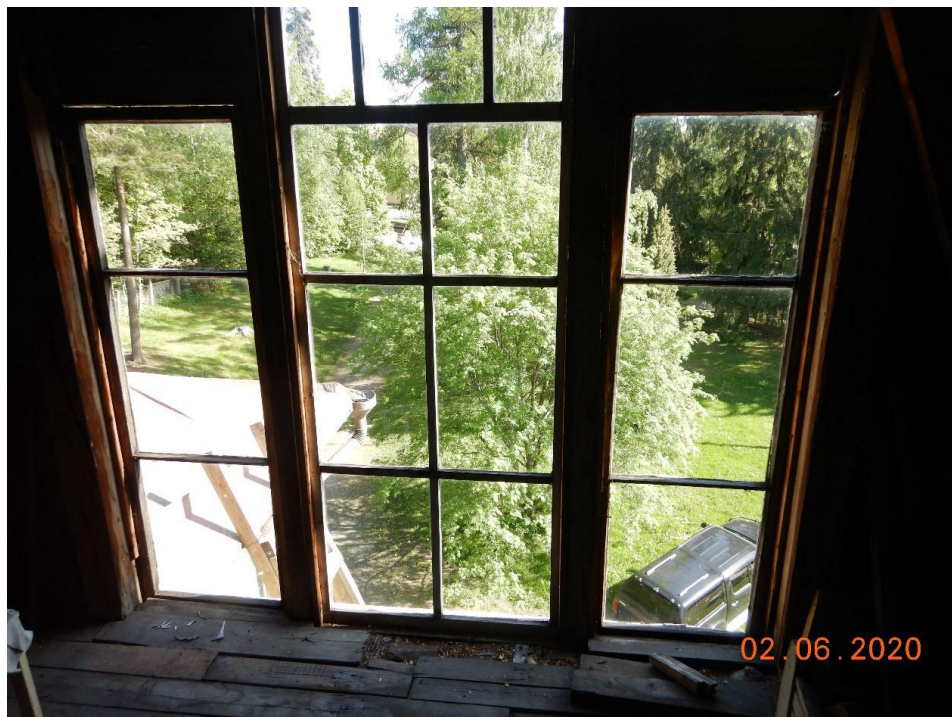
Kuva 84. Torniosalla ikkuna on asennettu yläpohjan yläpinnan laudoituksen tasoon. Ikkunan alapuitteet ovat ikääntyneet ja ikkunaliittymissä on vesitiiveyspuutteita. Sadevesi voi päästä yläpohjarakenteisiin epätiiviyden ikkunaliittymien kautta.
