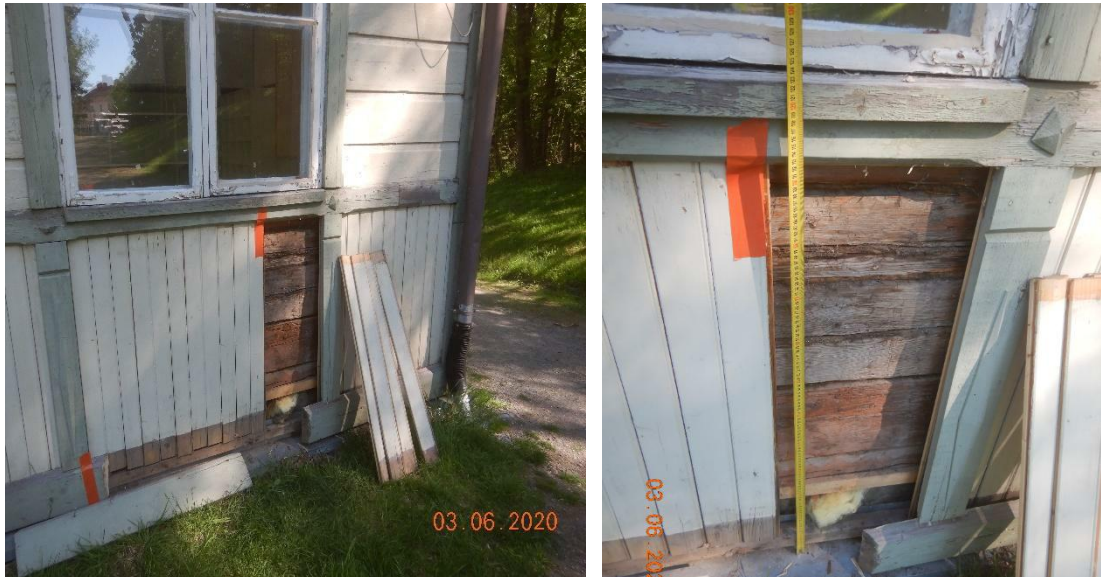
Kuvat 56 a ja b. Rakennus RAUS1 tehtiin tilan 125 ulkoseinään. Avauksesta havaittiin lahoa ja hyönteisvaurioita kahdessa alimmassa hirressä. Vauriot ovat edenneet pidemmällä hirren ulkoseinän sisäpinnassa. Ulkoseinän alin hirsi on poistettu ja tilalle on asennettu 150 mm leveitä puupölkkyjä, jotka kannattelevat yläpuolella olevaa ulkoseinähirttä. Puupölkkyjen välissä poistetun ulkoseinähirren tilalla on eristevillaa.
