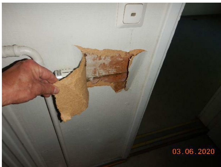
Kuva 72. Hirsiväliseinien toteutustapa tarkastettiin tilasta 112 seinäpinnan revenneen pahvin takaa. Hirsien tilkkeenä on käytetty pellavarivettä.
