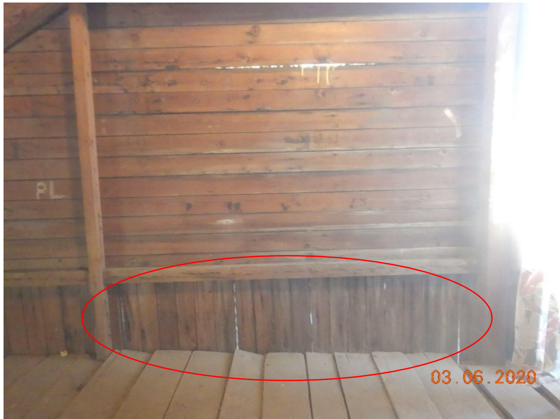
Kuva 94. Erityisesti ullakon ulkoseinien alaosissa pystysuuntaisessa paneloinnissa on kosteusjälkiä ja viistosateelle altistuvia kohtia, joista sadevesi pääsee myös yläpohjan eristetilaan. Seinässä on yksikerroksinen laudoitus.
