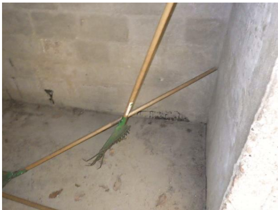
Kuva 11. Tilan 001 alapohjajaliittymässä ja seinäosilla havaittiin bitumiroiskeita.
