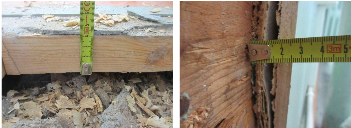
Kuva 33. Alapohjan pintarakenteissa (laudoitus, tasoite, linoleum) ei havaittu vaurioita (kuva a). Hirsiseinän sisäpinnassa on pinkopahvi ja lastulevy (kuva b). Pinkopahvissa havaittiin kosteusjälkiä.
