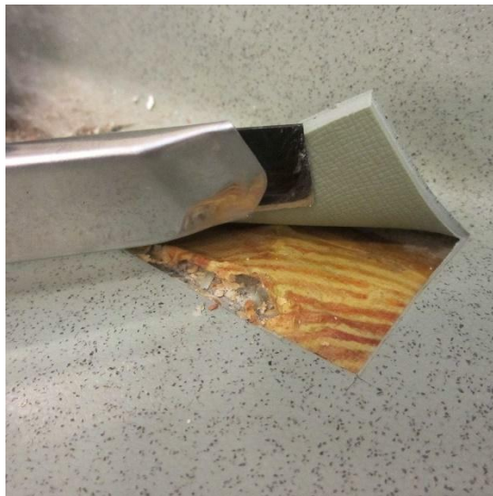
Kuva 36. V1: Liima vaurioitunut. Mikrobi-peräinen haju. Muovimatto irti alustastaan.
