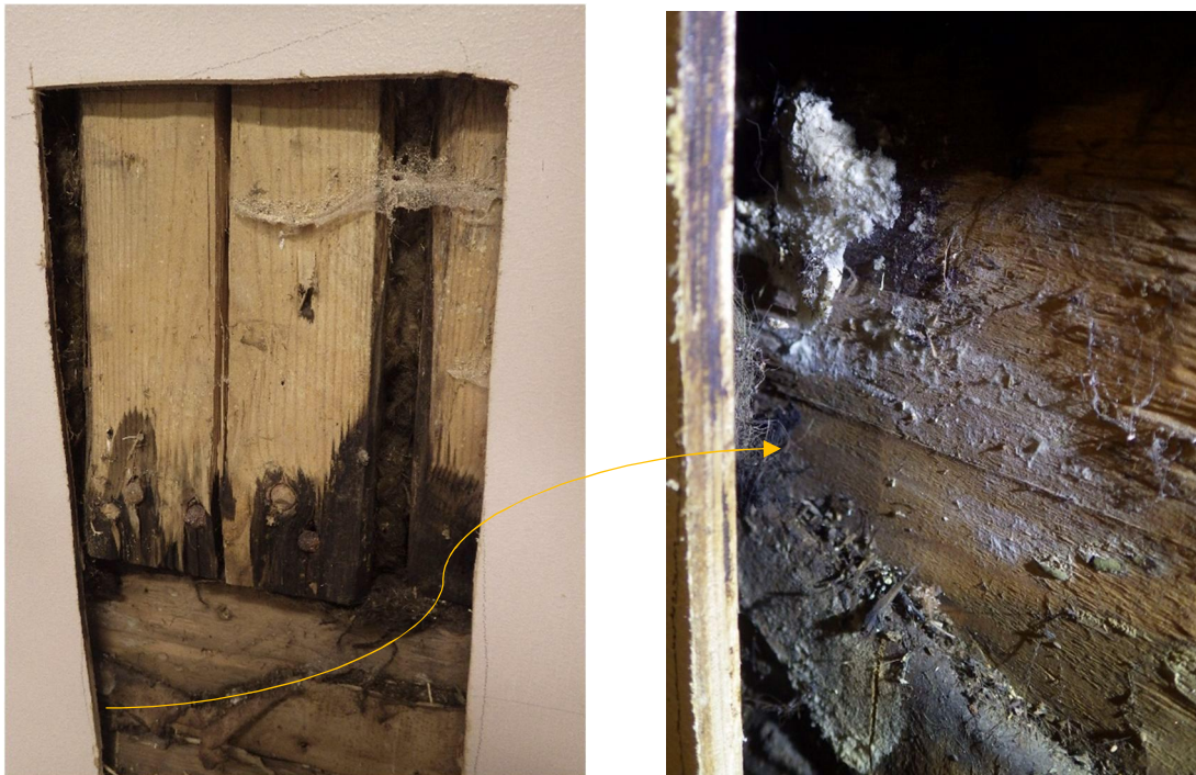
Kuva 68. a. RAUS7:stä havaittiin, että pohjoisseinustaa on korjattu aiemminkin vaihtamalla vaakahirsirakenne pystyhirsirakenteeksi paikallisesti. Pystyhirsien välissä oli riittävä tilkkeenä, mutta hirsien välit eivät olleet tiiviit, vaan niistä oli selkeä, kylmä ilmavirta. b. Seinän sisäpinnalla vanerin alla havaittiin paikallinen kasvusto.
