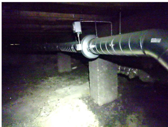
Kuva 102. Kellarin ryömintätilassa on erillinen kanavistoon asennettu poistoilmapuhallin.
