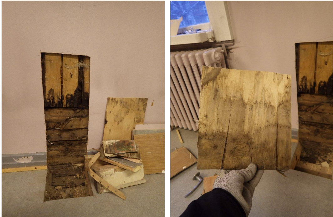
Kuva 55. a. Sama kohta salin puolelta, jossa pohjoisseinustalla sadevedet ohjautuvat räystäältä ulkoseinustalle. Seinää on jo aiemmin korjattu ja osittain uusittu pystyhirsirakenteena. Rakennus RAUS7. b. Seinän sisäpinnan vanerin takapinnassa on selkeitä kosteusjälkiä.
