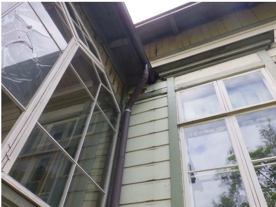
Kuva 54. Pohjoisseinustalla sadevedet ohjautuvat räystäältä ulkoseinustalle. Seinän ulkopinnassa on kosteusjälkiä ja räystään alapuolella laudoituksessa on kosteusvaurio. Pohjoisseinustalla ikkunat olivat pääosin paremmassa kunnossa kuin muilla seinäosuuksilla. Muutaman ikkunan lasitukset ovat rikkoutuneet.
