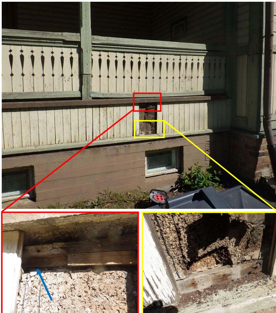
Kuvat 59 a...c. Rakennus RAUS3 tehtiin rakennuksen eteläiselle tilan 130 ulko-seinään katoksen lattian alla olevan yläpohjarakenteen tasolle. Puupaneloinnin takana on 25 mm paksu korkkilevy betoniseinää vasten. Betonia vasten olevat puurakenteet ovat paikoin lahonneita. Sadevedet kulkeutuvat vesipenkin päältä osittain seinäraken-teen sisempiin rakenteisiin. Katoksen betonilaatan alla on ilmaväli ja kevytsoraa. Ala-laatan yläpinnassa on vedeneristekermi, joka erottuu kuvasta huonosti (merkitty sini-sellä nuolella).
