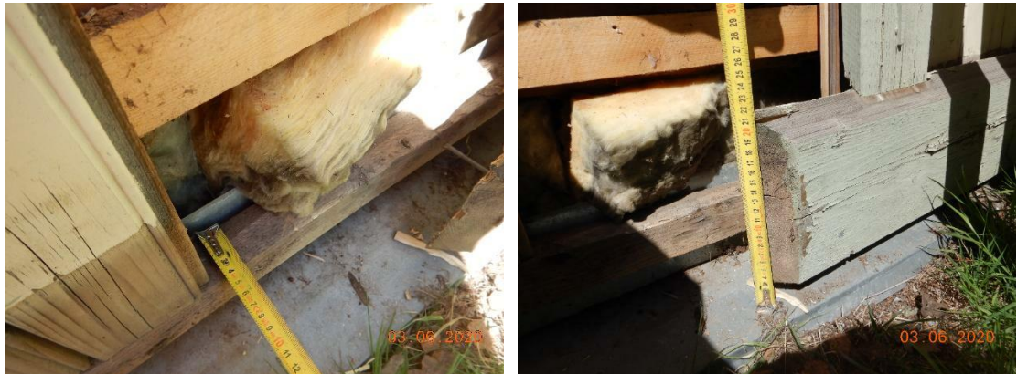
Kuva 57. Kivisokkelin päällä maanpinnan tasossa on pellitys, joka on käännetty n. 10 cm ylös ulkoseinäpanelöinnin taakse. Korjatun hirsiseinän alaosassa on eristevilla-kaista. Villaeristeissä havaittiin ilmavuotojen aiheuttamaa tummentumaa. Maanpinta on paikallisesti sokkelin tasossa mikä altistaa ulkoseinän alaosat sade- ja sulamisvesille.
