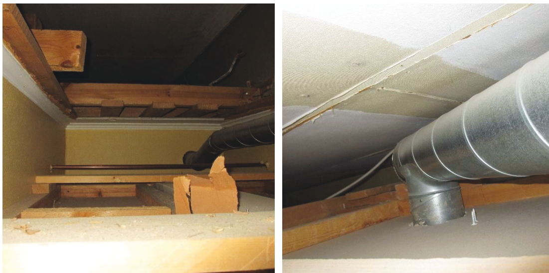
Kuva 49 a...b 1. kerroksen alaslasketuissa katoissa havaittiin epätiivittä läpivientejä tilojen välillä. Vanhoissa pintamateriaaleissa ei havaittu vaurioita.
