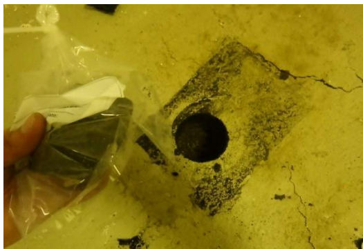
Kuva 26. Rakenneavaus (50 mm) RAAP5 tehtiin talouskellarin lattiaan. Alapohjarakenne on n. 70 mm paksu valuasfaltti, jonka alla on soraa. Valuasfaltista lähtevä PAH-pitoisuus on aistittavissa laajalla alueella kellaritiloissa.
