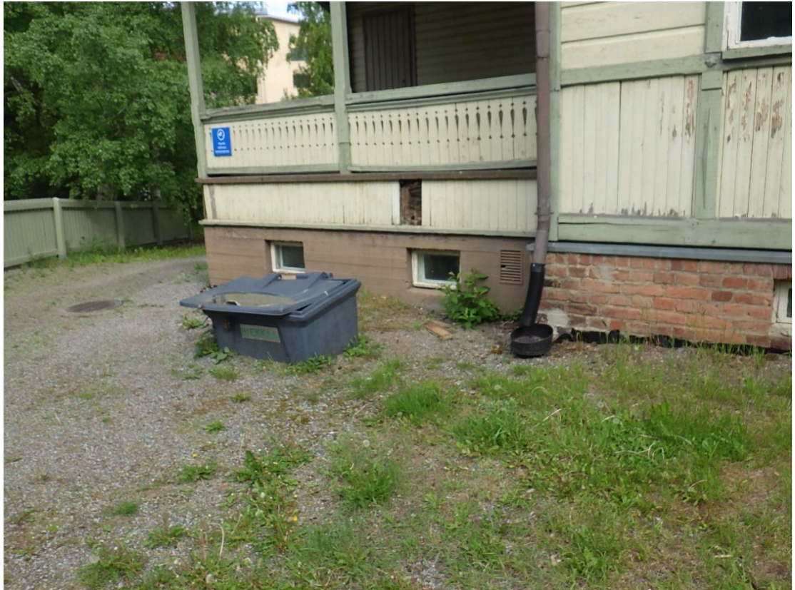
Kuva 3. Tiilisokkeliä vasten on asennettu paikoin pato levytys. Eteläisellä sivulla pato-levytystä ei ole kiinnitetty seinään. Maanvastaisten seinien kosteusteknistä toimintaa on esitetty tarkemmin kappaleessa 5. Patolevytetyt maanvastaaiset seinät on esitetty kappaleessa 5 kuvassa (Kuva 5).
