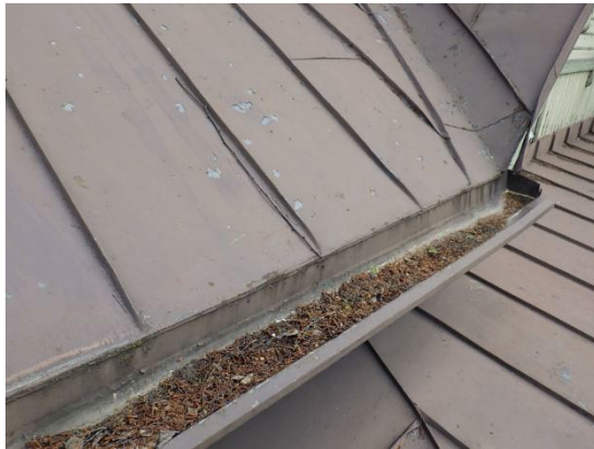
Kuva 86. Rästaskouruissa on paikoin runsaasti lehtiroskia. Jalkarännit olivat tutkimuksen yhteydessä puhtaat.
