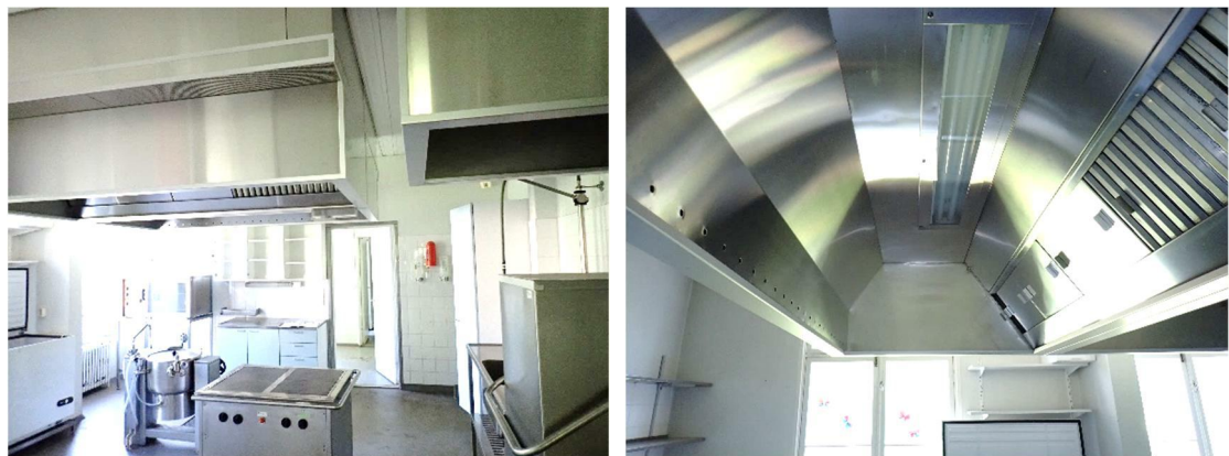
Kuva 108 a ja b. Keittiön huuvat (rasva- ja kondenssihuuva) ovat silmämääräisesti arvioituna uudempia, asennusajankohta ei ole tiedossa.
