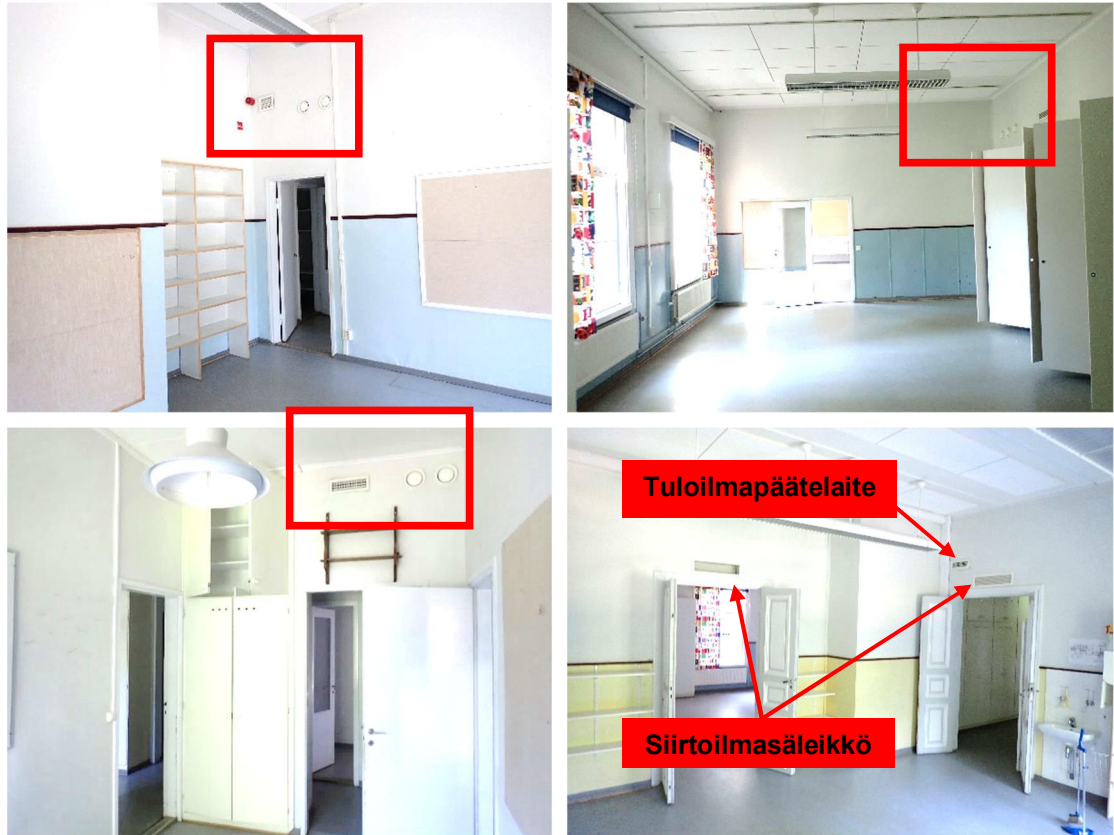
Kuva 107 a...d. Yleiskuvia päätelaitteiden sijoituksista tiloissa (korostettu punaisella). Tulo- ja poistoilmapäätelaitteita on sijoitettu pääosin vain yhdelle seinäpinnalle. Päätelaitteet ovat pääosin lähekkäin. Osassa tiloista on vain seinäpinnalle asennetut tuloilmasäleiköt ja ovien yläpuolella sijaitsevat siirtoilmasäleiköt. Tiloissa on tavanomaista suurempi huonekorkeus.
