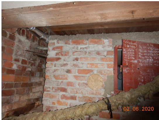
Kuva 25. Ryömintätilassa on vanha tiilirakenteinen öljysäiliötila. Tilaan ei ole kuvassa näkyvän luukun lisäksi muuta kulkua. Öljysäiliötilan rakenteissa on todennäköisesti jäteöljyjäämiä.
