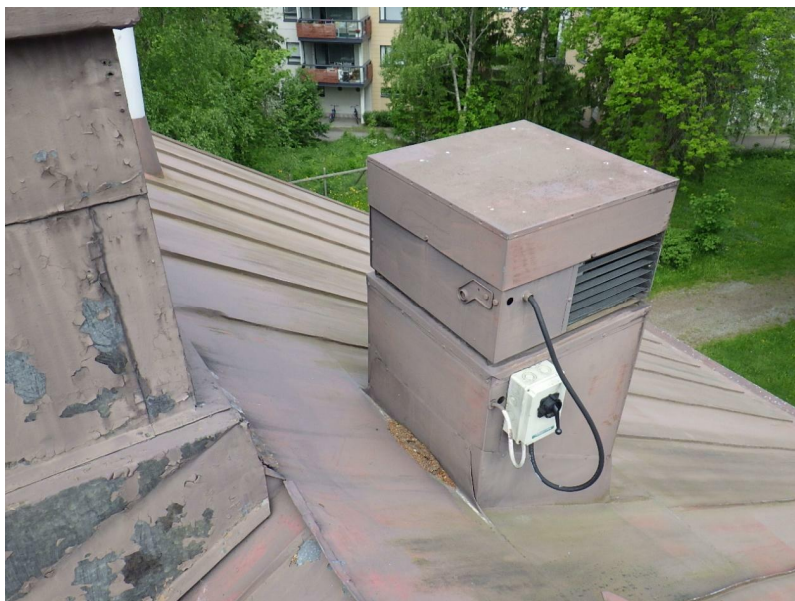
Kuva 88. Piipun pellitykset ovat huonokuntoiset ja maali irtailee monin paikoin. IV-laitteiden läpiviennissä ei ole sivuttaissuuntaisia vastakallistuksia. Kuvassa esiintyvissä läpiviennissä ei ole lainkaan vastakallistuksia. IV-puhaltimelle ei ole asianmukaista kulkureittiä.
