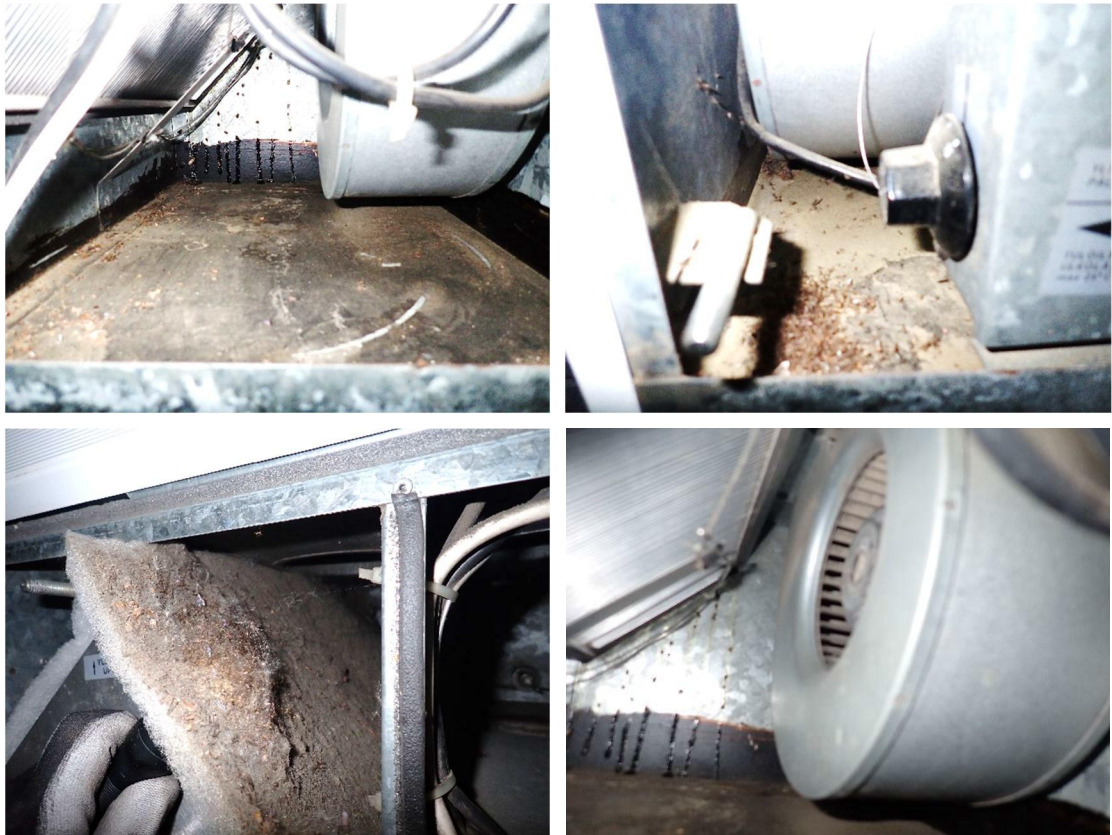
Kuva 99 a...d. Yleiskuvia MUH-Ilmava iv-koneiden sisältä. Kaikki tarkastetut iv-koneet ovat likaisia (pöly, hienojakoinen kiviaines, hyönteiset) ja niiden kammioissa havaittiin oletettavasti vesieristeeseen viittaava sively. Koneiden suodattimet olivat epäpuhtaita ja aistinvaraisesti tarkasteltuna kaikkien iv-koneiden (6 kpl) puhaltimien laakerit ovat heikkokuntoisia.
