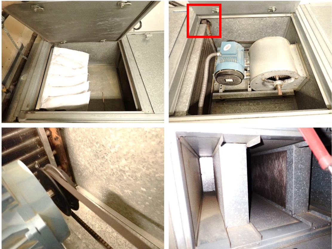
Kuva 101 a...d. Yleiskuvia Stratos-Ilmastointi merkkisestä tuloilmakoneesta. Suodatin-osa on epätiivis ja koneen sisäosat sekä lämmityspatteri ovat likaiset. Puhallinkammiossa on tiivistämätön läpivienti (b kuva, merkattu punaisella), jossa havaittiin avoimia mineraalivillapintoja. Puhallintekniikka on ikääntynyttä ja moottorin säädettävän hihnapyörän säätövara alkaa olla lopussa. Koneen äänenvaimennusosa on likainen ja vaimenninkaseteissa on avoimia villapintoja.
