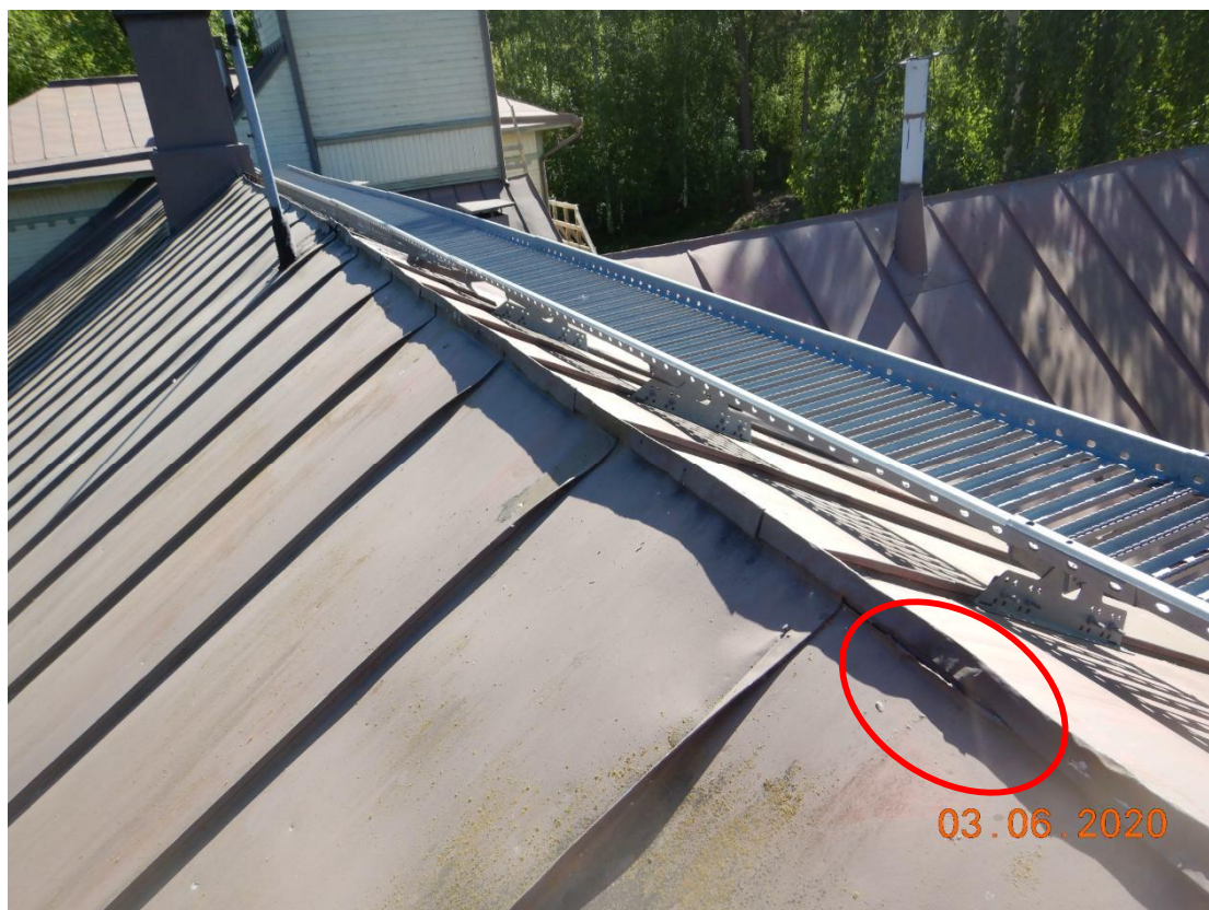
Kuva 85. Vesikaton harjan saumassa on vesitiiveyspuutteita. Sauma on paikoin lytysä ja avoin (ympyröity punaisella). Kulkusilta on kiinnitetty asianmukaisesti peltikatteeseen konesaumakohtiin.
