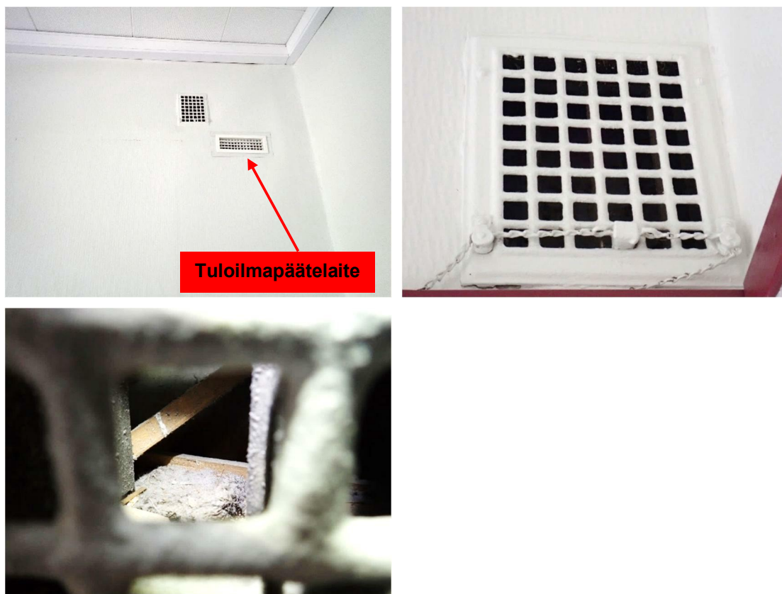
Kuva 111 a... c. Osassa tiloista havaittiin painovoimaisen ilmanvaihdon hormisäleikköjä. Tarkastelluilta osin säleiköt olivat avoimia ja niissä havaittiin pölyä, rakennusjätettä ym.
