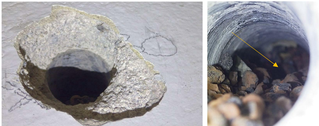
Kuvat 65 a ja b. Rakenteen pinnassa on paksu laastikerros ennen betonia. Kuvassa b nuolella merkitty muottilauta tai vastaava rakenne.
