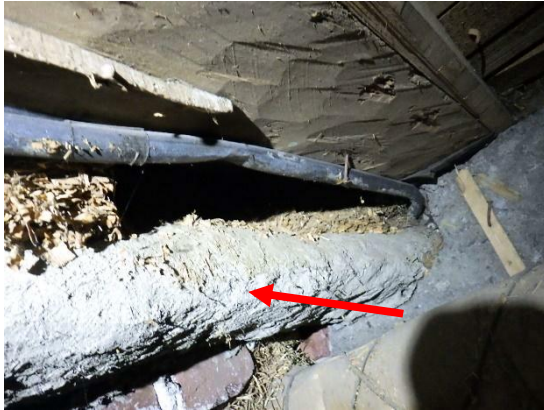
Kuva 21. Alapohjassa havaittiin asbestipitoisia putkieristeitä (HA3). Putkieristeet ovat paikoin rikkoutuneita. Asbestipitoisia eristepaloja on varissut myös maahan. Asbestipitoinen eriste on osoitettu kuvassa punaisella nuolella.
