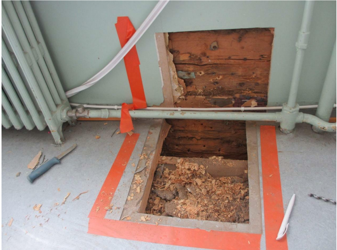
Kuvat 31 a ja b. Rakennus RAAP2 tehtiin tilaan 125 ulkoseinän ja alapohjan liittymään. Alapohjan koolaus on asennettu n. 15 cm irti ulkoseinästä. Koolauksen ja hirsiseinän välissä on eristevillakaista, joka on tummunut.
