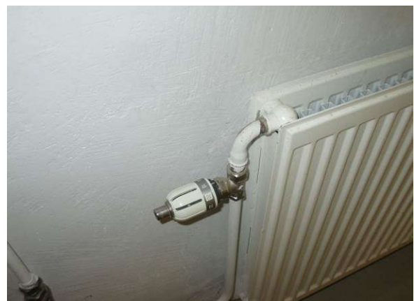
Patteriventtiilit ovat 1990-luvun alkupuolen aikaisia asennuksia
