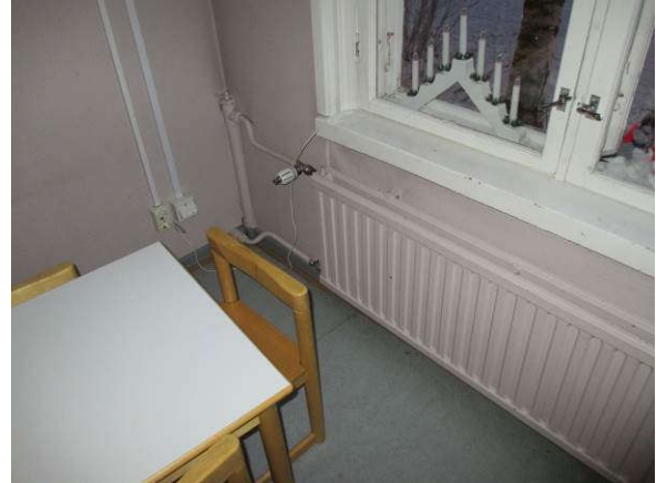
...sekä myöhemmin uusittuja teräslevypattereita
