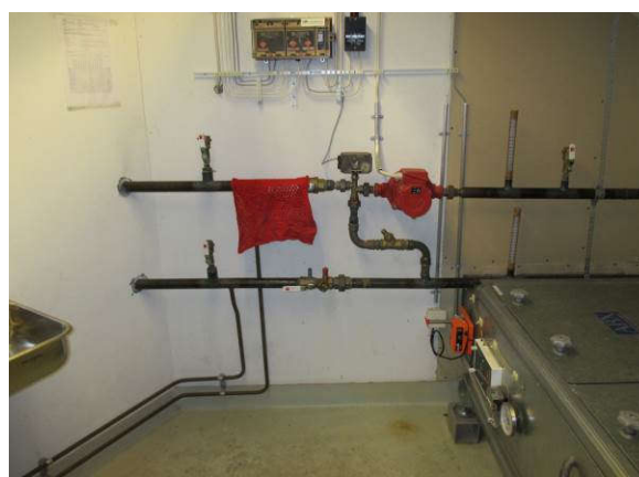
Keittiön tuloilmakoneessa on vesikiertoon kytketty lämmityspatteri
