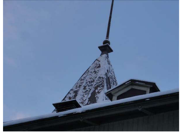
Tornin katteessa havaittiin huoltomaalauksen tarvetta maantasosta tarkasteltuna.
