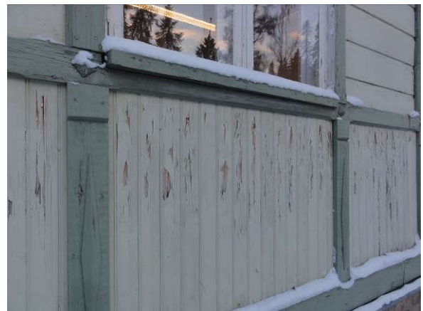
Huoltomaalauksen tarvetta ulkoverhouksessa.
