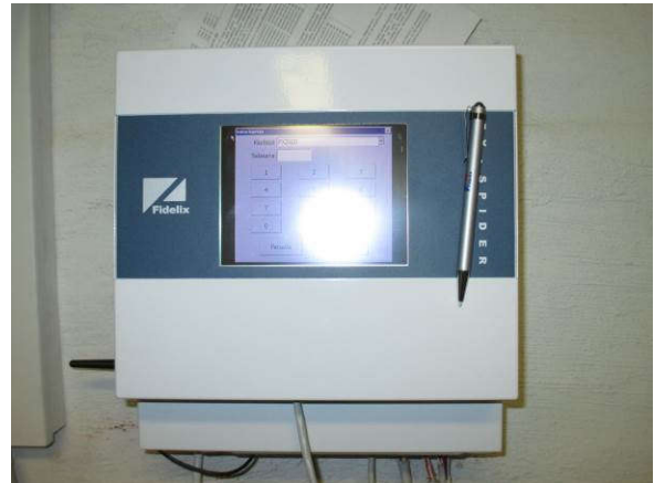
Rakennusautomaatiojärjestelmänä on Fidelix
