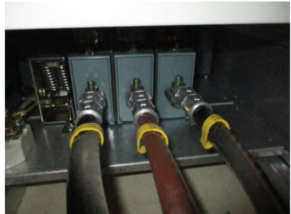
Pääkytkin, johon liittymisjohto on liitetty.
