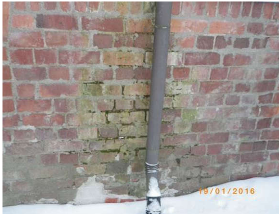
Kellarikerroksen seinissä on ulkopuolella tiiliverhous. Paikallista huollon tarvetta havaittavissa.
