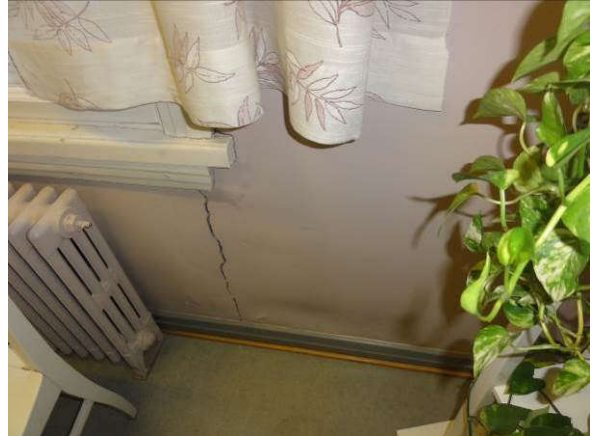
Paikallisia kulumia ja vaurioita oli sisätilojen pintarakenteissa havaittavissa.
