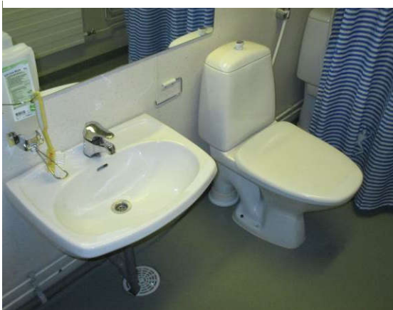
Vesi- ja viemärikalusteet ovat tyydyttävässä kunnossa
