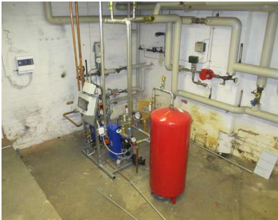
Lämmönsiirrinpaketti on hyvässä kunnossa
