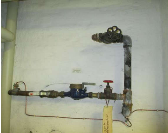
Vesimittari on lämmönjakohuoneessa
