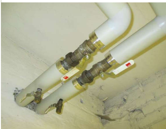
Lämpöjohdot ovat perinteisiä teräsputkiasennuksia, linjaventtiilit ovat hyväkuntoisia
