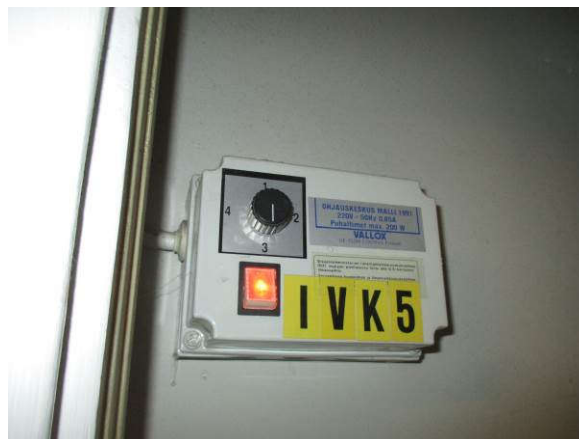
Ilmanvaihtokoneita ohjataan paikallisesti koneiden omista ohjauskeskuksista
