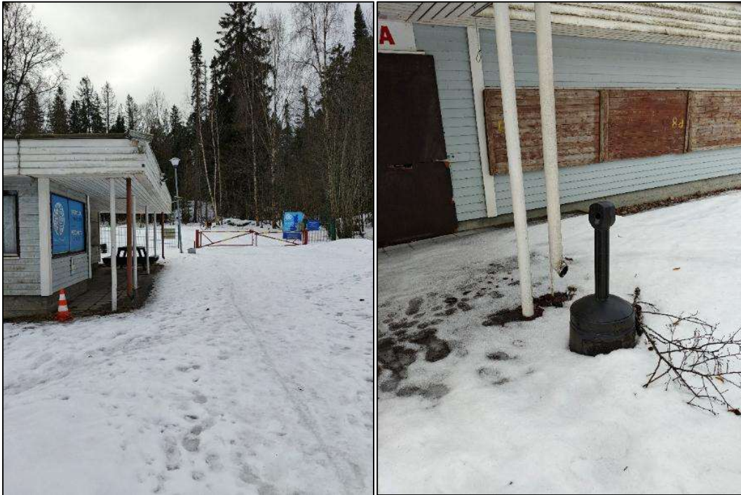
Kuva 5 Rakennusten kattovedet johdettu rännejä pitkin maastoon (maastokäynti 4.3.2026)
