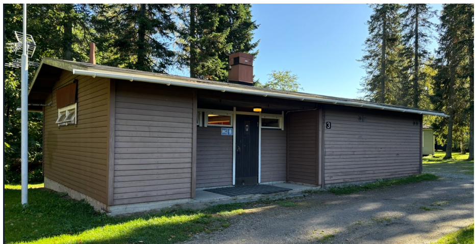
Kuva 24. Vanhemmat huoltorakennukset ovat käytössä, mutta huonokuntoisia, eivätkä todennäköisesti sovi talvikäyttöön
