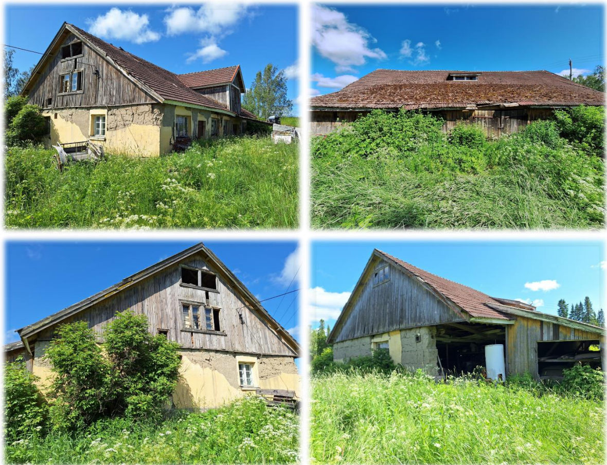
Kuva 10. Ylhäällä vas. näkymä Nurmintieltä, ylhäällä oik. suuri tiilikatto nähtynä rakennuksen länsipuolelta, alhaalla vas. rakennuksen puoli, jossa kiviperusta ja puinen yläosa, alhaalla oik. rakennuksen luoteispuoli, jossa osittain puuttuva seinä.
