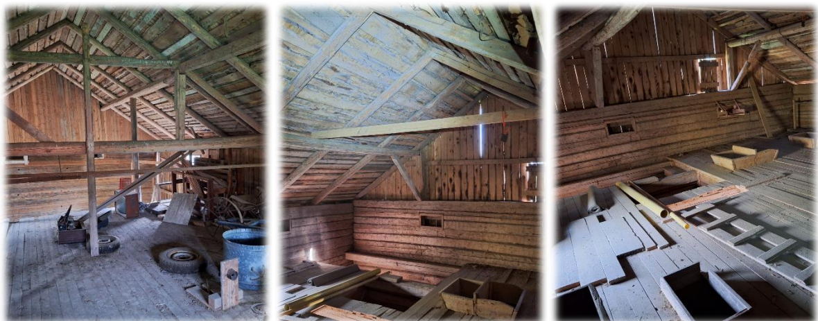
Kuva 5 Vasemmanpuoleinen kuva esittää rakennuksen länsiosan sisätilaa, joka toimii varastona, ja kaksi muuta kuvaa näyttävät rakennuksen itäosan juuri katon alapuolella sijaitsevan vanhan viljavaraston.
