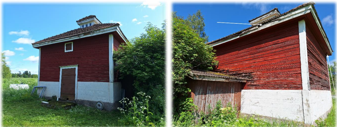
Kuva 7. Vasemmalla varistorakennuksen sisäänkäynti ja oikealla varistorakennuksen länsipuoli, jonka vieressä on huussi, valkoista nuolta osoittavat katon alla olevia koloja.
