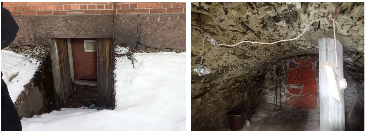
Kuva 8. Lepakoiden kannalta potentiaalinen talvehtimispaikka alueella on navetan maakellari, mutta huonosti kiinni menevän oven vuoksi myös kellari on lepakoiden talvehtimispaikaksi nykyisellään kovien pakkasten aikaan liian kylmä.
