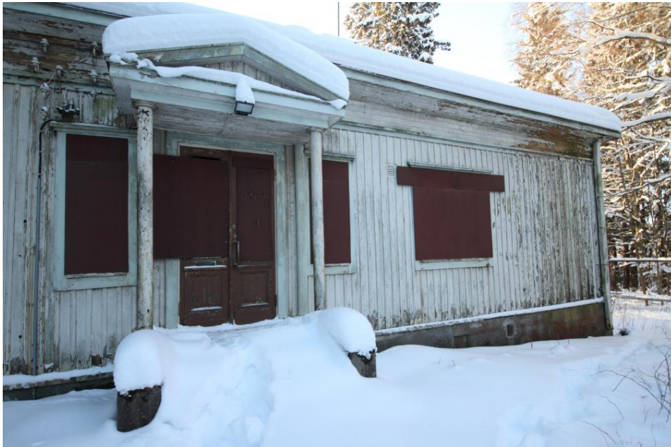
Kuva 58. Asuinrakennuksen pohjoisjulkisivu. Kuvassa näkyy klassistinen avokuisti sisäänkäynnin edustalla sekä rakennuslevyillä peitetyt ikkunat. Betoniportaikko jää lumen alle piiloon, samoin vesikatteen materiaali.
