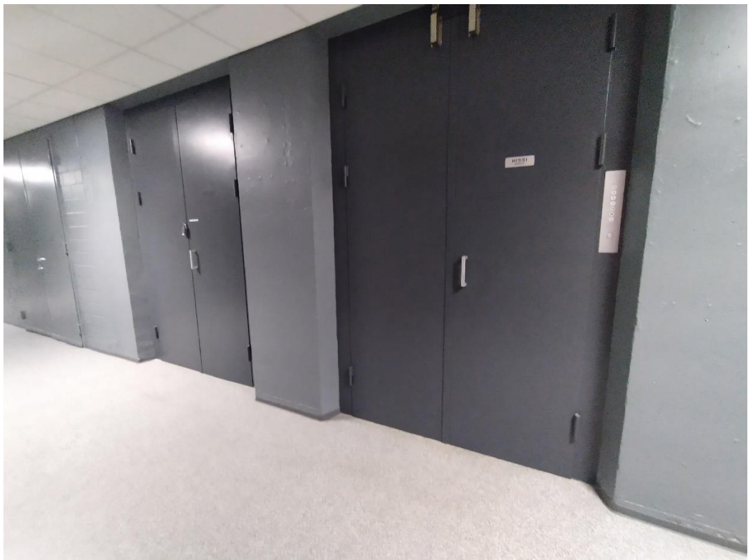
Kuva 56 Saneerattua käytävätilaa ja maalattuja ovia. Kuva Anniina Grönholm 2021 ARCO Architecture Company Oy
