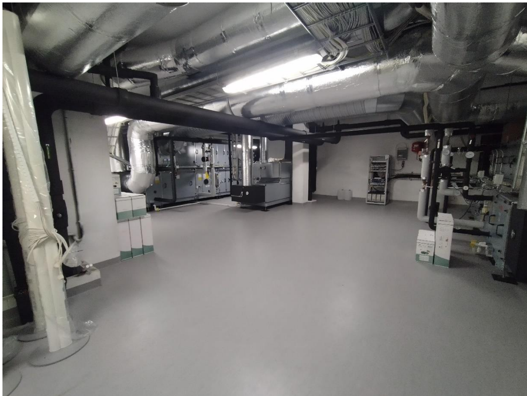
Kuva 63 Rakennuksen talotekniikka on uusittu. Kuva Anniina Grönholm 2021 ARCO Architecture Company Oy
