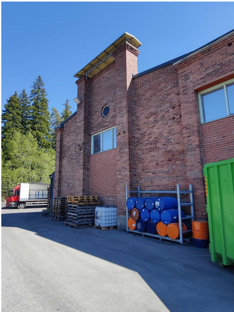
Kuva 50 Kantatehtaan vuosina 1960 rakennetun laajennuksen päätyjulkisivu. Päätyjulkisivun ikkunan pienennys erottuu vaaleampana tiilimuurauksena ikku-nan alapuolella.
