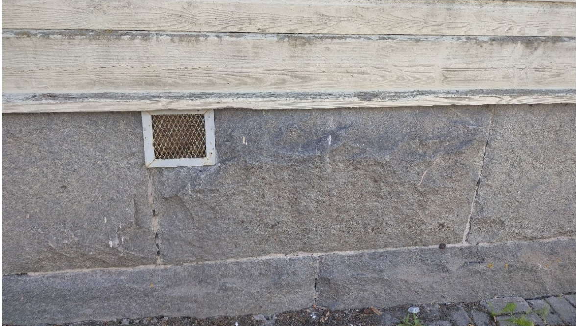
Kuva 14. Kivijalat ja tuuletusritilät ovat tiiviit molemmissa koulurakennuksessa, jotka tarkistettiin.
