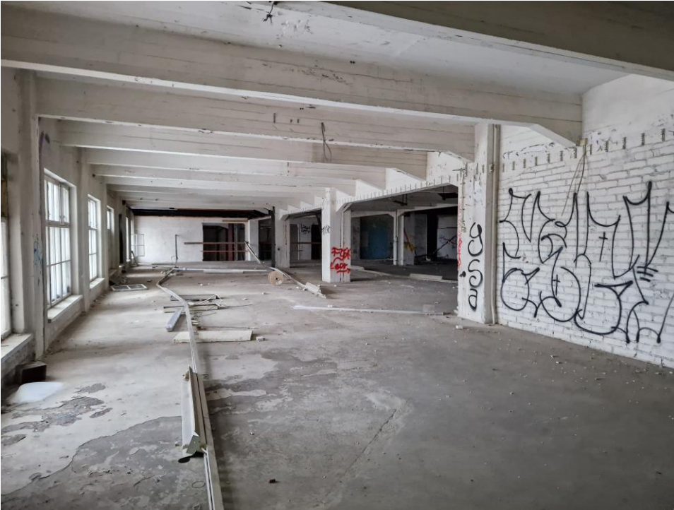
Kuva 3. Toisen kerroksen hallitilaa. Kattorakenteissa ei ollut juuri lepakoille sopivia koloja. Osa ikkunalaseista oli auki tai rikki.
