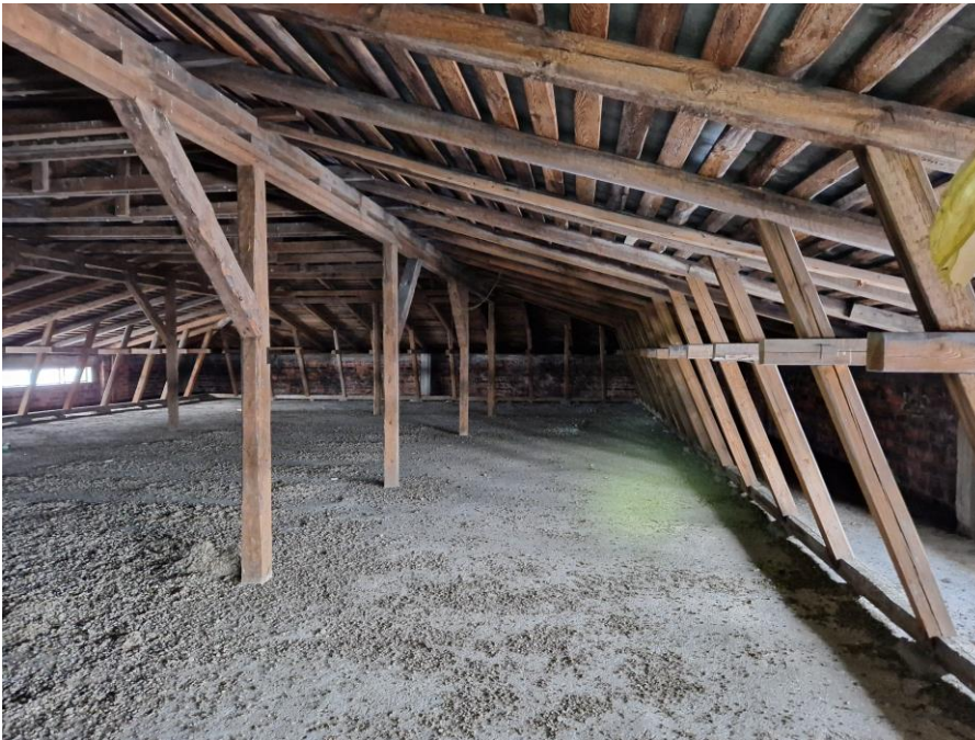
Kuva 9. Rakennuksen ullakolla oli runsaasti pulujen ulostetta sekä kuolleita puluja. Linnut pääsevät lentämään rakennukseen rikkinäisistä ullakon ikkunoista ja avoimesta kattoluukusta. Näitä ikkunoita ja luukkua myös lepakot voisivat halutessaan käyttää. Seinissä ei ollut muita aukkoja, joista lepakot voisivat lentää rakennukseen.
