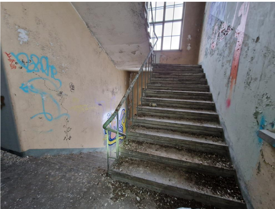
Kuva 4. Rakennuksen luoteispäädyn rappukäytävää. Rakennuksessa oli runsaasti merkkejä sekä pulujen että ihmisten oleilusta.
