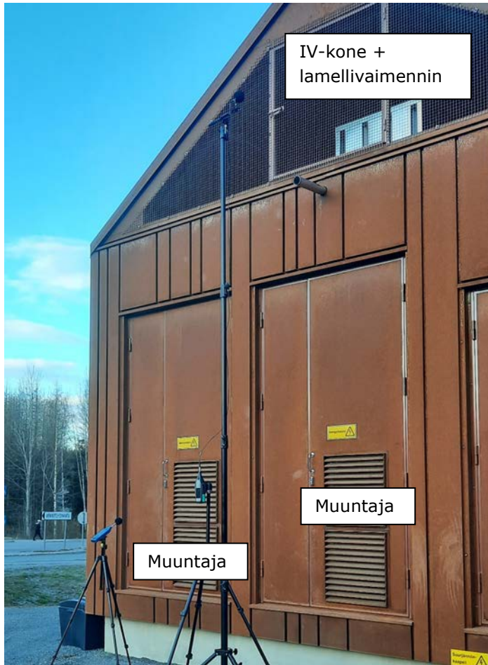
Kuva 8. Sähkönsyöttöasemien melulähteitä ovat muuntajien ja IV-koneen ilmanotto-aukot
