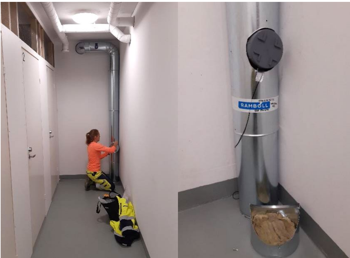
Kuvat 9a+b. Radonputkiston poistoputki kerrostalon kellarikerroksessa.
