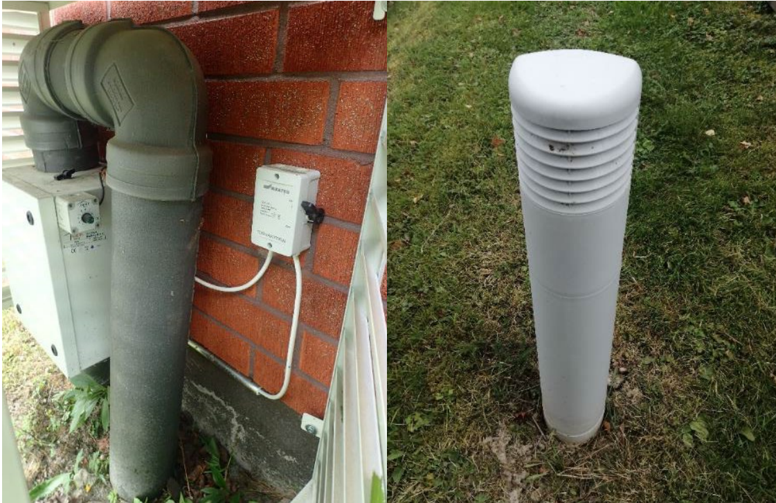
Kuvat 13a+b. Esimerkki radonkaivosta (oik. kuva poistoilmaputkesta).
