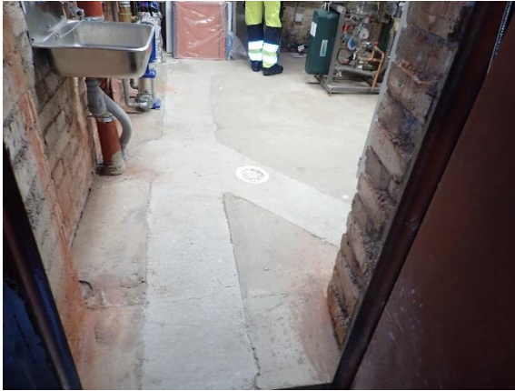
Kuva 15 Kuvassa maanvaraisen betonilaatan halkeilua ja vanhoja viemäriroilouksia.
