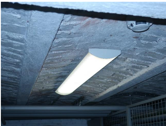
Kuva 71 Yleiskuva lämmönjakohuoneen valaisimesta.
