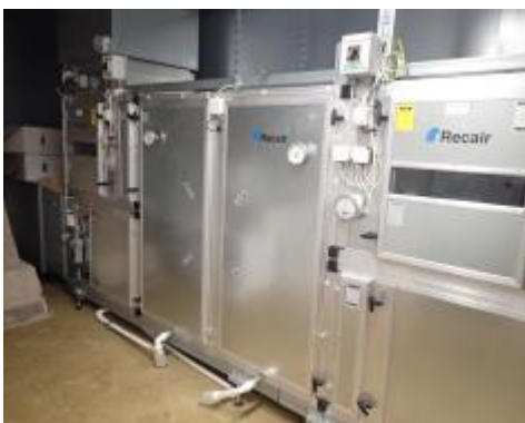
Kuva 52 Pääilmanvaihtokone TK1 ullakon IV-konehuoneessa.
