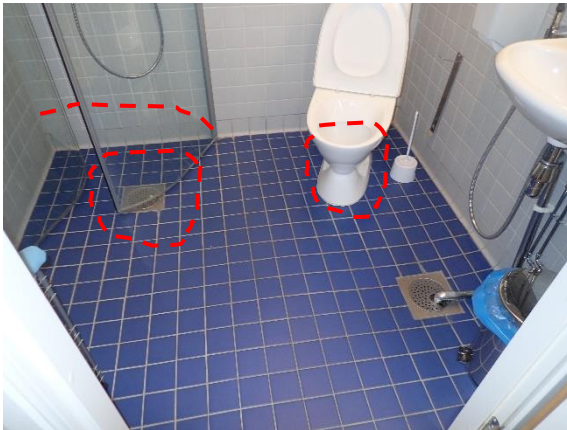
Kuva 30 Alakerran pesuhuoneen lattiassa ja suihkuseinän alaosassa havaittiin viitteitä poikkeavasta kosteudesta.
