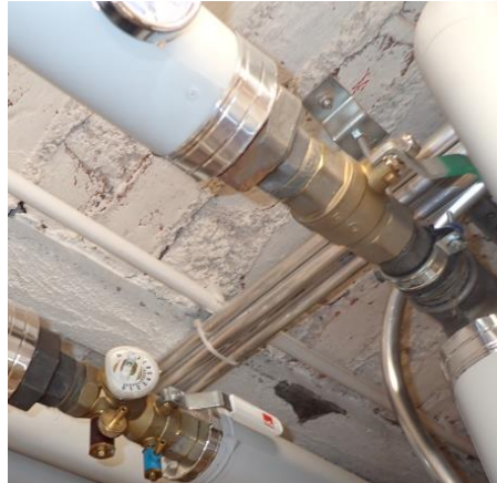
Kuva 39 Lämmitysverkoston linjasäätö- ja sulkuventtiilit
