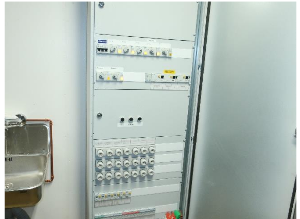
Kuva 66 Yleiskuva iv-konehuoneen ryhmäkeskuksesta.
