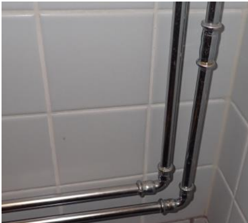
Kuva 45 Kromatuilla kupariputkilla puristusliitoksin toteutettuja vesijohtoja.
