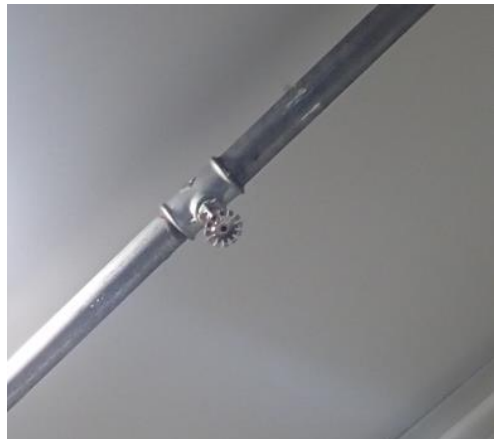
Kuva 58 Sprinkleriputki ja suutin.
