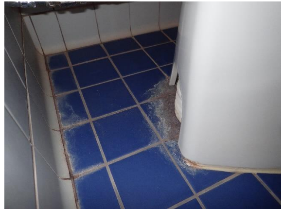
Kuva 31 Alakerran pesuhuoneen laatta-saumoissa havaittiin voimakasta tummumista.
