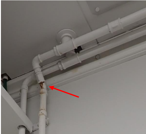
Kuva 38 Lämpöjohton liitososassa 1. kerroksessa korrosiojälkiä ilmeisesti vanhan vuodon seurauksena
