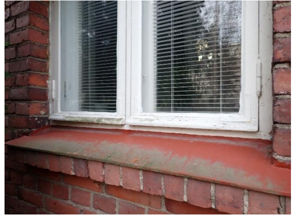
Kuva 23 Ulkopuitteiden maalipinta on paikoitellen heikko ja irtoilee alustastaan.
