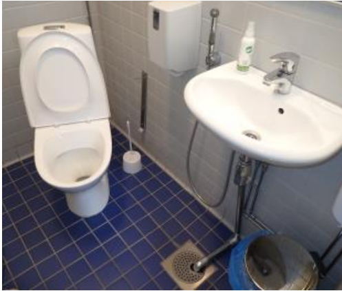
Kuva 50 Vesi- ja viemärikalusteita.
