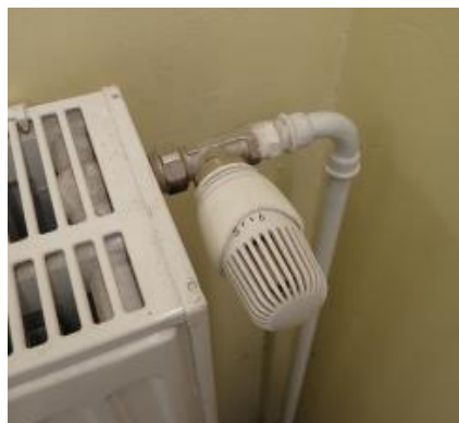
Kuva 41 Patteriventtiilit ja termostaatit ovat vuodelta 2012.
