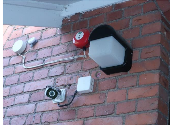
Kuva 74 Yleiskuva ulkoseinän valaisimesta.
