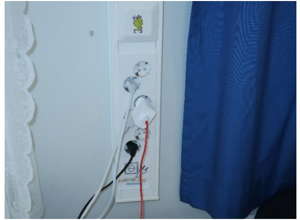
Kuva 62 Yleiskuva asiakashuoneen johtokanavasta.
