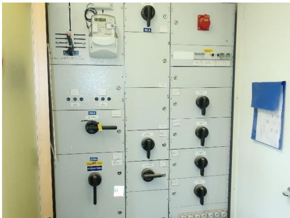
Kuva 63 Yleiskuva pääkeskuksesta PK01.
