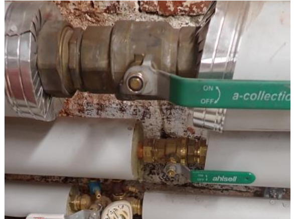
Kuva 44 Eristettyjä käyttövesiputkia ja venttiilejä lämmönjakohuoneessa.
