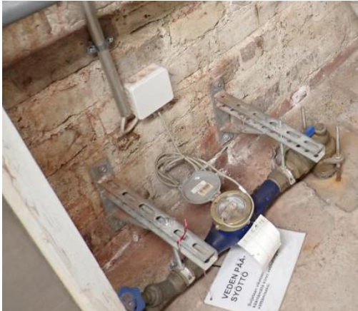
Kuva 43 Käyttöveden tonttivesijohdon ylönsuukohta, päävesimittari ja pääsulku lämmönjakohuoneessa.
