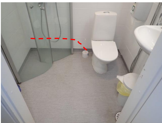
Kuva 32 Yläkerran pesuhuoneen suihkuseinän alaosassa havaittiin viitteitä poikkeavasta kosteudesta.
