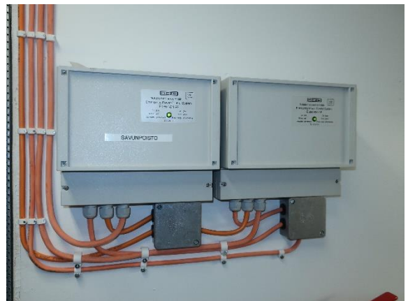
Kuva 84 Yleiskuva savunpoistoikkunoiden laukaisukeskuksesta.
