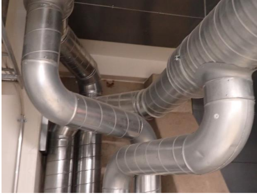
Kuva 54 Saneerauksen yhteydessä asennettuja ilmanvaihtokanavia.
