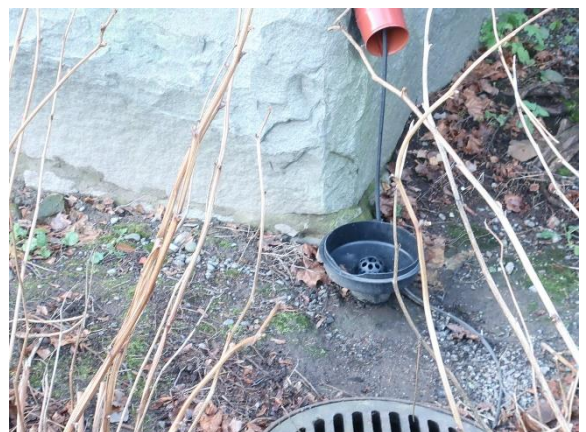
Kuva 76 Yleiskuva sulanapitokaapelista, joka menee syöksytorvesta maahan.
