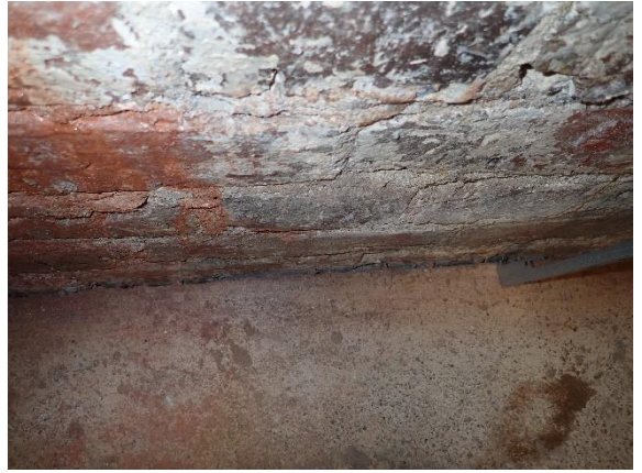
Kuva 16 Alapohjarakenteet ovat yleisesti hyvin epätiivitä.
