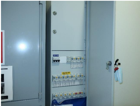
Kuva 65 Yleiskuva 2. kerroksen ryhmäkeskuksesta.
