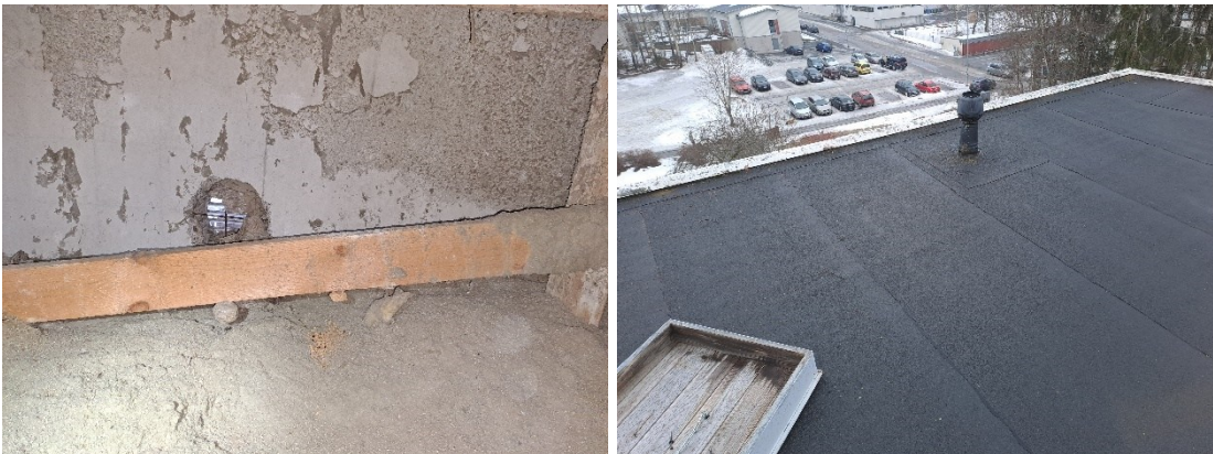
Kuva 21 a-b. a) Ulkoseinissä tuuletusaukot yläpohjatilaan. b) Ulkoseinälinjojen läheisyydessä alipainetuulettimia.
