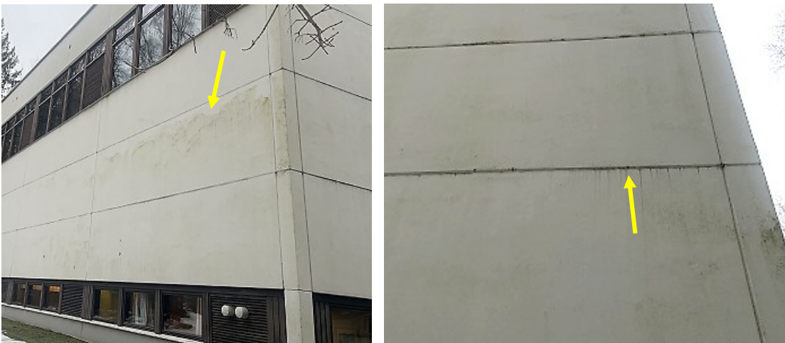
Kuva 32 a-b. Julkisivupinnoilla havaittua likaantumista ja valumajälkiä elementtien vaakasaumojen kohdalla.
