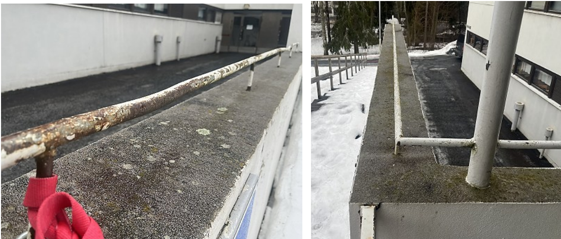
Kuva 42 a-b. Tukimuurin yläpinnat ovat jatkuvasti alttiina säärasitukselle. Käsijohteen teräsosissa on korroosiovaurioita.
