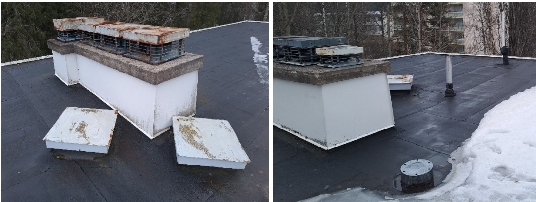
Kuvat 66 a-b. a) Huippuimurit HI1-HI5 rakennuksen vesikatolla. b) Huippuimurit HI6-HI8 vesikatolla.
