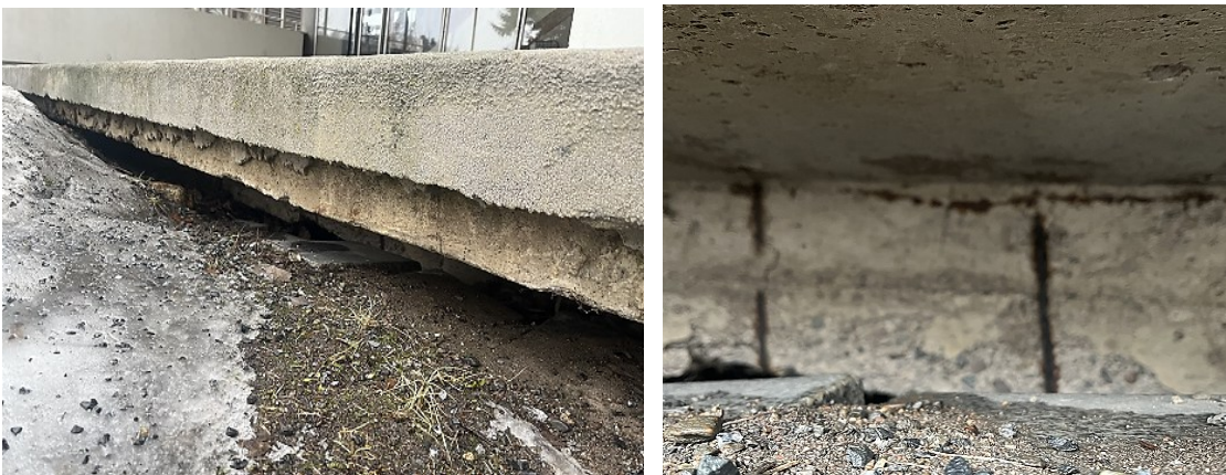
Kuva 35 a-b. Laatan etureunan alle on muodostunut tyhjä tila, josta havainnoituna palkkirakenteessa on terästen korroosioaurioita.
