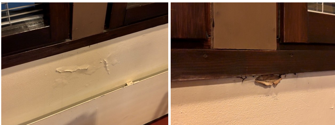
Kuva 11 a-b. Ulkoseinien sisäpinnoissa havaittiin vanhoiksi ja kuivuneiksi osoittautuneita kosteusjälkiä. Kosteusjäljet tarkastettiin pintakosteusilmaisimella, mutta niistä ei havaittu kohonneita pintakosteusilmaisimen arvoja.
