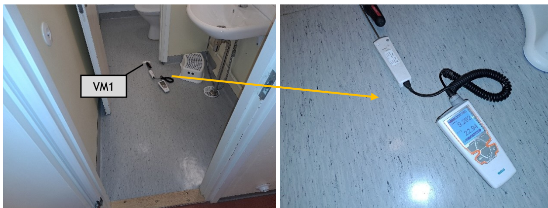
Kuva 14 a-b. Kellarikerroksen toisessa WC-tilassa havaituista koholla olevista pintakosteusilmaisimen arvoista huolimatta kosteus muovimaton alla oli viiltokosteusmittauksen perusteella normaalilla tasolla.
