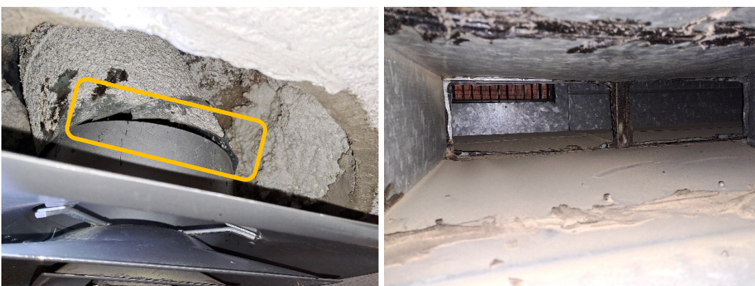
Kuvat 67 a-b. a) 2. kerroksessa tuloilmapäätelaitte oli lähes irti tuloilmakanavasta. b) Kellarikerroksen tuloilman runkokanavassa ja päätelaitteiden läheisyydessä todettiin runsasta likaa/ pölykertymää.
