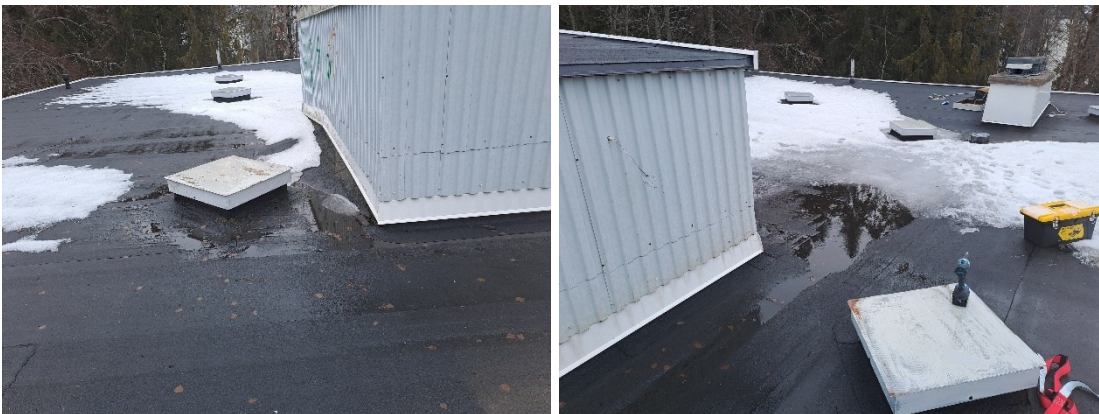
Kuva 19 a-b. Sade- ja sulamisvedet pääsevät osin lammikoitumaan vesikatolla eikä ohjautu sadevesikaivoihin. Sadevesikaivojen sihdit olivat puhtaat.
