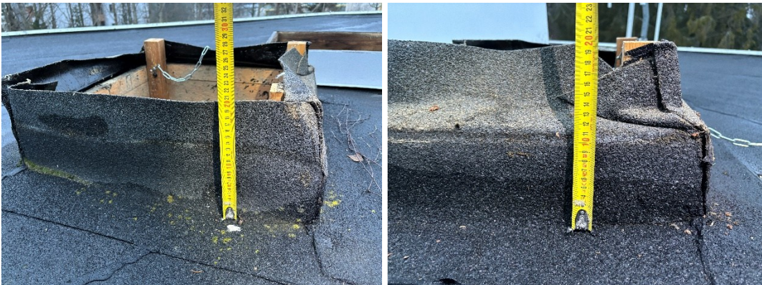
Kuva 18 a-b. a) Kattoluukkujen kohdalla puukorotus n. 100 mm. b) Kermissä mahdollisia epätiiviyskohtia.
