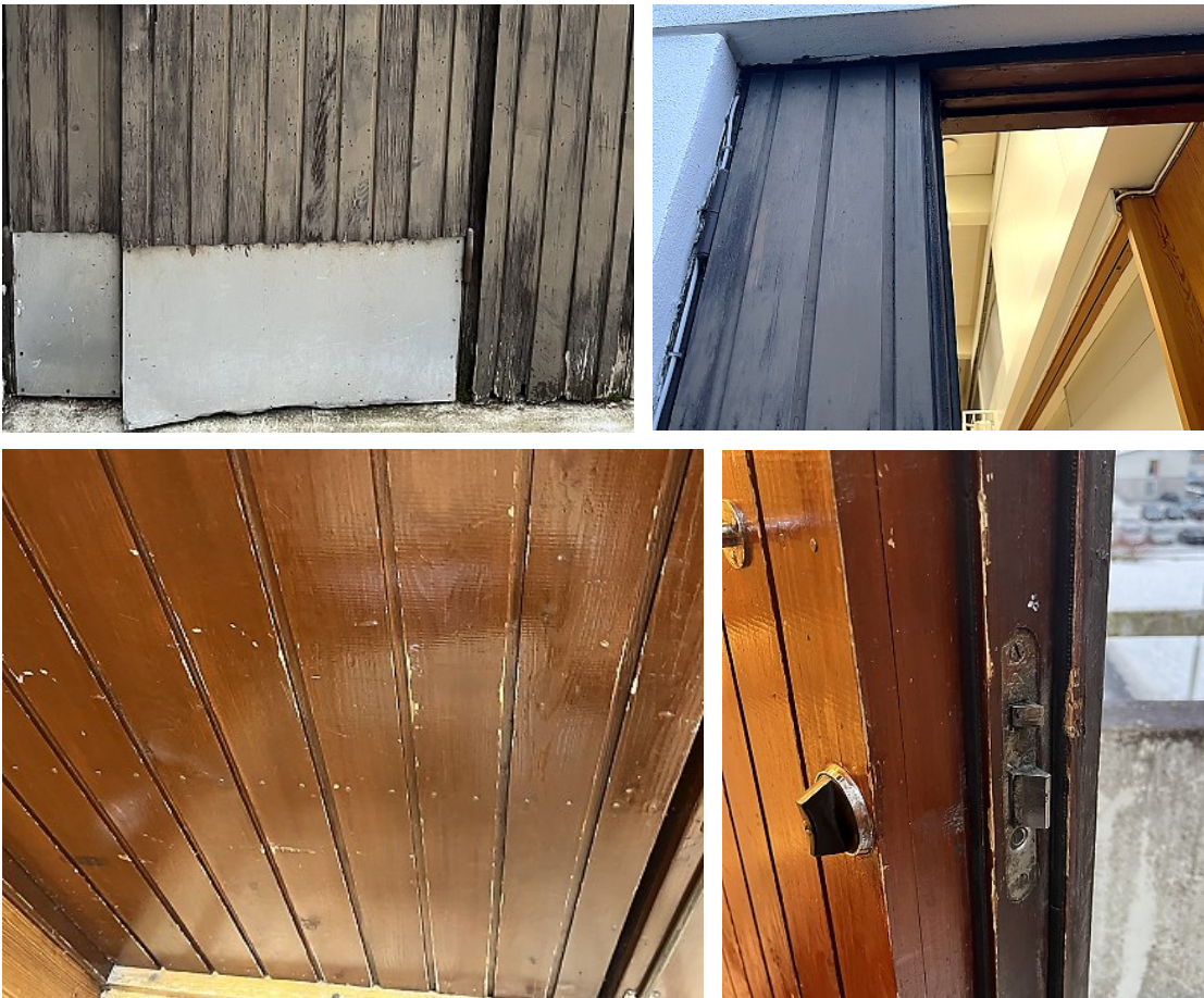
Kuva 63 a-d. Eteläsivun puupaneloidut ulko-ovet ensimmäisessä kerroksessa. Ovien lakkapinnat ovat paikoin kuluneita ja ulkopuolen pintakäsittely haalistunut ja puupinnat halkeilleet. Toisen oven potkupelti on irronnut nurkasta ja vääntynyt, oven alaosan puupaneeleissa on paikallisia lahovaurioita (kuva a).
