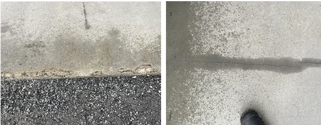
Kuva 34 a-b. Laatan yläpinnan vedeneristyspinnoitteessa on kulumaa ja halkeilua.
