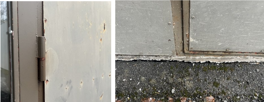
Kuva 58 a-b. Eteläsivun sisäänkäynnin teräsrakenteiset ulko-ovet. Ovien ulkopinnat ovat välttävässä kunnossa. Maalipinnat ovat monin paikoin hilseilleet altistaen teräsosat korroosiolle. Oven ja viereisen asfalttipinnan liitos on epätiivis.
