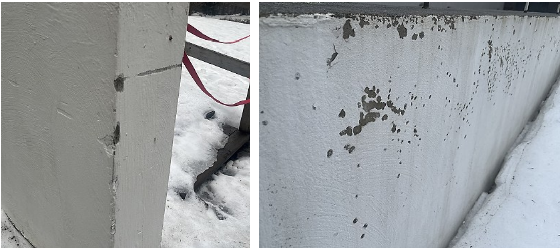
Kuva 41 a- b. Tukimuurin ohuessa laastikerroksessa on itäsivun puolella pintavaurioita.
