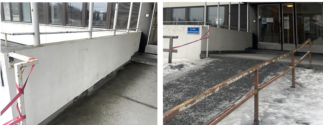
Kuva 36 a-b. Kaiteiden yläpinnat ovat alttiina viistosateelle. Sisäänkäyntiin liittyvän teräskaiteen suojaava maalipinnoite on kulunut lähes kokonaan pois.
