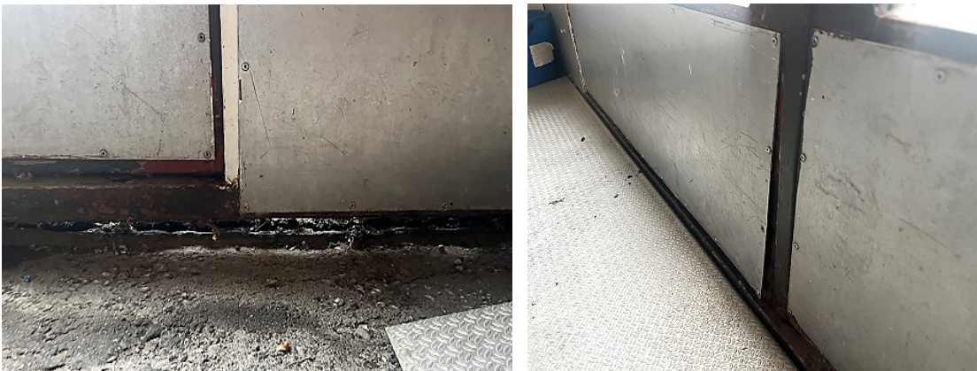
Kuva 59 a-b. Eteläsivun sisäänkäynnin teräsrakenteinen pääovi. Oven liitos alapohjaan on huomattavan epätiivis (kuva a). Potkupelti on osin irti (kuva b).
