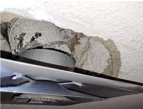
Kuva 24. Ilmanvaihdon päätelaitteiden kohdalla läpivientikohdat täysin auki yläpohjatilaa. Kuva kerhohuoneesta 304.
