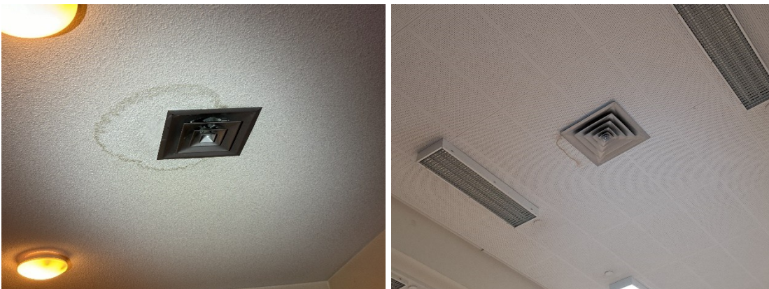
Kuva 23 a-b. a) 2. kerroksen kerhuhuoneessa 304 päätelaitteen kohdalla vanha vesivuotojälki. b) Salin katossa päätelaitteen kohdalla vanha vesivuotojälki.
