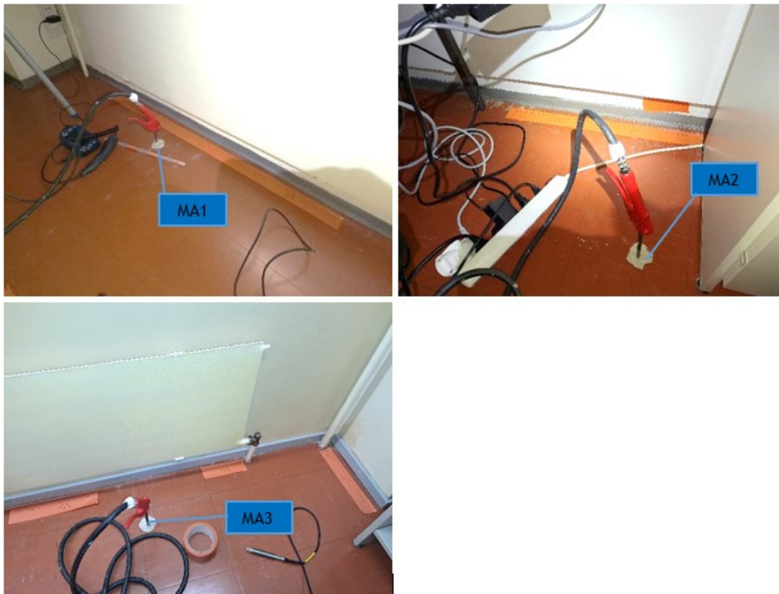
Kuva 6 a-c. Merkkiaineen syöttökohdat MA1-MA3 kellarikerroksen alapohjaan. Kellarikerroksen alapohjan liitoksista ulkoseinien ja maanvastaisiin seiniin havaittiin merkkiainekokeissa laajasti merkittäviä vuotoja. Kuvissa havaitut vuotokohdat on merkitty oransseilla teipeillä.
