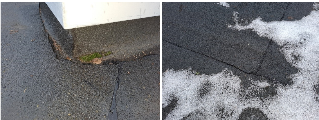
Kuva 17 a-b. a) Huippumurin juurella vähäisiä sammaloitumista. Kermityksen limitys "vääränsuuntainen". b) Kermipinnassa paikoin kupruilua
