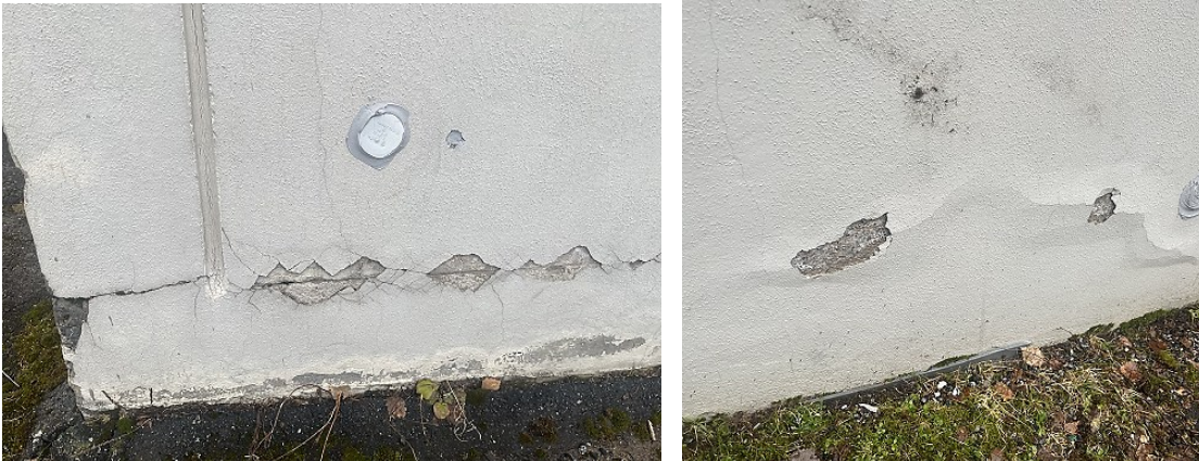
Kuva 31 a-b. Itä- ja eteläsivun sokkelielementeissä havaittuja laastikerroksen halkeama- ja rapautumavaurioita.
