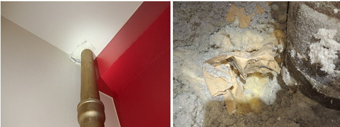
Kuva 22 a-b. a) 2. kerroksen WC-tilan katossa vanha vesijälki. b) Yläpohjatilassa villassa tummentumaa, mutta ei aktiivista kosteutta. Mineraalivillasta otettiin materiaalinäyte M11.
