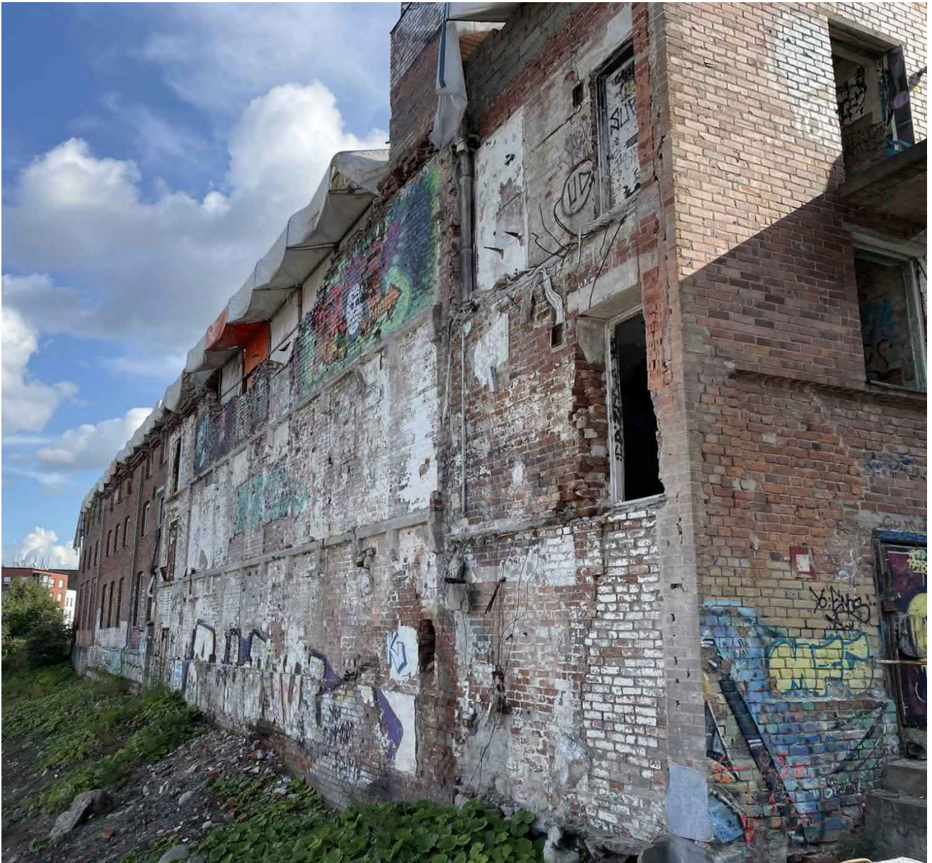
Kuva rakennuksen ilkkivallan kohteena olleista ja vaurioituneista julkisivuista.
