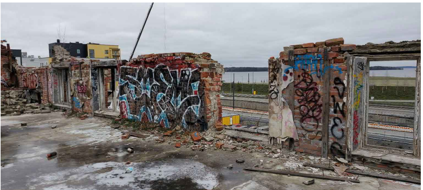
Kuva rakennuksen ullakkokerroksesta yläpohjarakenteiden tuhouduttua tulipalossa.
