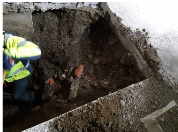
Koekuoppa VAH1 pohja. Tiilet tippuneet pinnasta laatan alta.
