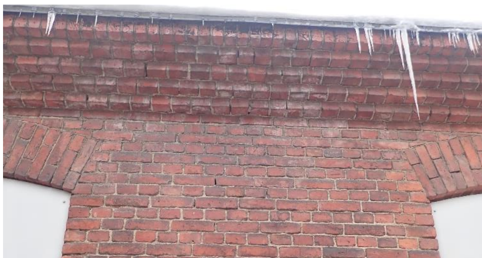
Kuva 4a, b ja c. Aiempien, ennen vesikaton uusimista tapahtuneiden, räystäs- ja vesikattovuotojen jälkiä on yleisesti nähtävissä erityisesti seinien yläosissa ja muuratuissa räystäissä..
