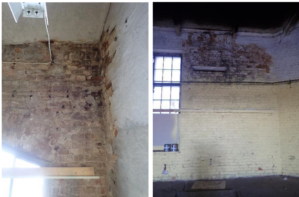
Kuva 11a ja b. Ulkoseinien sisäpintojen yläosissa näkyy yleisesti kosteuden aiheuttamia jälkiä. Sisäpuoliset rappaukset ovat paikoin irronneet lähes kokonaan. Esimerkkikuvat pilttuista 8 (kuva a) sekä 5 (kuva b).
