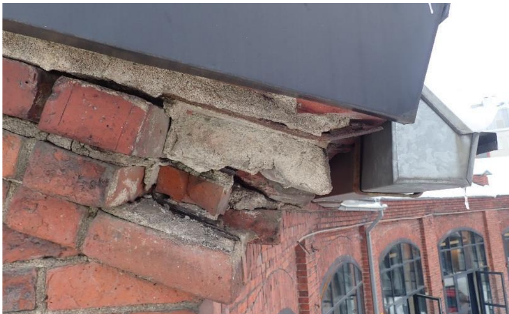
Kuva 5a ja b. Muuratun räystäään ulkonurkka on tehty laastisaumoihin sijoitettujen terästankojen varaan. Raudat ovat paikoin kadonneet kokonaan ruostumisen seurauksena ja tiilirakenne on paikallisesti romahtanut. Joitain putoamisvaarassa olleita tiiliä poistettiin tutkimuksen yhteydessä. Esimerkki pohjoisemman päädyn nurkasta.
