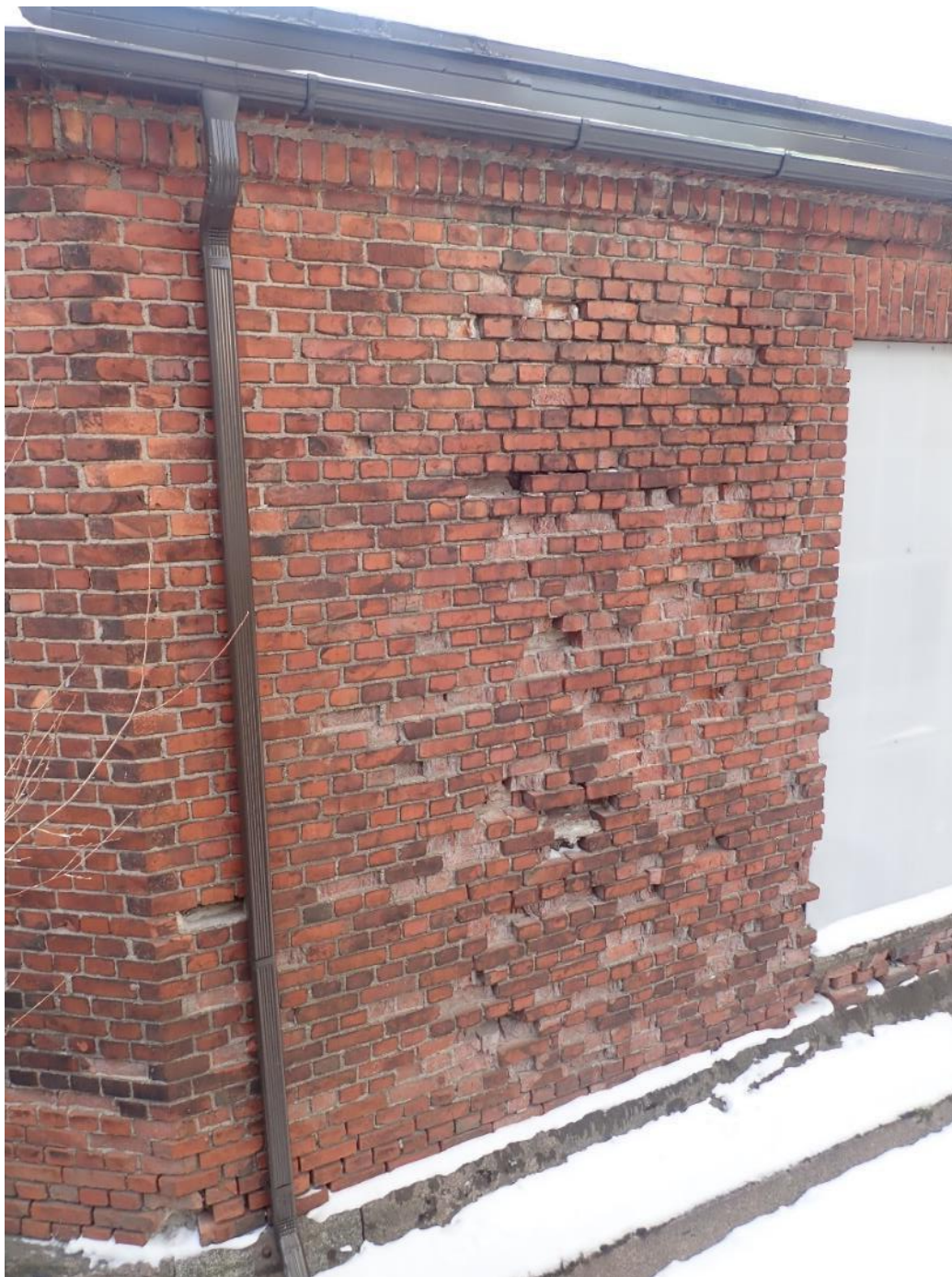
Kuva 8. Pilttuu 5:n ulkokaarteeseen ulkoseinässä on laaja alue, jossa tiilet ovat rapautuneet ilmeisesti aiemman pitkäaikaisen kosteusrasituksen seurauksena.
