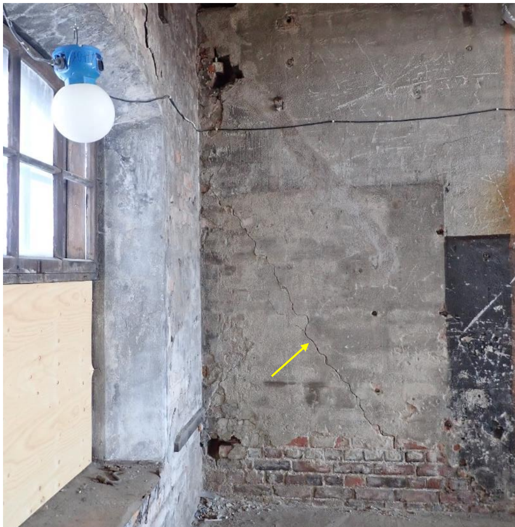
Kuva 14. Väliseinän alaosan diagonaalihalkeama pilttuussa 6.
