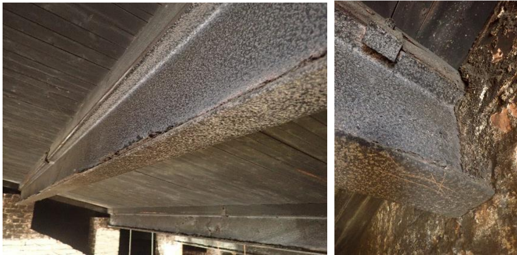
Kuva 20a ja b. Pilttuussa 7 kattopalkit ovat pinnaltaan voimakkaasti syöpyneitä.
