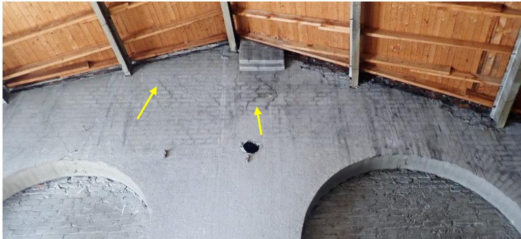
Kuva 13. Pienimuotoista tiheää rappauspinnassa näkyvää halkeilua väliseinän yläosassa pilttuussa 6.
