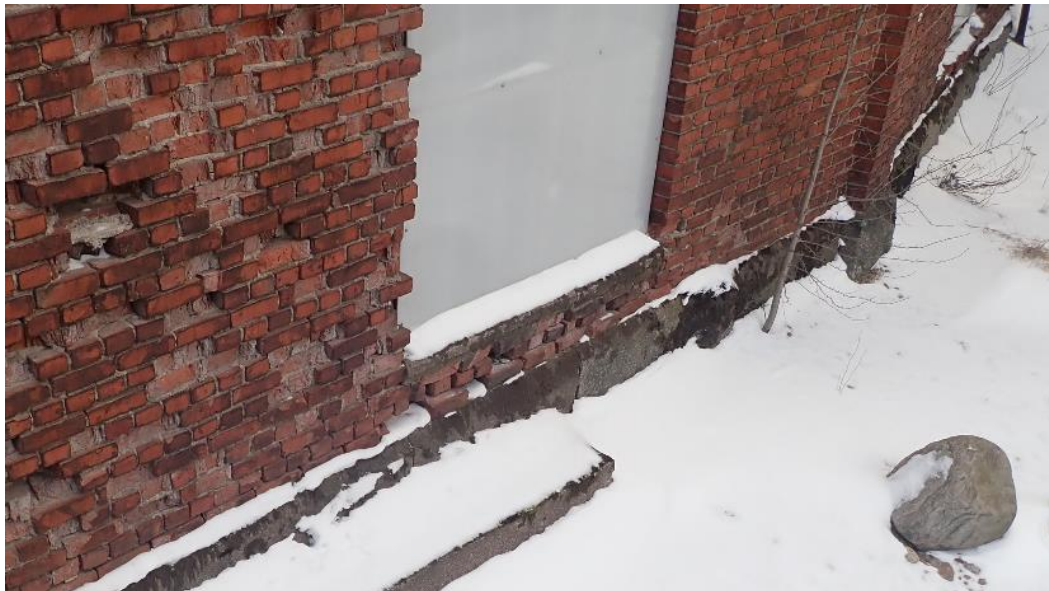
Kuva 10a ja b. Useiden ikkuna-aukkojen alareunan muuraus on joko rapautunut tai jo uudelleen muurattu.
