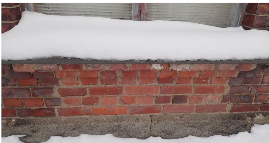
Kuva 3a ja b. Ulkopinnassa näkyy runsaasti eri aikoina toteutettuja korjauksia ja muutoksia. Tiilien koostumus ja polttoaste vaihtelevat, samoin laastisaumojen koostumus ja kunto.
