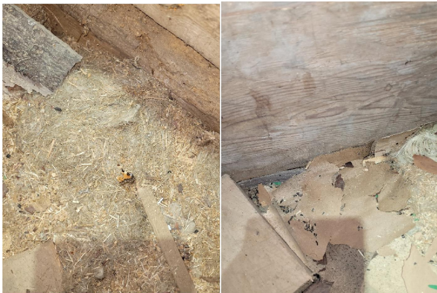
Kuva 5-3. Vähäsillan leirikeskuksen päärakennuksen vintin toisesta lappeesta löytyy viitteitä lepakoiden aktiivisesta lisääntymis- tai levähdyspaikasta tuoreiden papanoiden ja hyönteisten jäämien perusteella.
