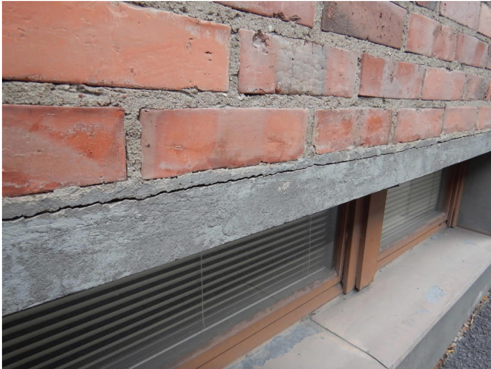
Kuva 3. Halkeama ikkunapalkin ja muurauksen saumassa.
