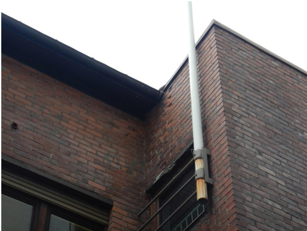
Kuva 5. Muuraus on rapautunut ja betoninen ikkunapalkki hajalla porrastornin yläosassa.
