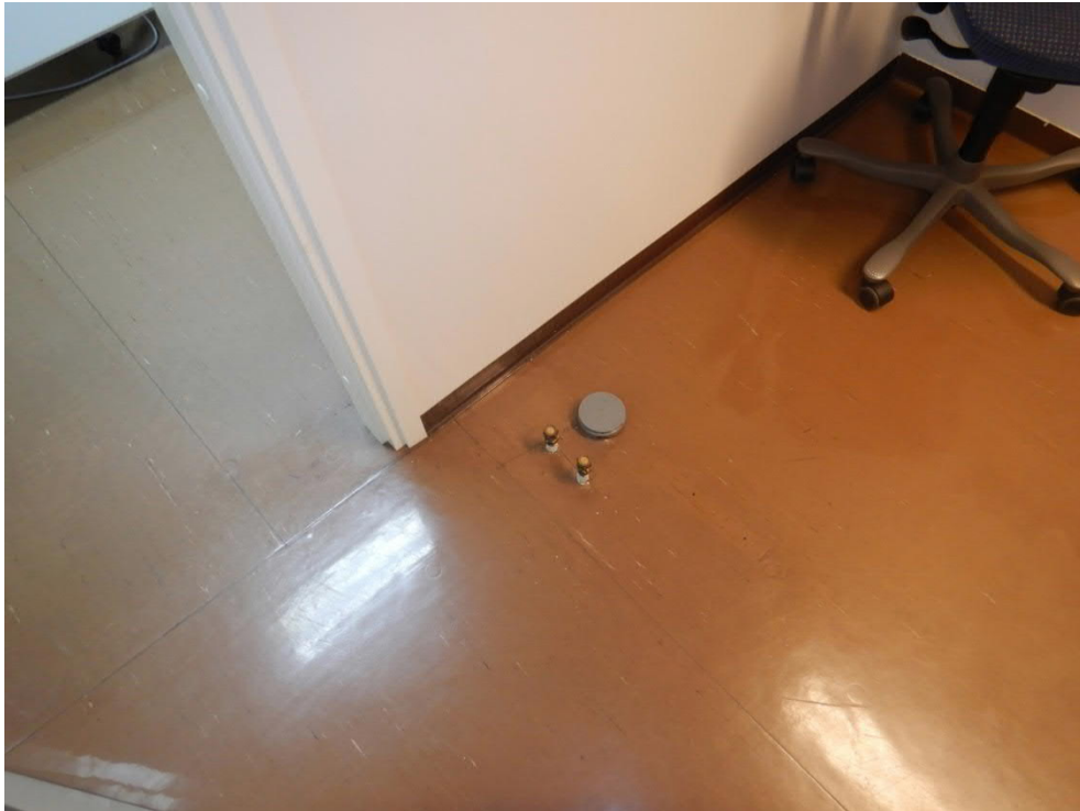
Kuva 41. Vanhat vesijohdot on katkaistu ja tulpattu. Mahdollinen kompastumisvaara.
