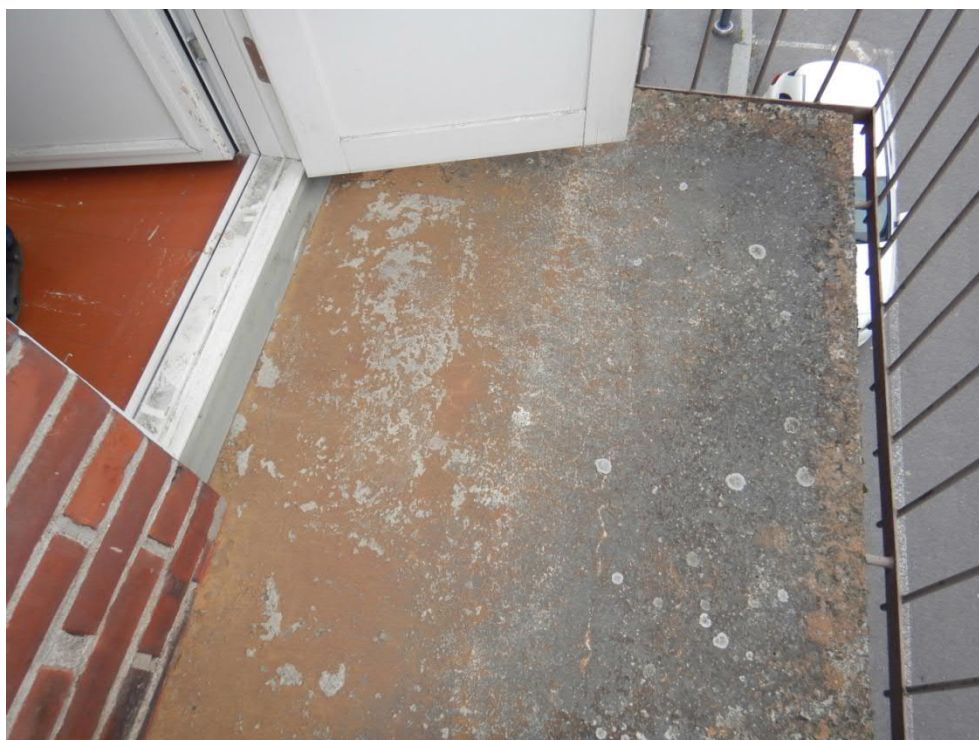
Kuva 7. Parvekelaatan yläpuolen pinnoite on kulunut pois jo aikaa sitten.
