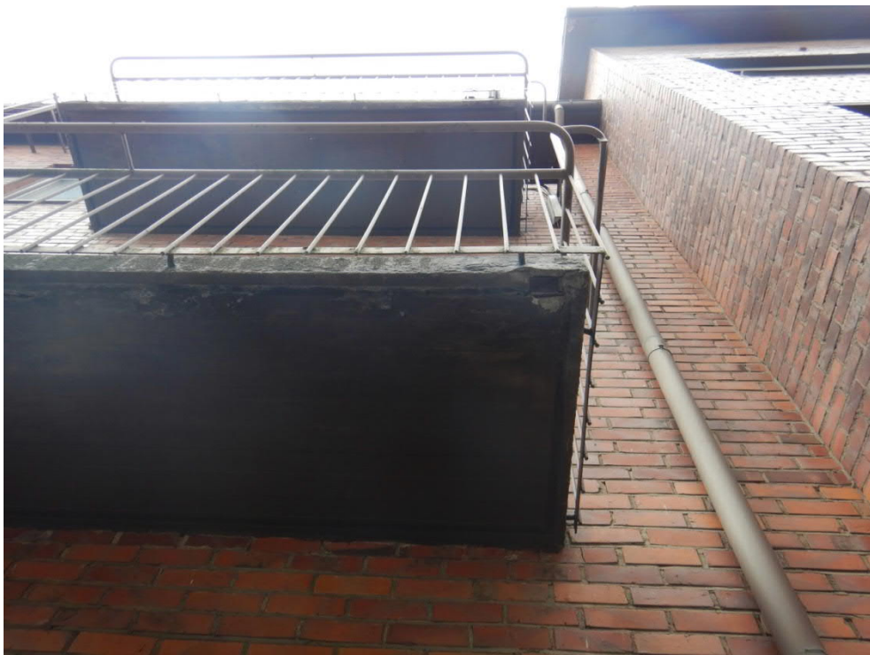
Kuva 6. Parvekelaatassa on betonivaurio kulmassa. Teräs on paljaana ja ruostunut.
