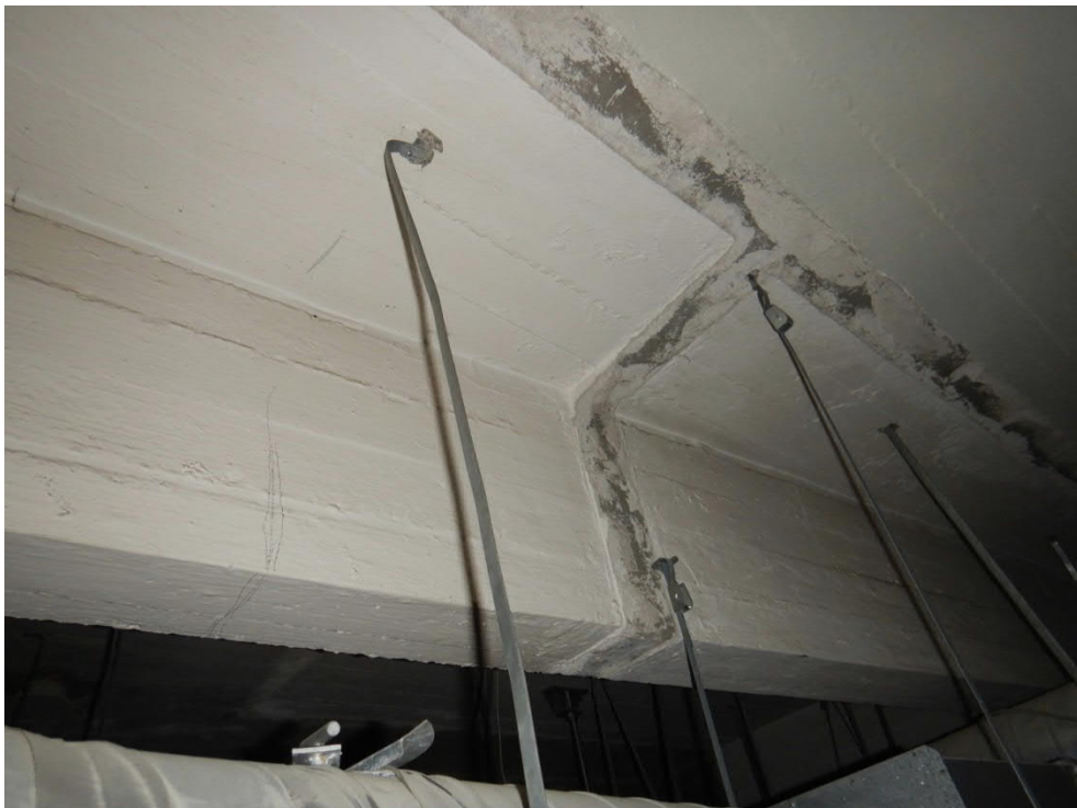
Kuva 40. Purettujen väliseinien jättämiä jälkiä betonirakenteissa alakaton sisällä.
