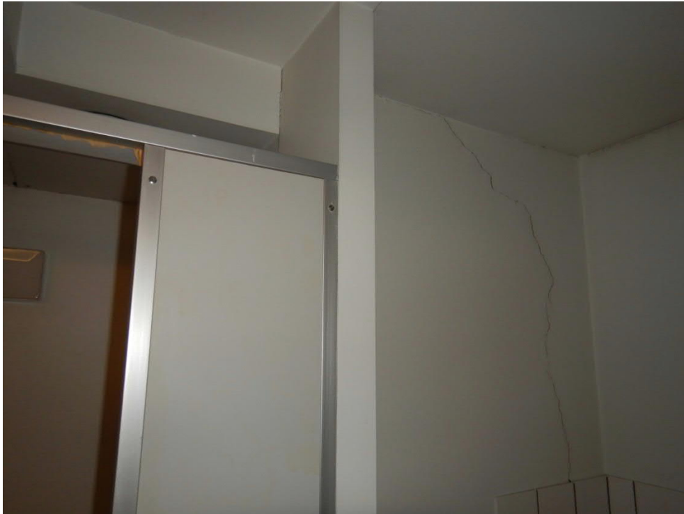
Kuva 21. Halkeama 1 krs. wc-tilassa. Halkeama on asunto-osan hormin seinässä.
