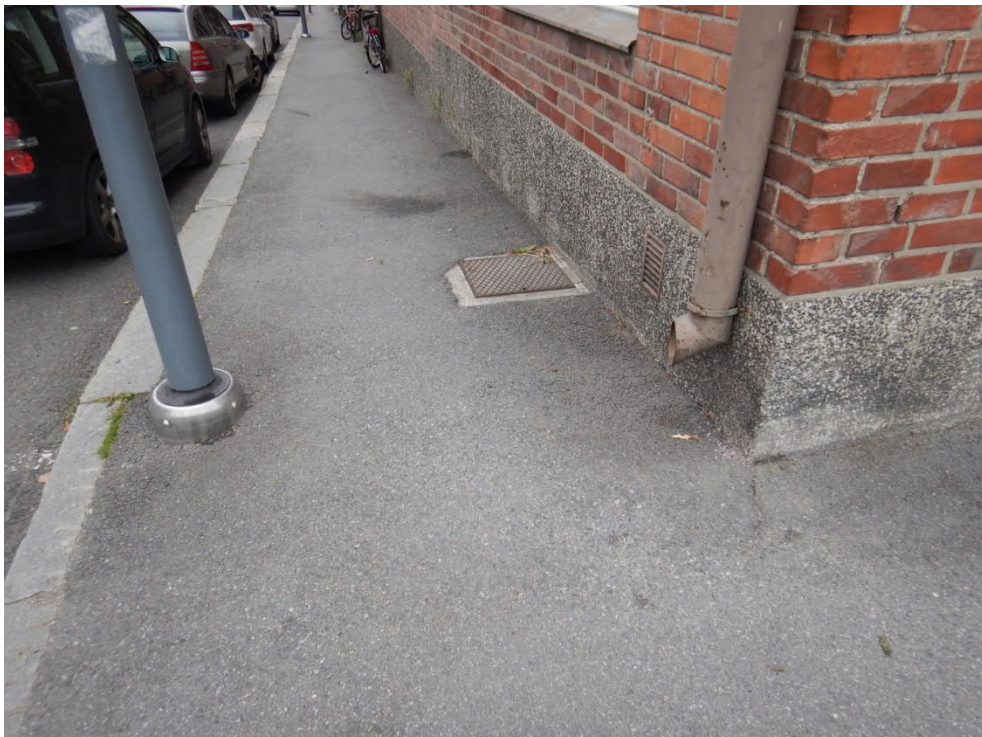
Kuva 2. Syöksytorvi laskee vedet jalkakäytävälle.
