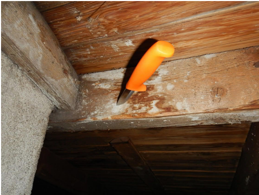
Kuva 37. Vauriojälkiä kattopalkissa läpiviennin vieressä. Puussa ei havaittu merkittävää pehmenemää.
