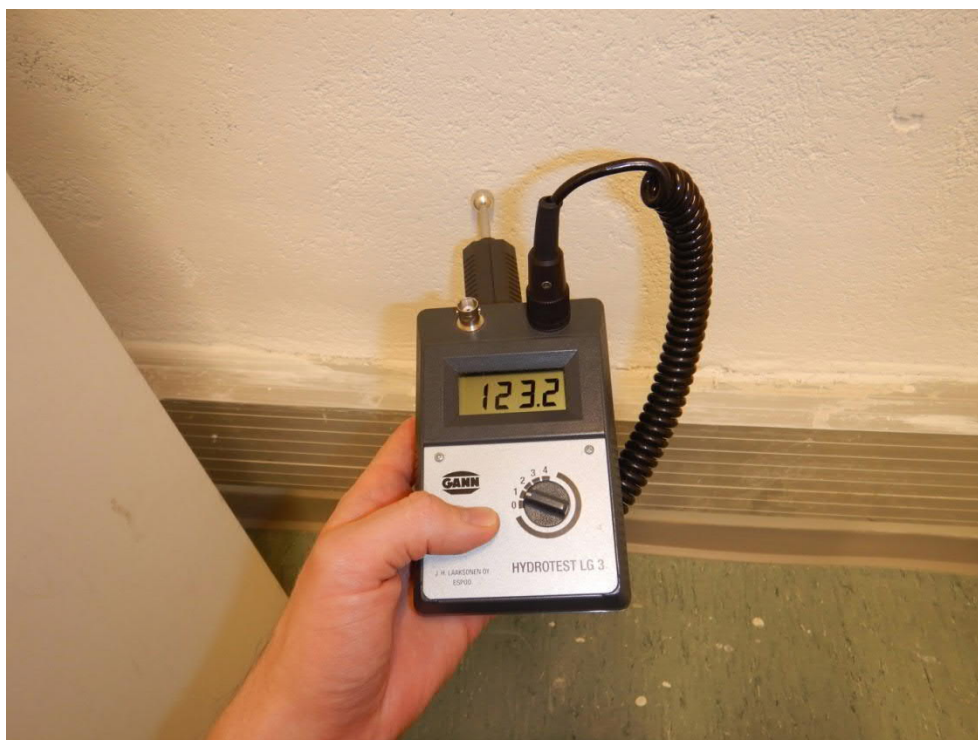
Kuva 13. Kellarin varastohuoneen seinä takana. Kohdassa on ollut aiemmin kosteuden aiheuttamaa maalin irtoamista. Lukema viittaa kosteuteen.
