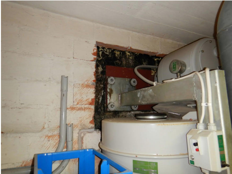
Kuva 15. Väestönsuojan betoniseinän sisäpunnassa on näkyvissä musta kosteudeneriste. Eristeessä voi olla PAH-yhdisteitä tai asbestia.
