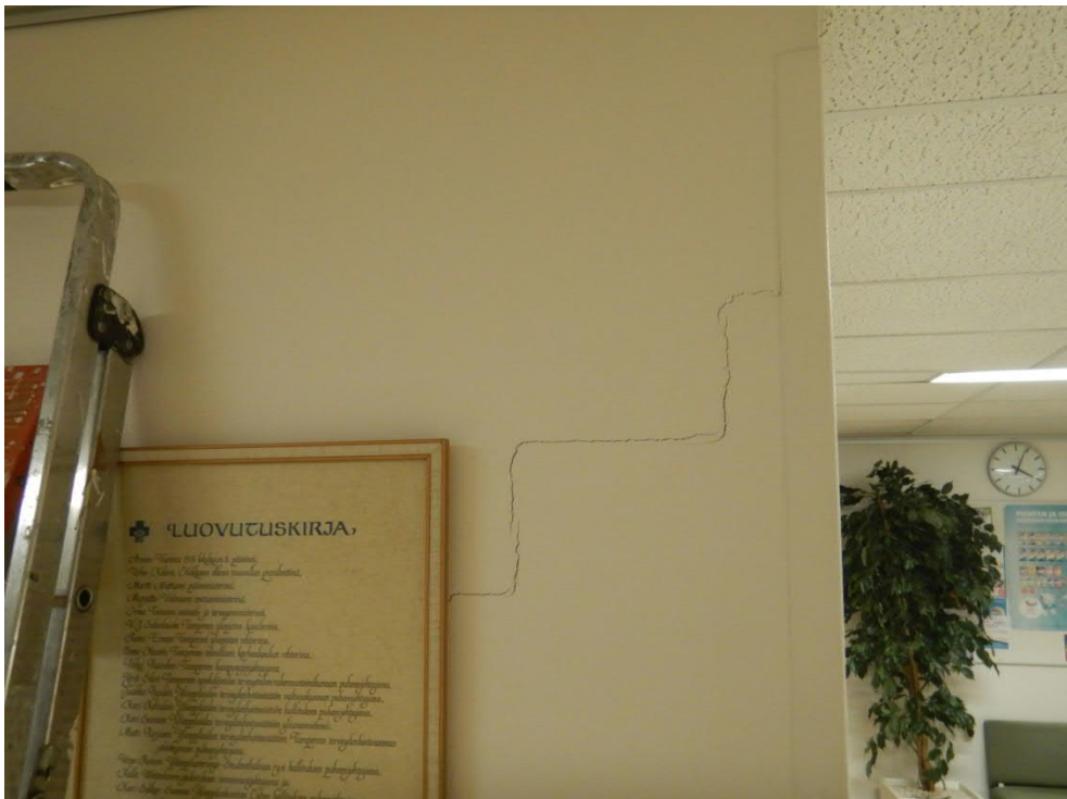
Kuva 26. Halkeama muuratussa väliseinässä.
