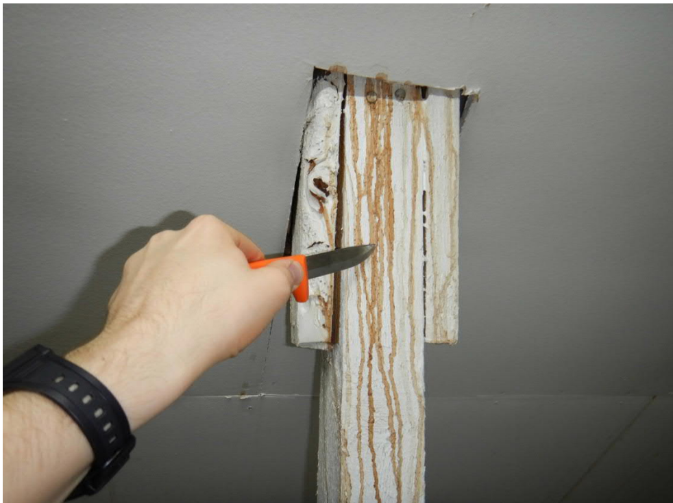
Kuva 36. Vanhoja valumajälkiä kattokannattimessa. Pehmenemää ei havaittu.
