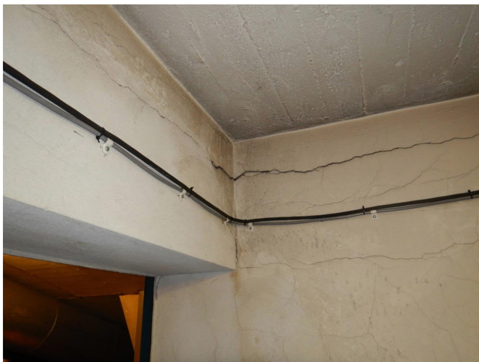
Kuva 23. Halkeama hissin konehuoneen seinäkulmassa.
