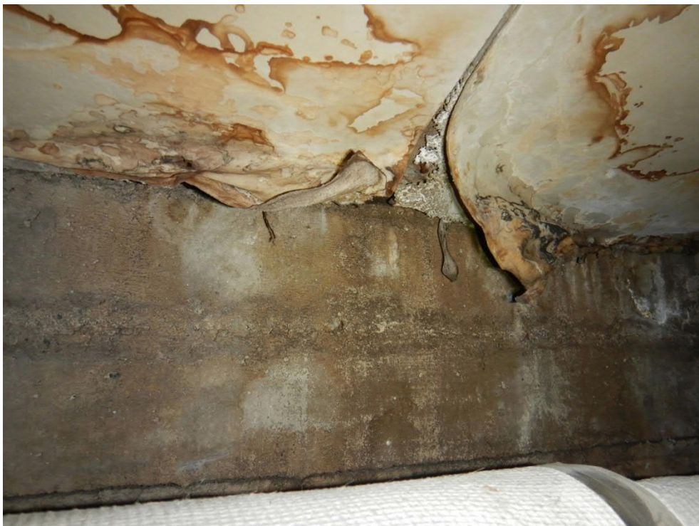
Kuva 38. Vesikatto on vuotanut joskus reilummin varastossa ullakon wc-tilojen takana.
