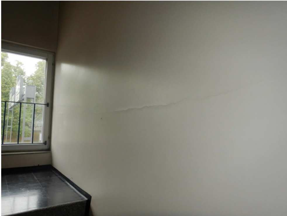
Kuva 25. Vaakasuuntainen halkeama porrashuoneen betoniseinässä.
