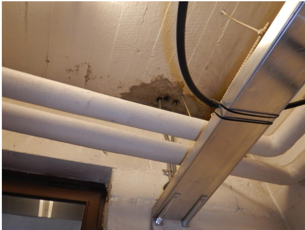
Kuva 17. Asbestieristeisiä putkia kellarissa. Taustalla näkyy mahdollisesti puutteellinen välipohjan läpiviennin palokatko.
