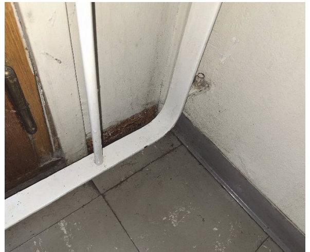
Käytöstä aiheutunutta kosteusjälkeä.
