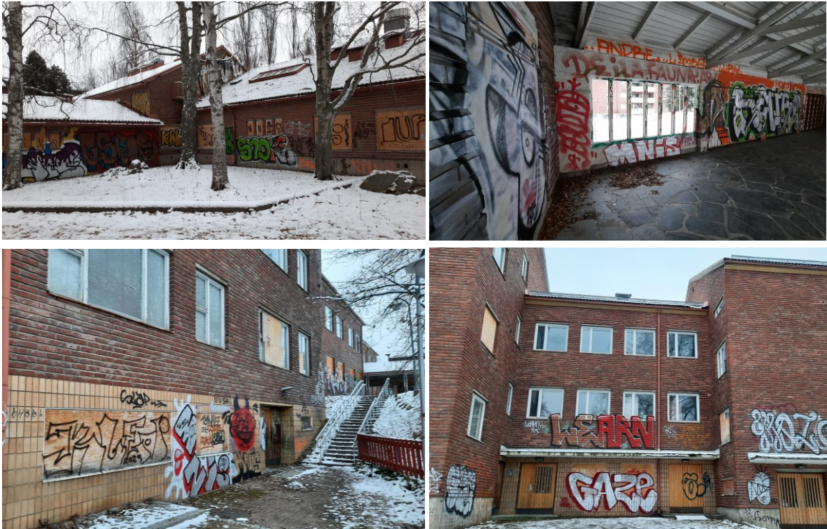
Lastentaloon on kohdistunut valittavan paljon ilkivaltaa viime vuosina. Kuvat marraskuu 2023, Tampereen kaupunki.
