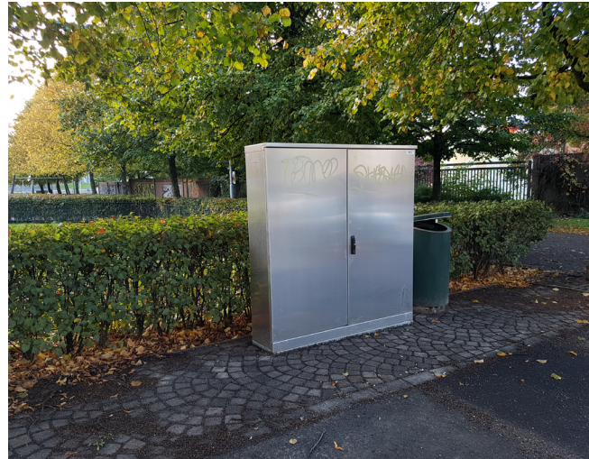
Kuva 41. Esimerkkikuva sähkökaapin huolitellusta sijoituksesta niin, että kulku-yhteydet eivät esty ja näkymät säilyvät.
