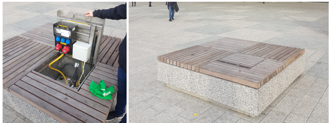
Kuva 43. Aukion penkkiin integroitu tapahtumasähköpiste Kansalaistorilla Helsingissä.
