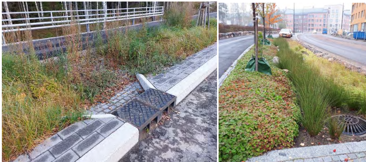
Kuva 3.2. Läpivirtaava kitakansisto Mossin Puistokadulta Tampereelta, jolla ajoradan vesiä ohjataan reuna-alueelle ja suodatuspainanne Kuninkaantammesta Helsingistä (Ramboll).
