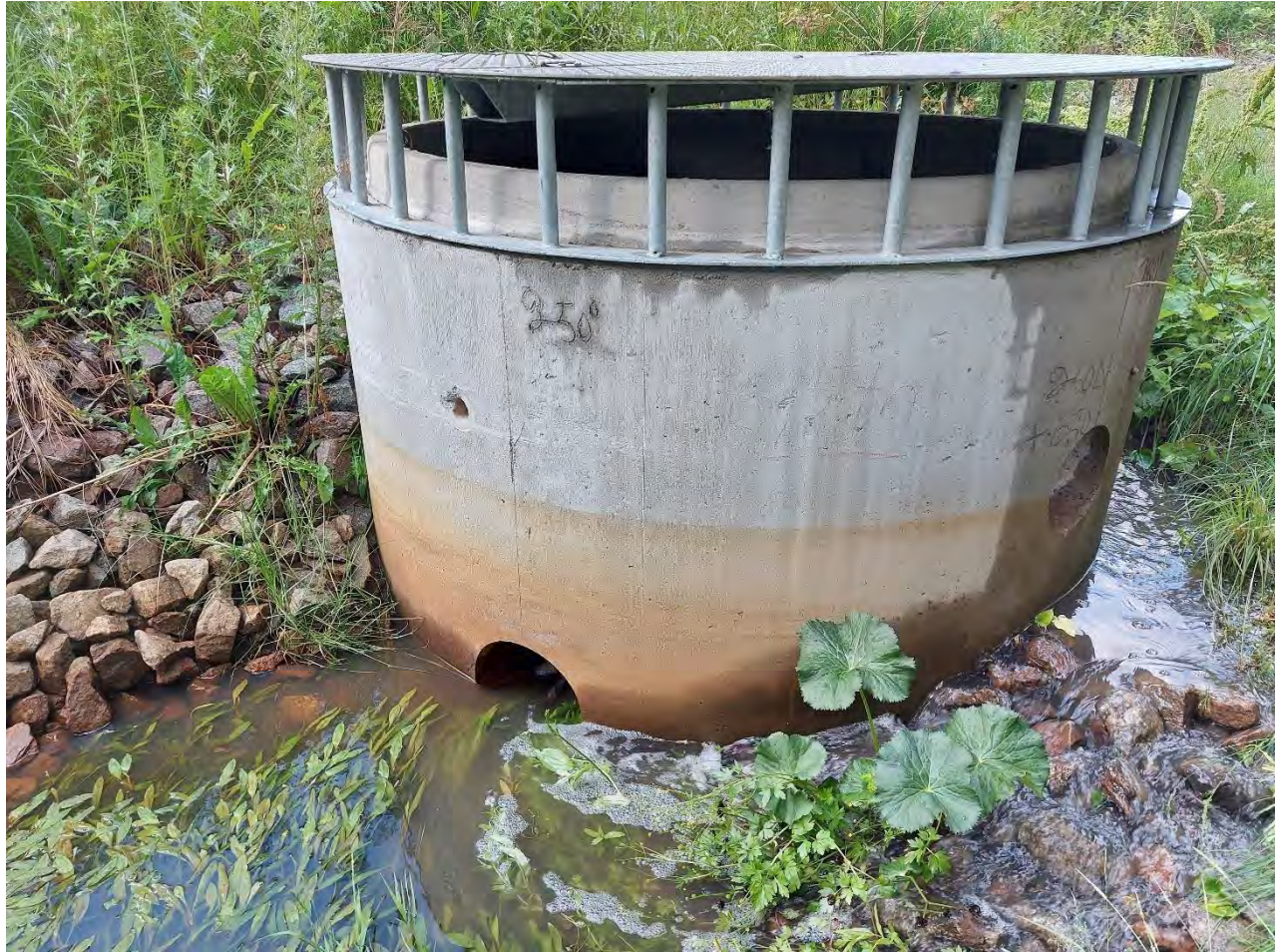
Kuva 2.2. Kaupinlaakso I kaava-alueella Teiskontien varressa nykyisellä kosteikkoalaisella hulevesien hallinta-alueella sijaitseva virtauksensäätkäkaivo.
