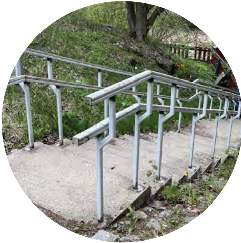
kunnostettava betoniporras ja käsijohde
