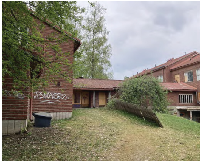
Koillinen sisäpiha. Sisäänkäynnin liuskekiveys on peittynyt kasvillisuudella.
