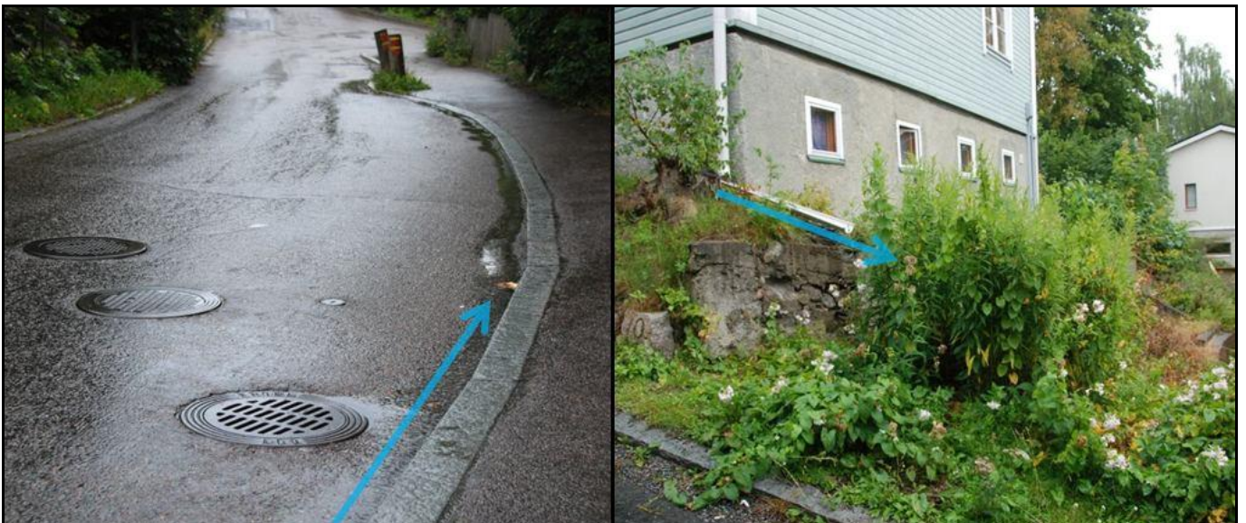
Kuva 7. Usein toistuvia ongelmia. Vasen kuva: katualueen hulevesikaivot liian kaukana reunakivestä. Oikea kuva: rakennusten hulevesiä johdetaan hallitsemattomasti ympäristöön tai viereiselle tontille. Rinnemaastossa tämä aiheuttaa eroosiota ja voi johtaa kosteusongelmiin. 10
