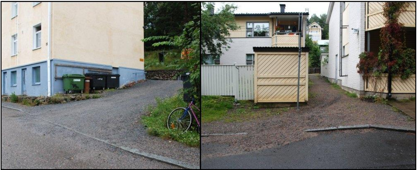
Kuva 6. Tyypillisiä pintaerosion esiintymispaikkoja Pispalassa. Hulevesien hallitsematon johtaminen tonttien sisällä ja paikoin erittäin suuret kaltevuudet johtavat helposti sorapintojen syöpmiseen. 10
