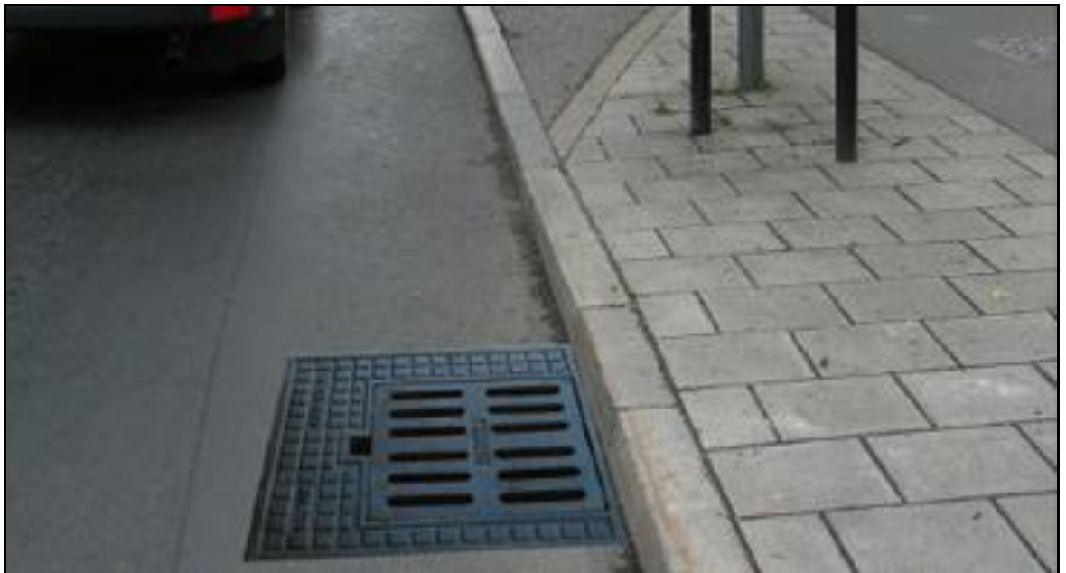
Kuva 28. Esimerkki hyvin vetävästä hulevesikaivon kannesta 18 .
