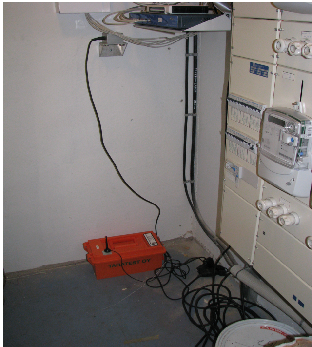
Kuva 1: Etäluettava mittauspiste maanpaineseinässä.
