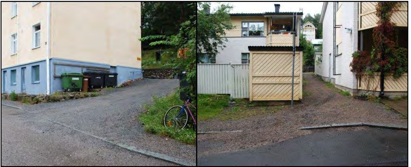
Kuva 6. Tyypillisiä pintaerosion esiintymispaikkoja Pispalassa. Hulevesien hallitsematon johtaminen tonttien sisällä ja paikoin erittäin suuret kaltevuudet johtavat helposti sorapintojen syöpymiseen. 10
