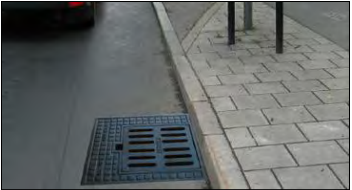
Kuva 28. Esimerkki hyvin vetävästä hulevesikaivon kannesta 18 .
