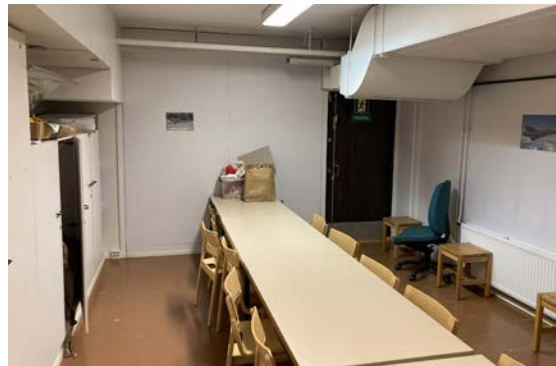
Yllä Ilmastointiputkien asennukset on tehty tekniikan vaatimukset edellä myös sisätiloissa. Kuva kellarikerroksesta (kuva 25).
