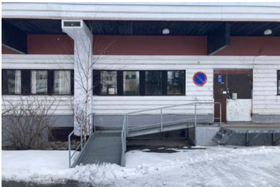
Yllä: Ilmastointiputken ja ramppien asennukset ovat aiheuttaneet julkisivuun muutoksia ympäri rakennusta (kuva 24).
