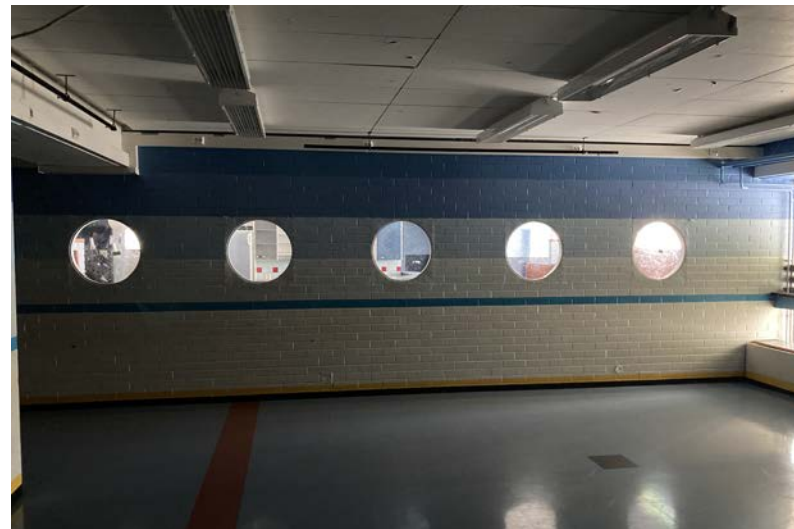
Kellarikerroksen nuorisotiloissa on 90-luvulla rei'itetty väliseinä (kuva 16).
