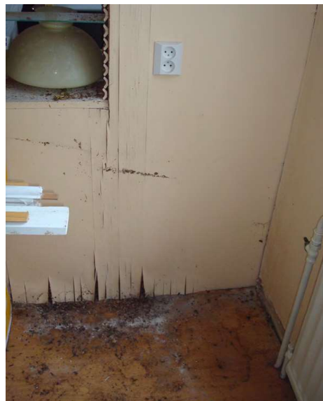
Kosteusvaurio keittiön ja olohuoneen välisessä seinässä.
