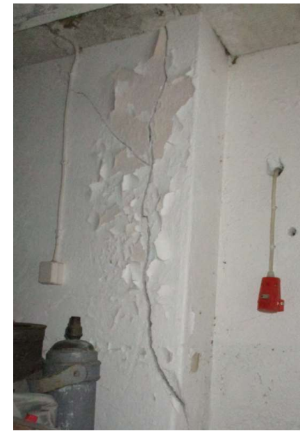
1. kerroksen halkeillutta seinää.
