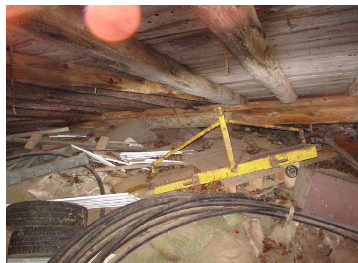
Alapohjan tuulettuvuus on osin estynyt tuuletustilaan jätetyn tavaran vuoksi.
