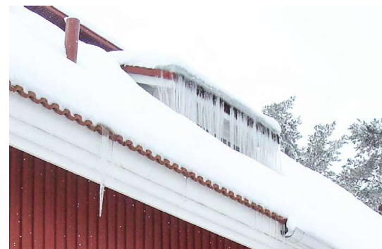
Kattolyhdyn kohdalta karkaavan lämmön paljastava jääpuikkorivi.
