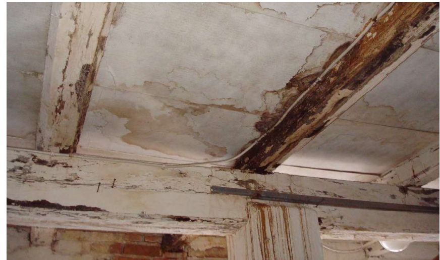
Ensimmäisen kerroksen katon kosteusvaurioita.
