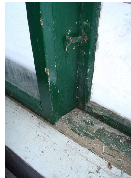
Ikkunoiden maalipinnat kaipaavat kunnostusta.
