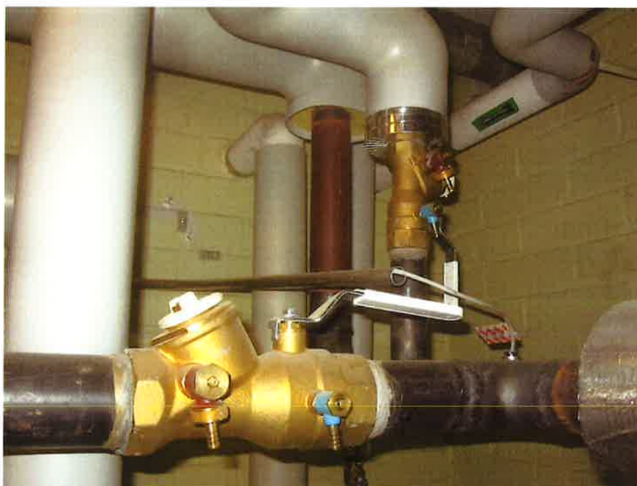
Kuva 6. Lämpöjohtoverkoston linjasulku- ja linjasäätösäätöventtien kuntoluokka on KL 5.
