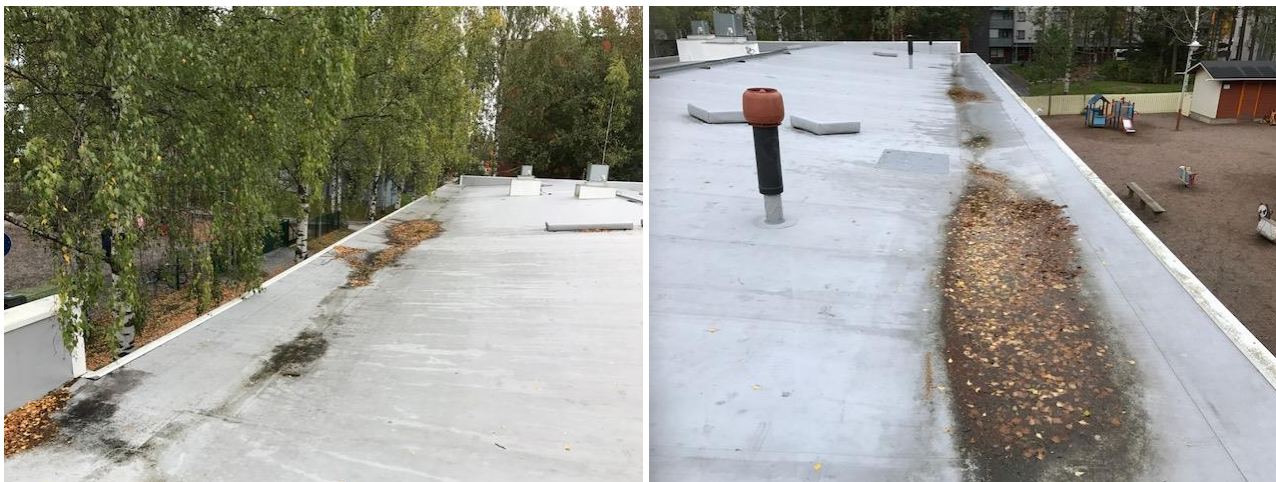
Kuvat 13a ja b. Rakennuksen lähellä olevat puunlehdet tukkivat kattokaivoja erityisesti lähipalvelukeskuksen puoleisella sivustalla (vas. kuva), mutta osin myös sisäpihan puoleisella lappeella (oik. kuva). Rakennuksen vieressä olevien puiden kaatamista suositellaan.
