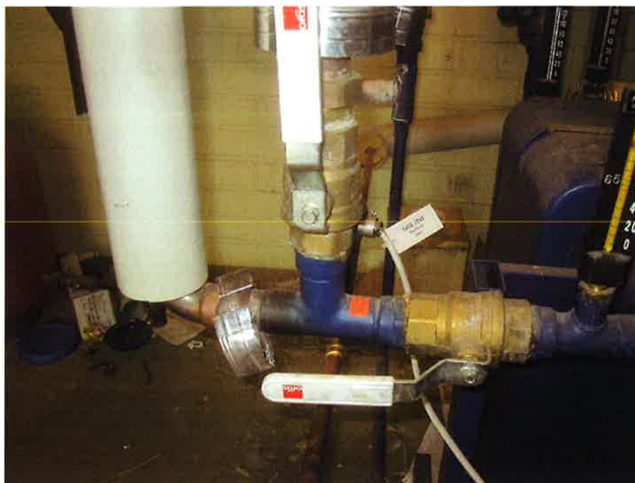
Kuva 4. Lämminvesiverkoston linjaventtiilien kuntoluokka on KL 5.
