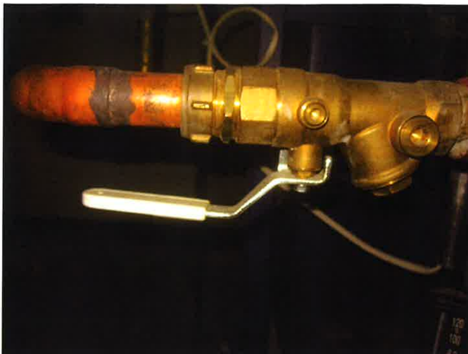
Kuva 5. Kiertojohtoon linjaventtiin kuntoluokka on KL 5.
