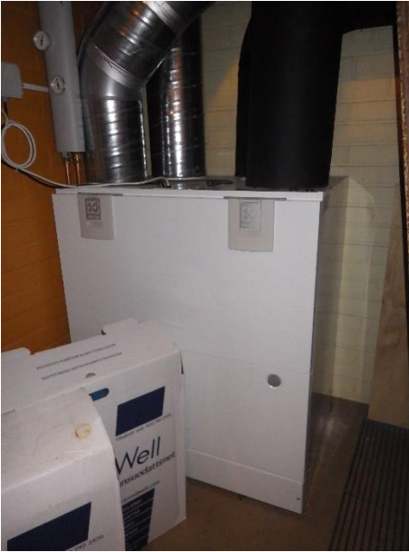
Kuva 32. Erillistilan (Viikarit) ilmanvaihtokone.
