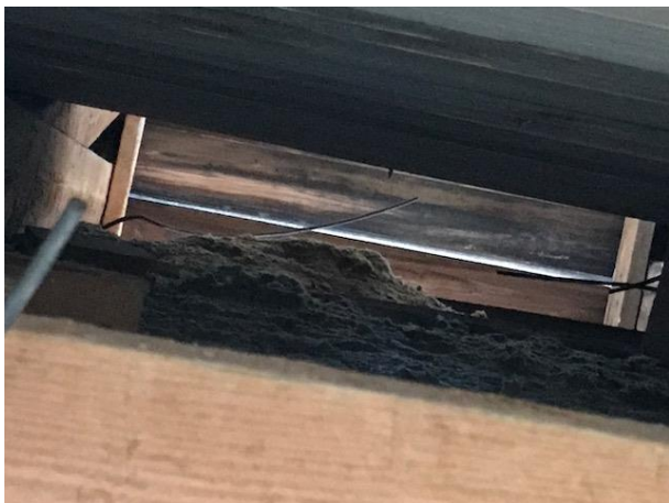
Kuva 21. Kuva rakenneavauksen (YP avaus 4) sisältä kuvattuna yläpohjan tuuletustilassa räystäälle päin. Kuvassa näkyvässä tuuletusrako räystäällä. Räystään puurakenteet ovat tummuneet.
