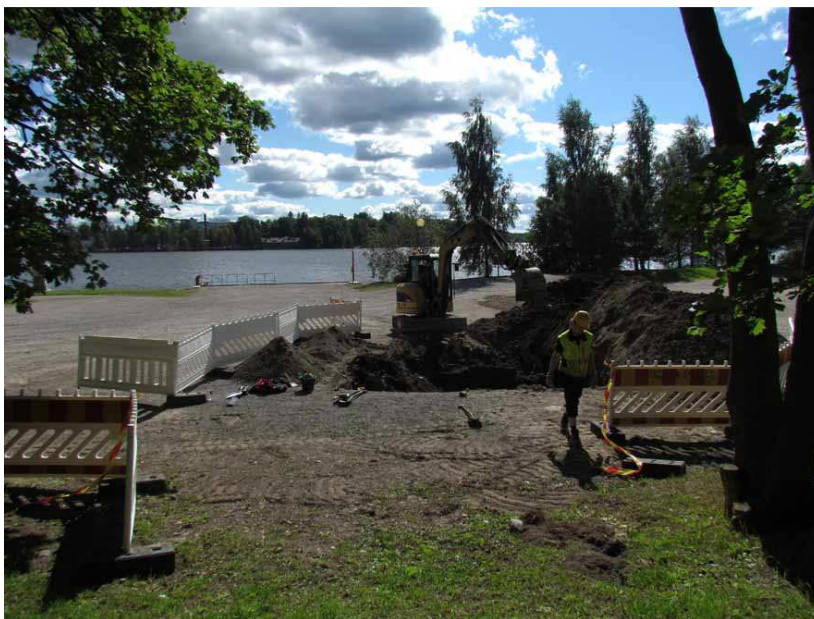
Kuva 35. Koeoja 4 Eteläpuiston hiekkakentän pohjoisreunassa. Kuvattu pohjoisesta. (Kuva: Tampere, Frenckellin kalkkiruukin ja Nalkalan tiiliruukin koekaivaus 2015: 20)
