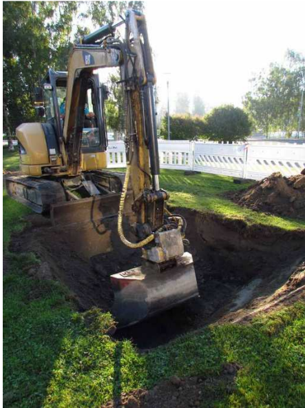
Kuva 17. Kaivinkone Nalkalantorin puistoalueella kaivamassa keojaa 5. Kuvattu luoteesta. (Kuva: Tampere, Frenckellin kalkkiruukin ja Nalkalan tiiliruukin koekaivaus 2015: 2)
