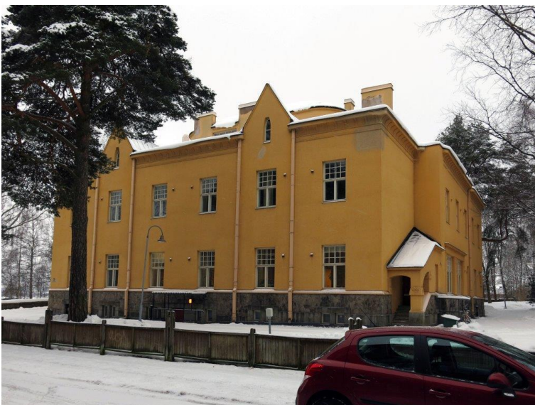
Itäisivu. Koristeaihe tai -kaide julkisivun yläosasta on jätetty toteuttamatta. Myös kukkalaatikot ovat kadonneet.
