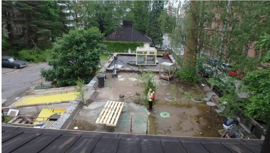
Kuva 23. Lämpökeskuksen katolla kasvaa puuntaimia.
