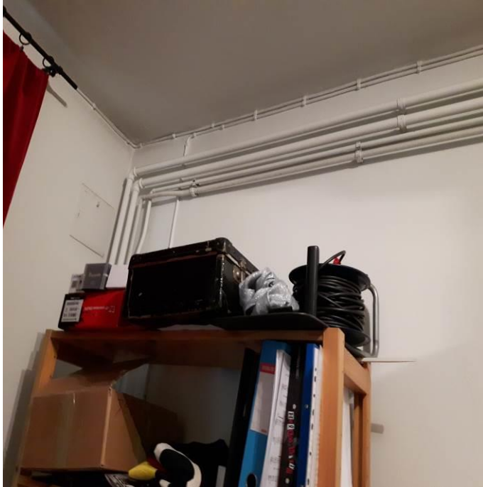
Kuva 34. Kärysaunan vesi- ja lämpöjohdot.
