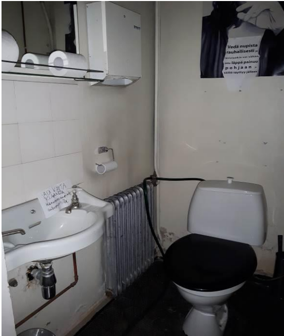
Kuva 39. Mehuaseman vesikalusteet ja lämpöpatteri(50 luvulta).
