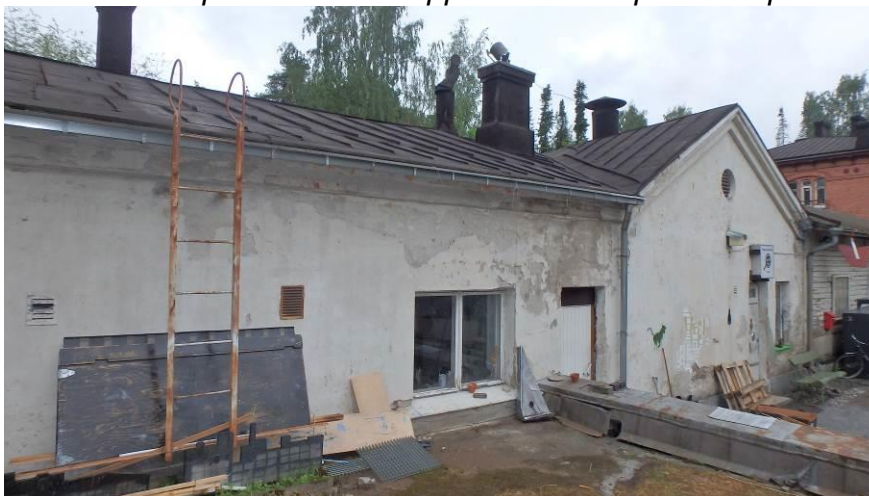
Kuva 12. Mehuaseman rappauksissa on kosteuden aiheuttamia vaurioita.
