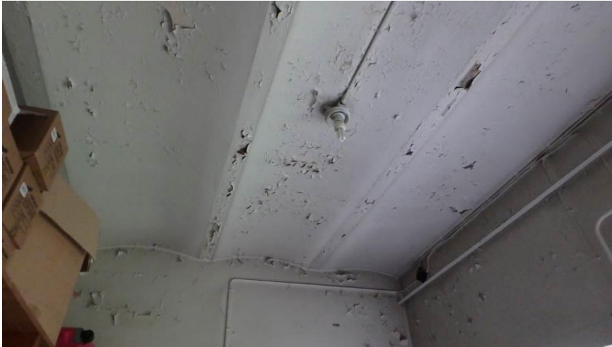
Kuva 31. Mehuaseman sisäkaton maali hilseilee.
