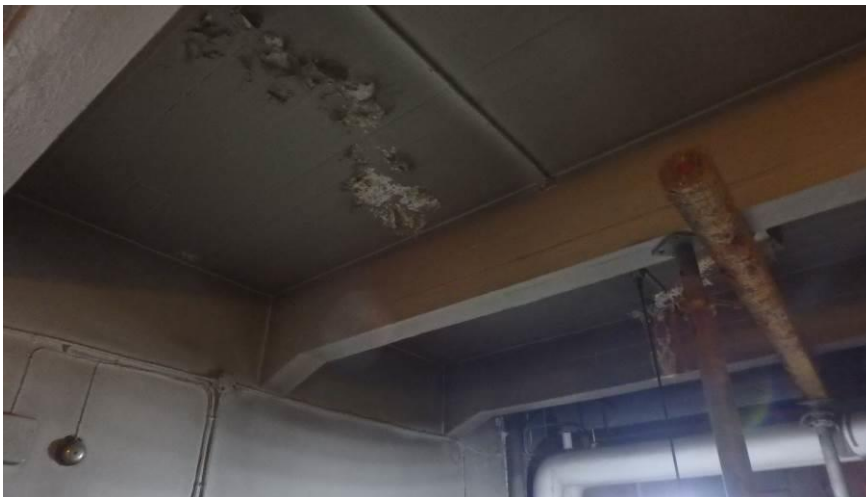
Kuva 32. Lämpökeskuksen kattopinnan maali hilseilee vesivuodon takia.
