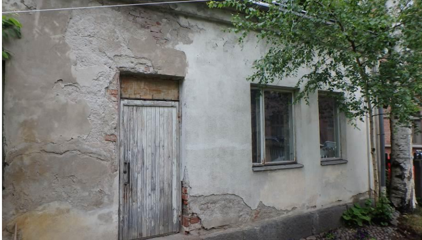
Kuva 13. Mehuaseman etelän puolen rappauspintojen vaurioita.
