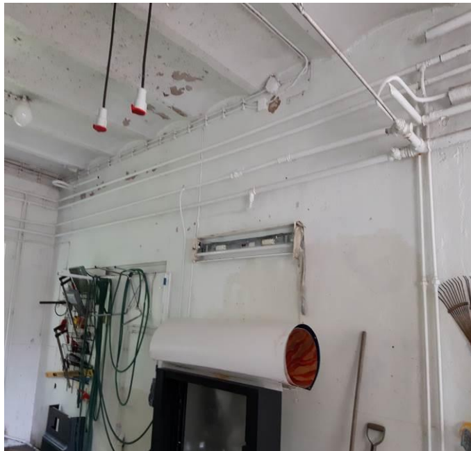
Kuva 35. Mehuasemaan vesi- ja lämpöjohdot.
