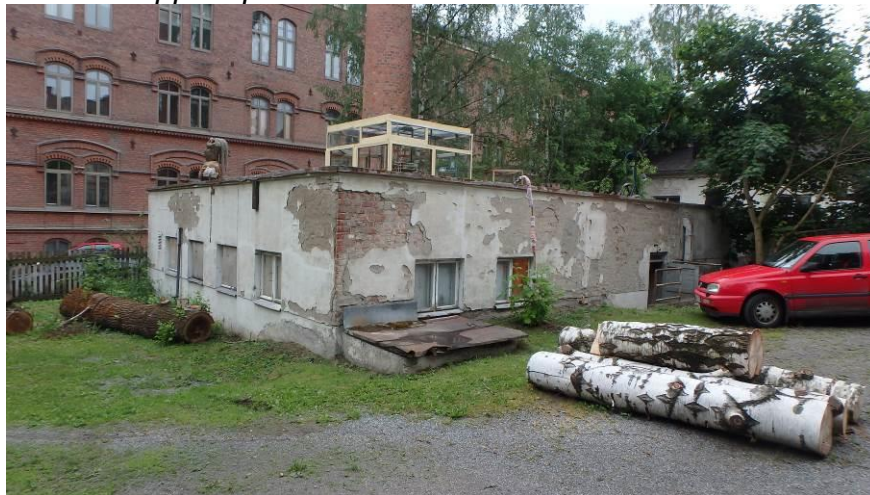
Kuva 11. Lämpökeskuksen rappaukset ovat pahoin rapautuneet.
