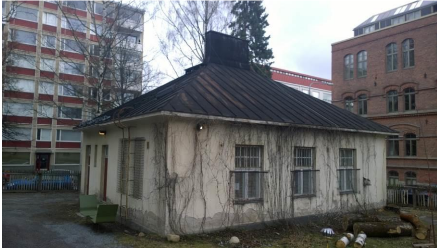
Kuva 10. Kärysaunan julkisivujen alaosassa on vaurioita rappauspinnassa.
