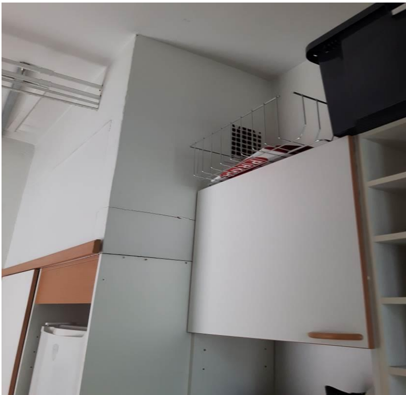
Kuva 42. Valurautainen poistoventtiili seinässä.
