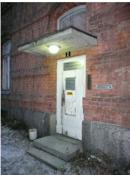
Eteläjulkisivun ulko-ovi, joka johtaa nykyiseen pääportaikkoon. Sisäänkäynti puhkaistiin julkisivuun 1950-luvulla. Samalla rakennettiin oven ylle betoninen katos.
