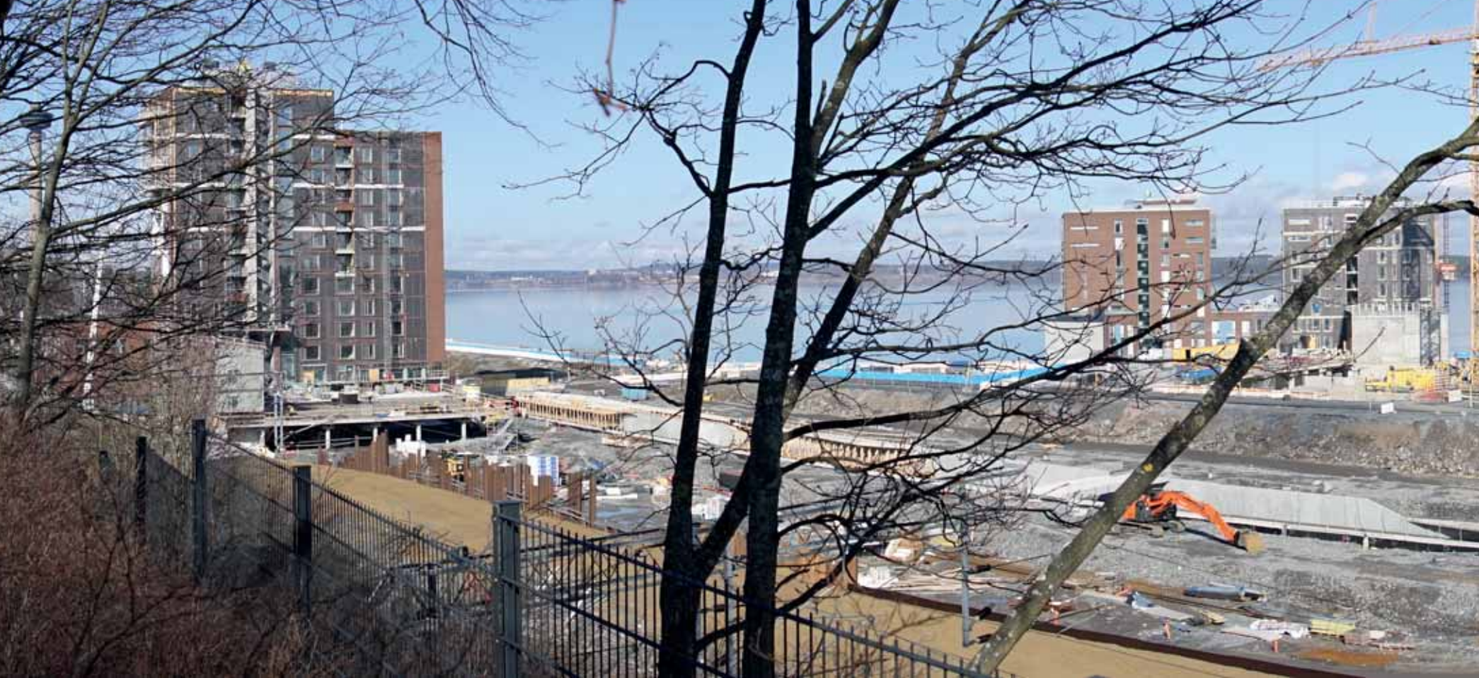
KUVA : Ranta-Tampellan asuntoalue rakenteilla. Ensimmäiset asukkaat muuttavat 2018. Osa Näsijärven rantakaupunkia ja Viiden tähden keskustaa. Valokuva Tampereen kaupunki, Viiden tähden keskusta / Tarja Kaasalainen, 2018.
