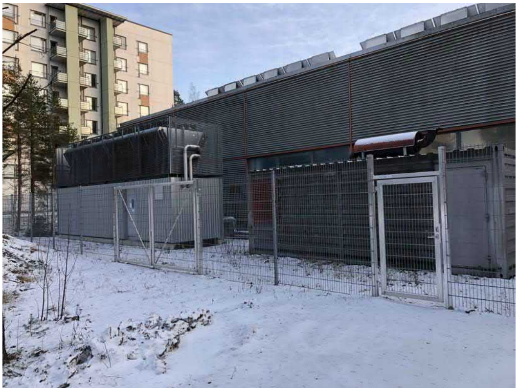
Kuva 29. Sähkötalon pohjoissivun jäähdytys- (vas.) ja varavoimakontti (oik.).
