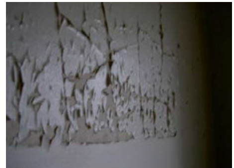
Kuva 104 yläpuolella Porrashuoneen seinän hilseilevää maalipintaa
