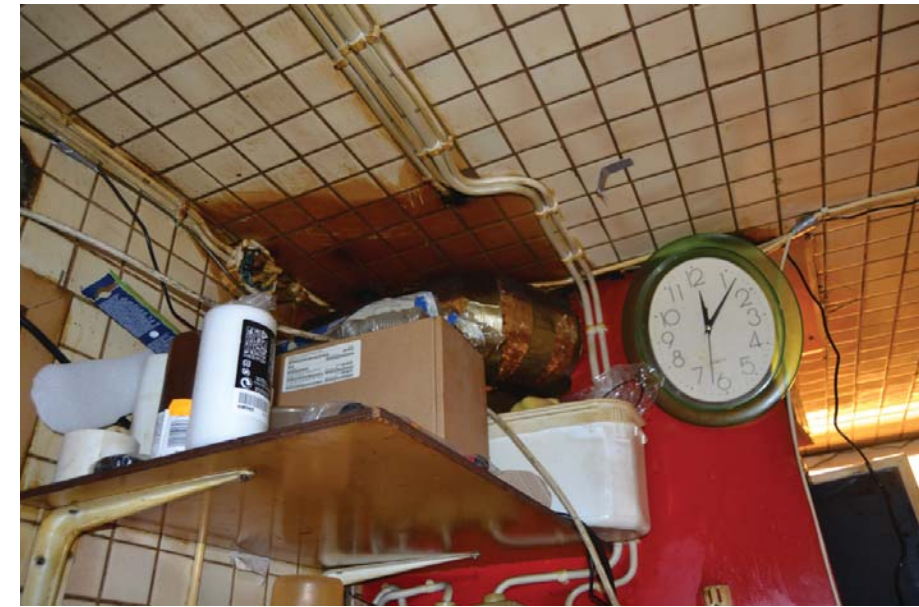
Kuva 43. Läpivienti keittiön ja wc:n välillä. Katossa ruskea värjäytymä. Kattolistoja ei ole.
