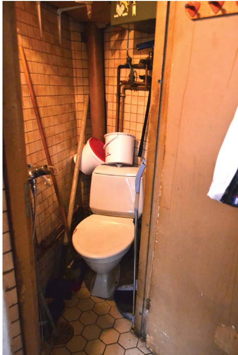
Kuva 63. Wc eteisestä kuvattuna. Ovi on puinen ja peittomaalattu. Eteisen lattialaatoitus jatkuu wc-tiloihin.
