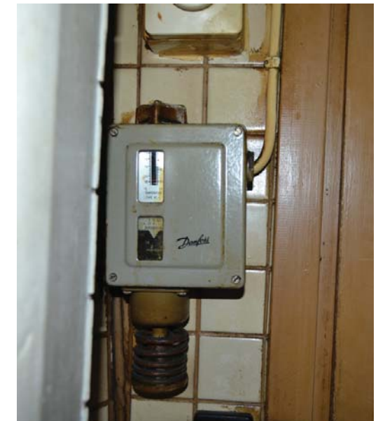
Kuva 47. Termostaatti ulko-oven ja wc:n oven välissä.
