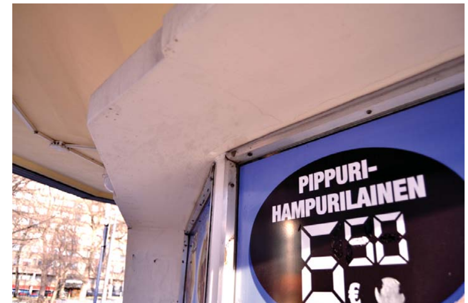
Kuva 35. Vanhan ikkunan ja myöhemmin puhkaistun ikkunan saumakohdassa näkyy lovia betonisessa yläreunassa. Ikkunankarmit ovat kevyitä metallikarmeja.
