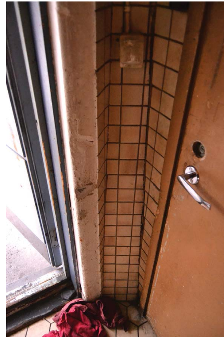
Kuva 41. Ulkoseinän kaltevuus näkyy ulko-oven aukon ja väliseinän laatoituksessa.
