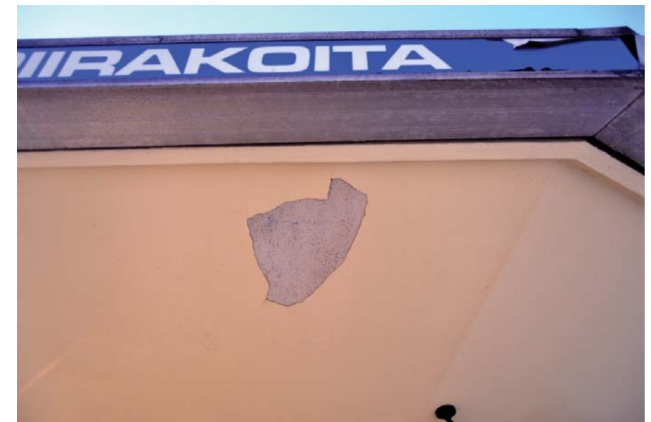
Kuva 27. Katoksen valomainos alapuolelta ja vaurioitunutta rappauspintaa.
