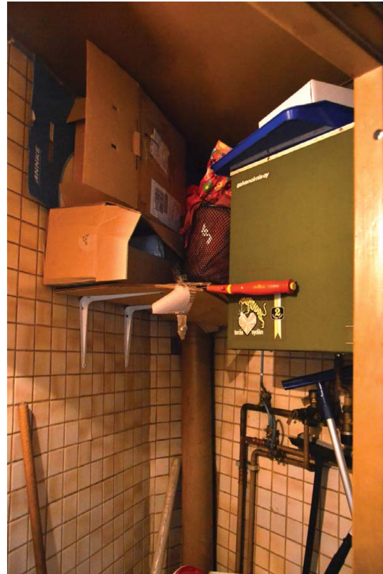
Kuva 64. Rakennuksen lämminvesivaraaja oikealla.
