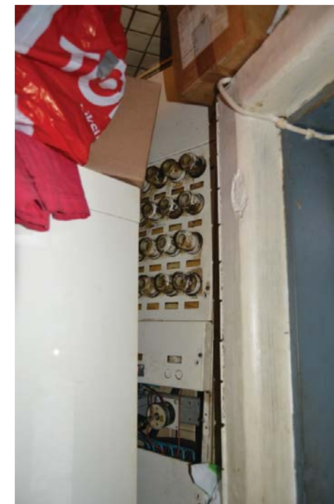
Kuva 37. Sähkökaappi ulko-oven vieressä.
