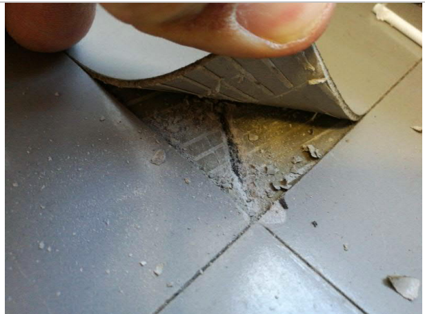
pistokoetarkastus B-portaikko, pikiliimaa lattian pinnoitteen ja tasoitteen alla
