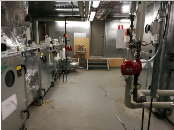
A-osa IV-konehuone yleiskuva, talotekniikka uusittu 2005-2006
