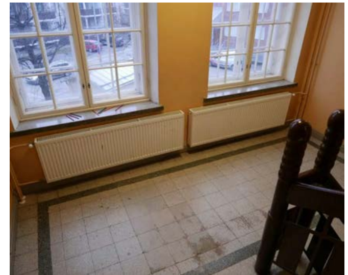
Lepotason (1-2 krs) kulunut laatoitus koillisivulla.
