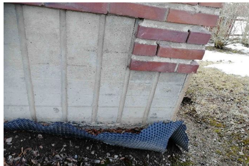
Patolevy liian pitkänä ohjaa vettä perusmuuria vasten ja kastelee rakenteita. Kuva Kuntoselvitys RKM Group Oy 2019.
