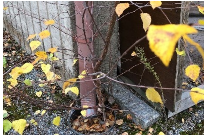
Vanhat sadevesijärjestelmät kaipaavat huoltoa. Kuva Tampereen kaupunki 2021.
