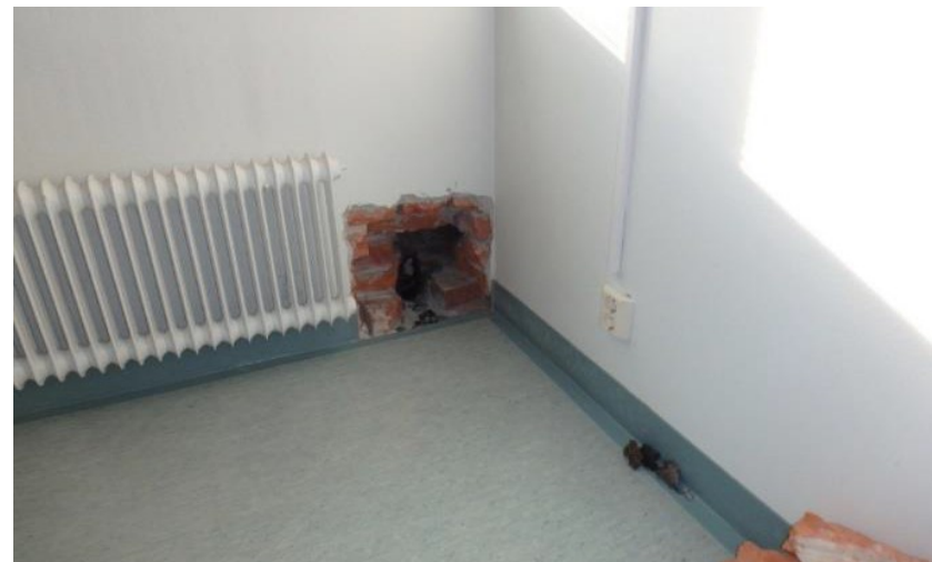
Kuntotutkimuksen tyypillinen rakenneavaus ulkoseinän alaosassa, jolla tutkittiin tuulettumattoman tiili-villa-tiili –rakenteen eristeen kuntoa.
