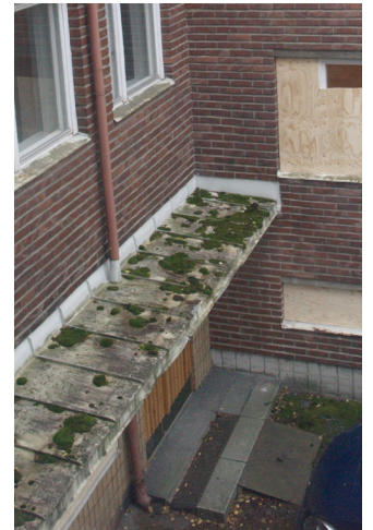
Katot jatkavat sammaloitumista etenkin puiden lähellä.
