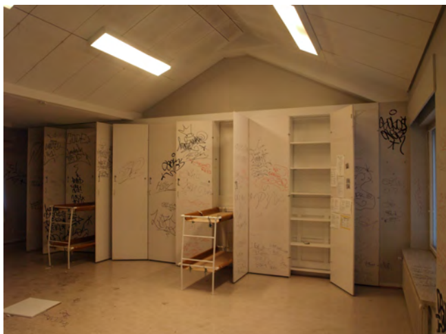
Seinäpinnoilla on sisäätunkeutujien tekemiä sotkuja, mutta myös edellisten virallisten käyttäjien jättämiä jälkiä.
