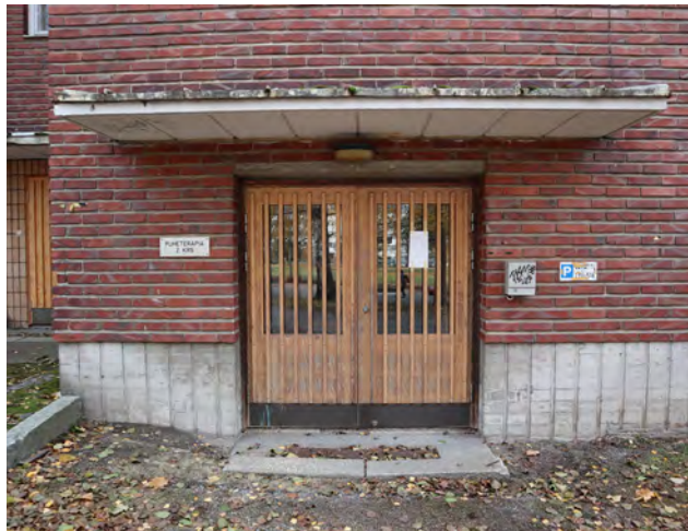
Läntisen Saukonpuiston puolen kahteen porrashuoneeseen vievät ovet Saukonpuiston puolella ovat keskenään samantyyppiset ja samantyyppisessä kunnossa. Kuvassa itäisempi ovipari. Oven katos on sammaloitunut.
