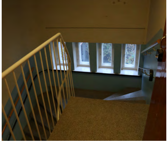
Ilmarinkadun puolen porrashuoneen ikkunat
