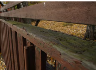
Tontin aidat ovat pääosin ehjiä maalipintaa lukuunottamatta.
