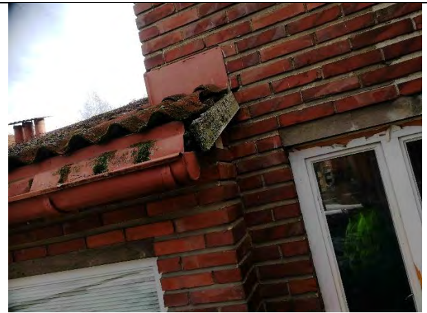
Kuitusementtilevy lohjennut. Puuosia lahonnut.
