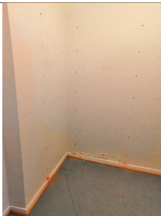
Kuva 4. tilasta 009. seinässä kosteuden aiheuttamaa vauriota.
