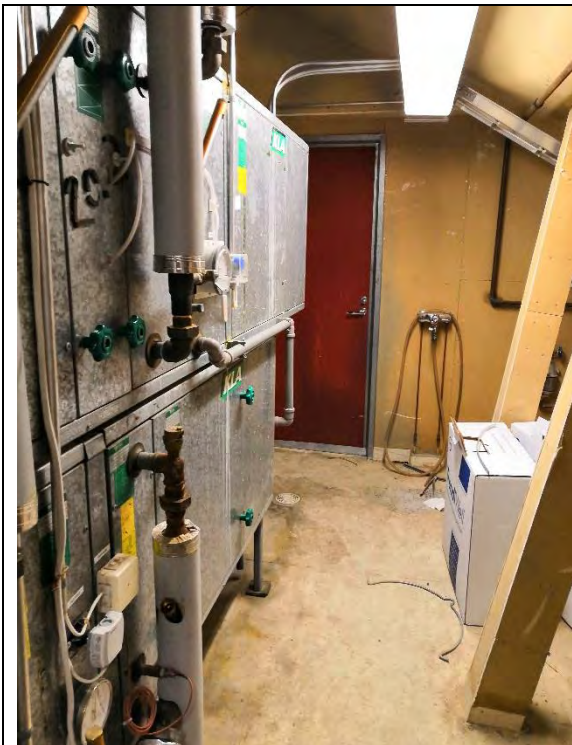
Kuva 29. IV-konehuoneen lattialla vesijälkiä ja poikkeavia pintakosteuslukemia.
