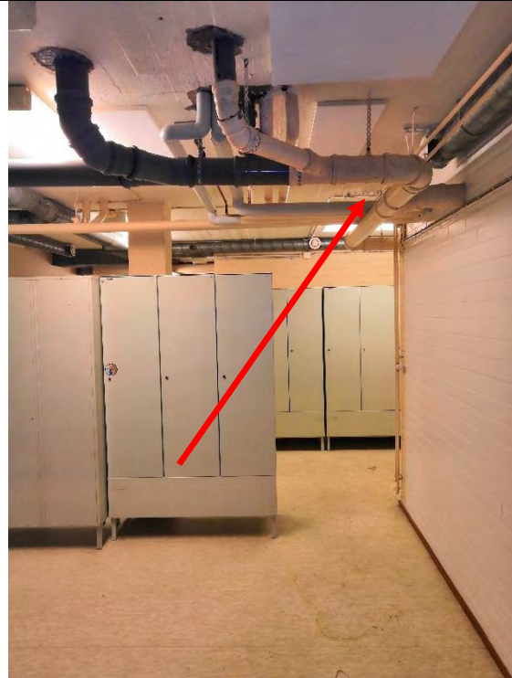
Kuva 22. tilasta 064, jossa havaittiin viemärivuoto.
