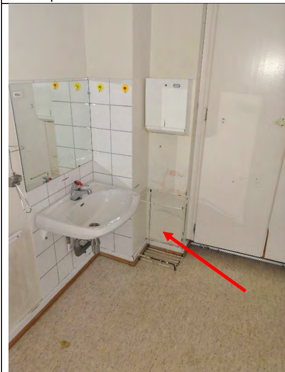
Kuva 15. tilasta 215, jossa seinän/ hormin alapään maali on hilseillyt.
