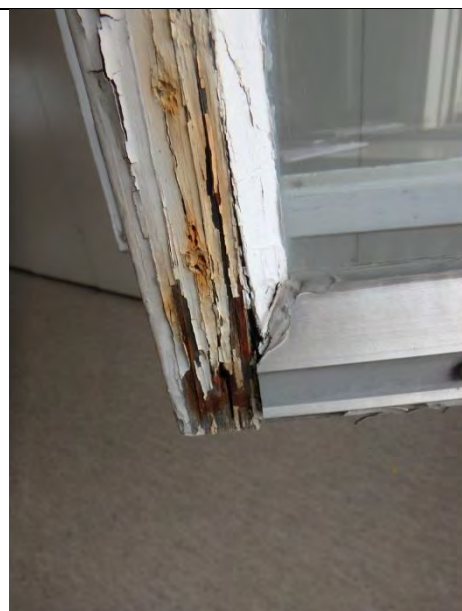
Eteläpuolen ikkunan vaurio.
