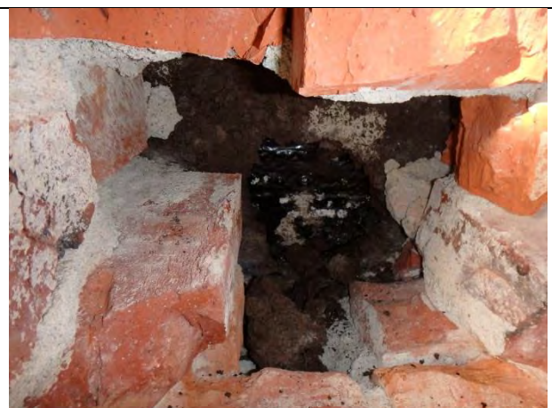
Ulkoseinän alaosassa on eristeenä n. 20 mm ekspan- doitu korkki. Korkin ja alimman tiilen alla on pikisively.
