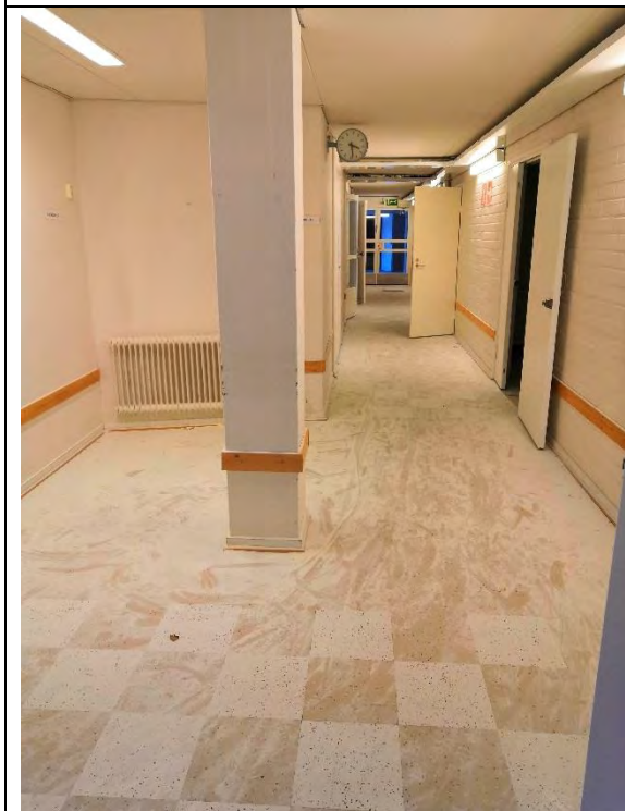
Kuva 7. tilasta 027 käytävä, jonka lattiasta mitattiin kohonneita pintakosteuslukemia. Tilaan tyhjenetty jauhesammutin.
