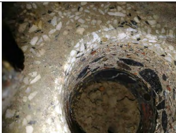
Sisäänkäyntiaulassa ei lämmöneristeenä toimivaa kaasubetonia alapohjassa.
