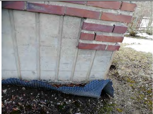
Patolevy nykyisellään lähinnä ohjaa vettä perusmuuria vasten.
