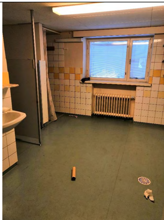
Kuva 2. tilasta 002. Lattian pintakosteudet koholla.
