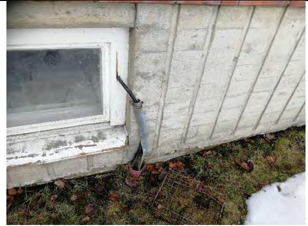
Kaapeloinnin suojaus on tarpeen uusida.
