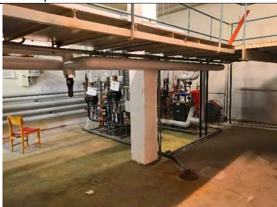
Kuva 31. tilasta 073, jossa havaittiin kohonneita pintakosteuslukemia lattiassa ja seinissä.
