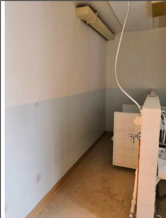
Kuva 25. tilasta 135, lattialla, seinässä ja katossa vesijälkiä ja pintakosteudet koholla.
