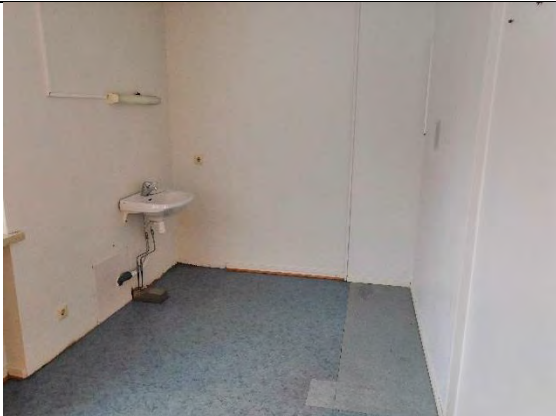
Kuva 23. tilasta 140, jossa matto on irti alustasta ja lattian pintakosteuslukemat koholla.
