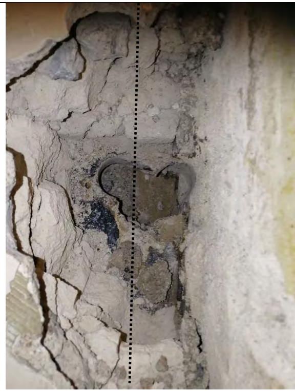
Tiiliseinän alla betonianturan havaittiin olevan hyvin ka- pea. Kuvan reiät on tehty 40mm poralla. Oikealla tiiliseinä. Katkoviivalla esitetty anturan raja.
