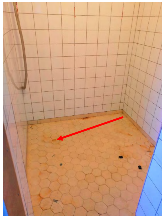
Kuva 6. tilasta 023 kylmiö, jonka lattiasta mitattiin kohonneita pintakosteuslukemia. Lattiasa mahdollisesti yllälaatoitettu lattiakaivo.
