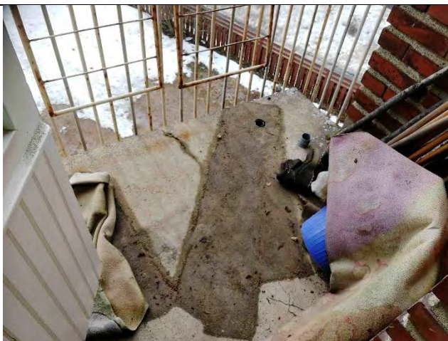
Pintalaatat ovat halkeilleet.
