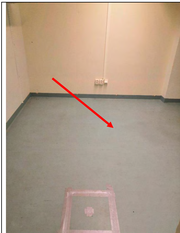
Kuva 9. tilasta 035, jonka lattiasta mitattiin kohonneita pintakosteuslukemia. Lattialaatta halki ja halkeaman kohdalla mahdollisesti viemäröinti.
