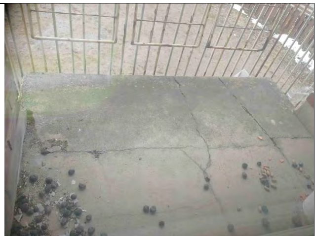
Pintalaatat ovat halkeilleet.
