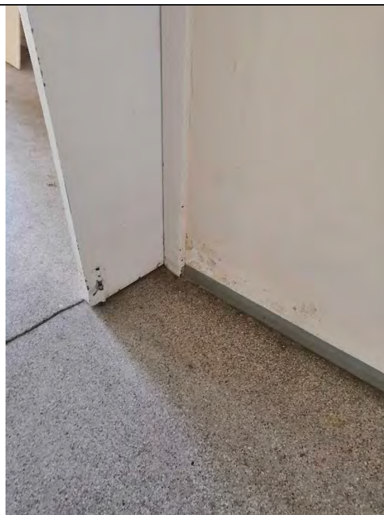
Kuva tilasta 044, jonka seinässä kosteuden aiheuttamaa vauriota.
