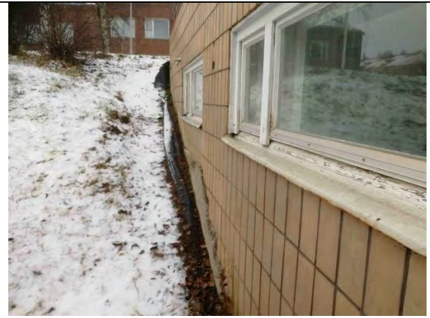
Patolevy on asennettu ilman reunalistia.
