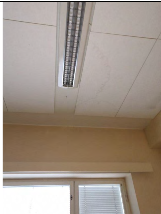
Kuva 14. tilasta 209, jonka katossa havaittiin vuotojälkiä ja poikkeavia pintakosteuslukemia.
