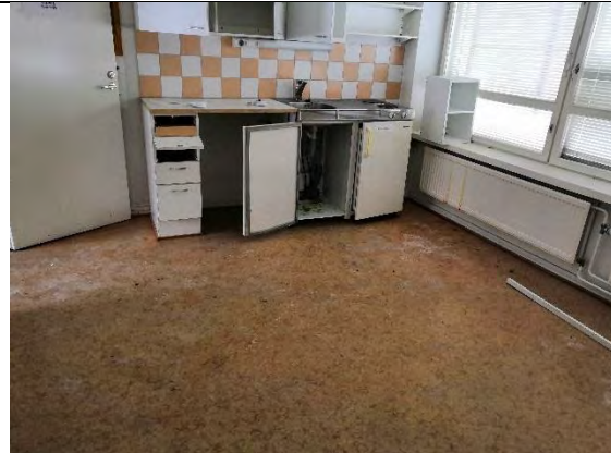
Kuva 24. tilasta 133, jonka lattiassa vesijälkiä ja poikkeamia pintakosteuslukemissa.
