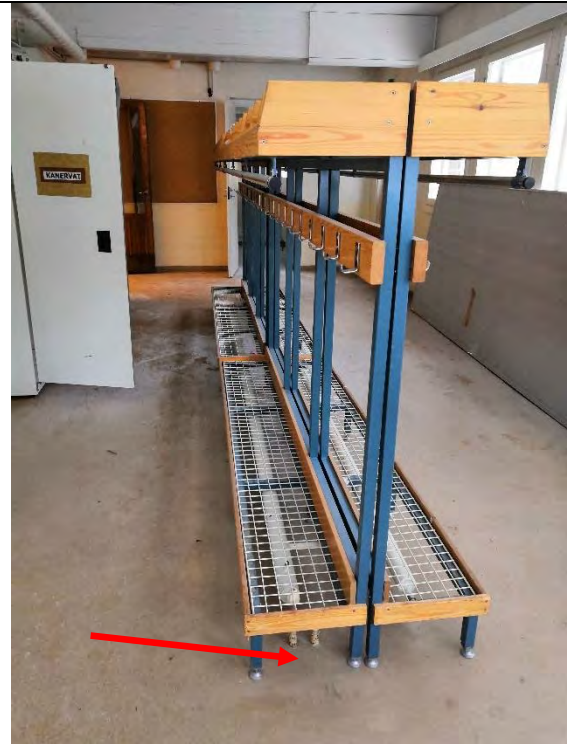
Kuva 26. tilasta 151 patterin lattian läpimenon vierellä poikkeama pintakosteuslukemissa.
