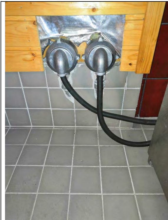
Kuva 17. tilasta 061. Saunan läpivienti epäonnistunut → eristeet näkyvät.
