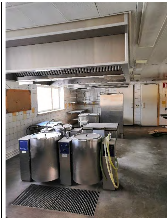
Kuva 5. tilasta 018, jonka lattiasta mitattiin kohonneita pintakosteuslukemia.
