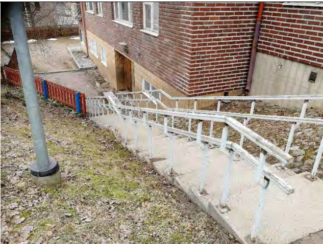
Pihaportaissa on huoltomaalaustarve puu- ja metalliosille.
