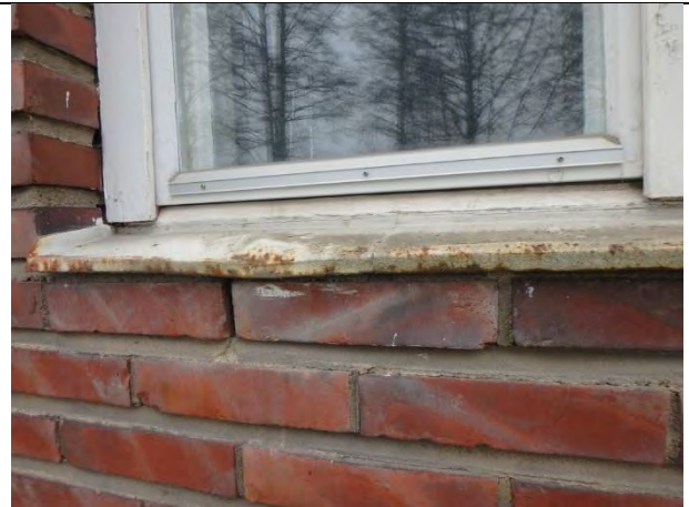
Ikkunapelleissä on paikoitellen vaurioita.
