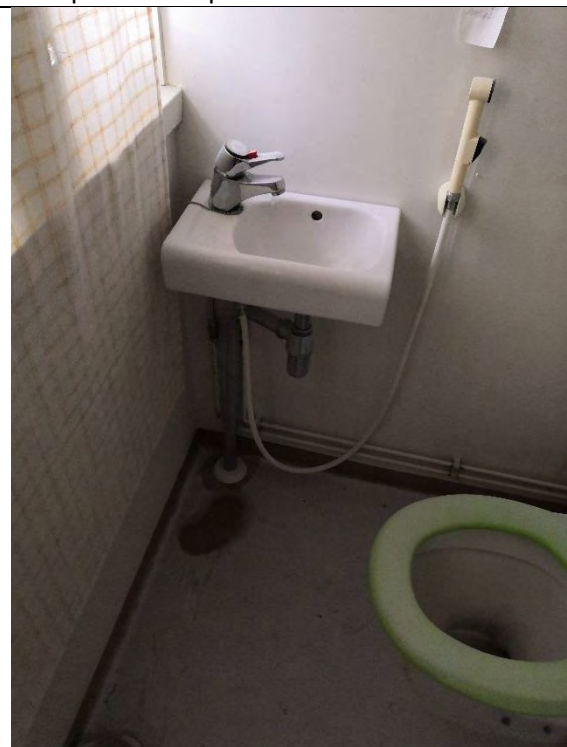
Kuva 28. tilasta 152, jossa havaittiin, että hana vuotaa.
