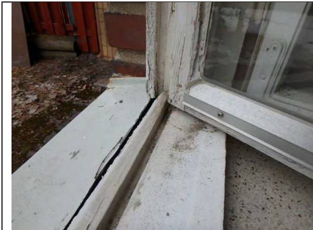
Paikoitellen ikkunapelttien liitos ei ole tiivis.
