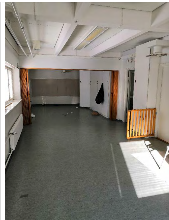
Kuva 1 tiloista 001 ja 006. Lattian pintakosteudet koholla.
