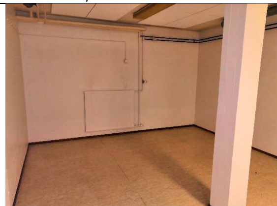
Kuva 20. tilasta 064 jonka lattiasta mitattiin kohonneita pintakosteuslukemia.
