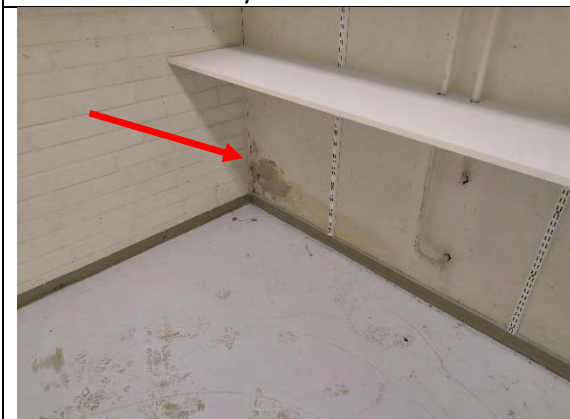
Kuva 19. tilasta 062, jonka nurkassa kosteuden aiheuttamaa vauriota.
