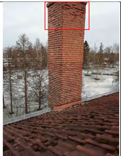
Piipusta irtoavat tiilipinnat voivat vaurioittaa katetta.
