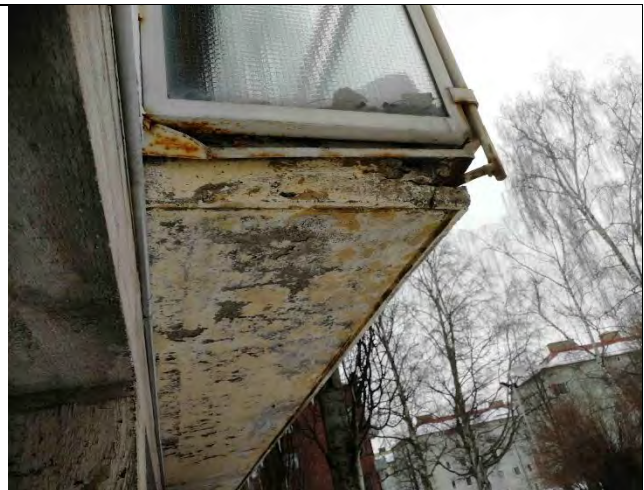
Pohjabetonin maali on hilseillyt ja nurkissa on ra- paumaa.
