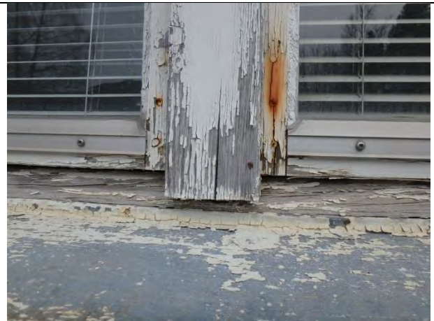
Smyggilautojen maali on voimakkaasti hilseillyt eteläpuolella. Alapuitteita on korjattu alumiinipuitteilla.
