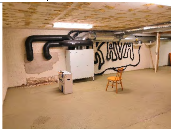
Kuva 32. tilasta 077, jonka seinästä ja lattiasta mitattiin kohonneita pintakosteuslukemia ja pinnoilla havaittiin vauriojälkiä.
