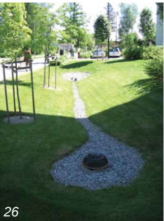
25. Pienvesi rakennetussa kanavassa.
