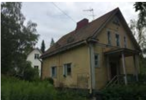
Peruskorjausta vaativassa kunnossa oleva talo vuodelta 1925, Sudenkatu 37.
