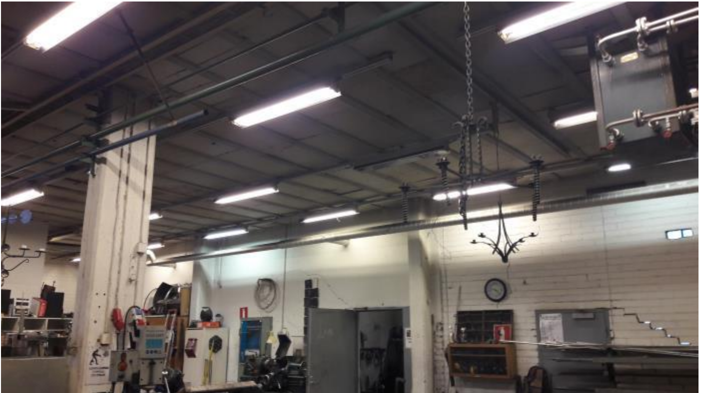
Kuva 1. Työväenopiston paja. Tiloissa havaittiin yksi noin 200*150mm asbestihormi. Seinän maalista ja rappauksesta otettiin näyte asbestianalyyssiä varten. Näyte ei sisältänyt asbestia.
