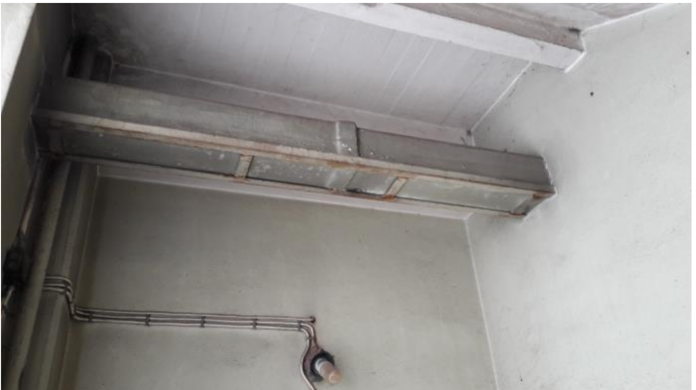
Kuva 2. Asbestihormi jatkuu porraskäytävällä.
