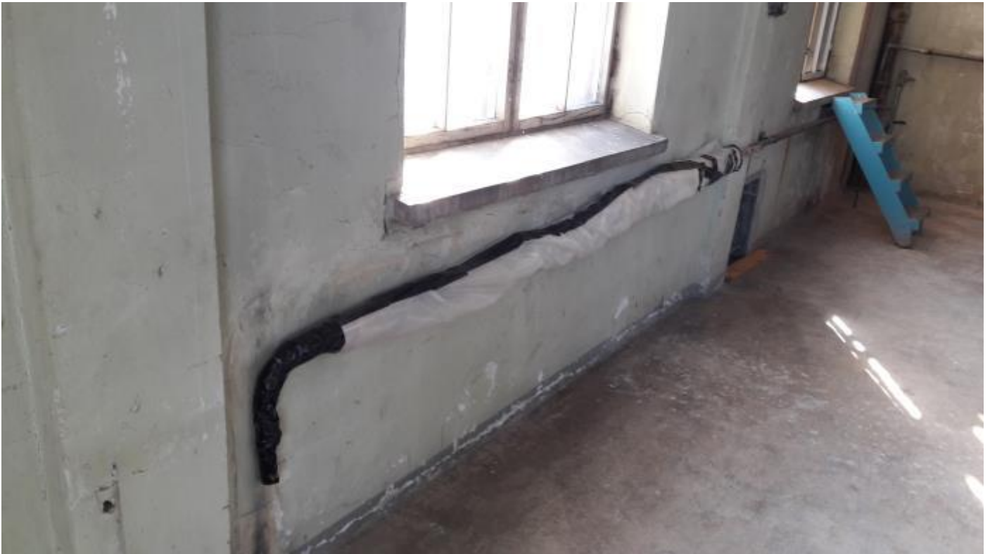
Kuva 3. 4. kerroksen säiliöhuoneessa havaittiin n. 2,5 m putkieristettä.
