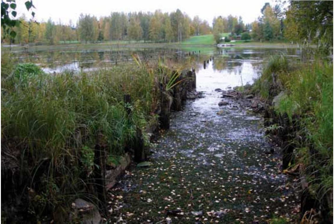
Kuva 5. Vehkakosken sahan laituri- ja satamarakenteita Myllylahden rannassa. Kuva: Kalle Luoto/FCG Finnish Consulting Group.
